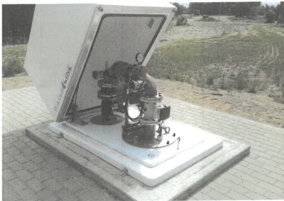
Przykładowa naziemna termoizolacyjna obudowa studni głębinowej
