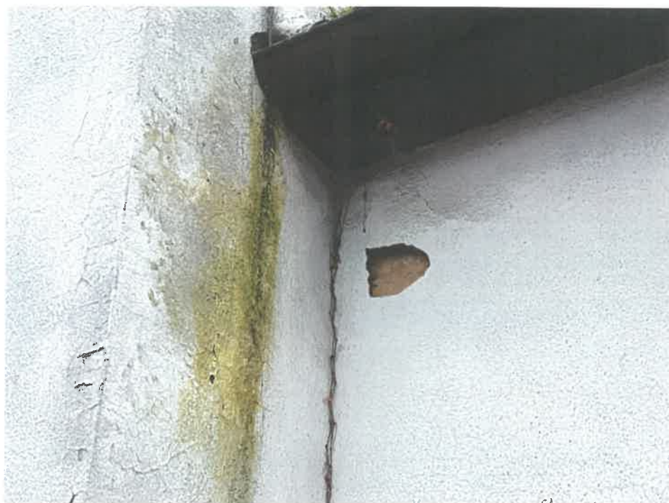
Fot. 56 – Korozja biologiczna tynku elewacyjnego. Po prawej widoczne odspojenie tynku od muru.
