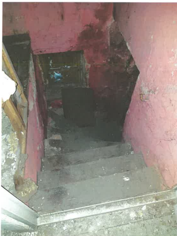
Fot. 71 – Silne zawilgocenia muru przy schodach zejściowych do piwnicy.
