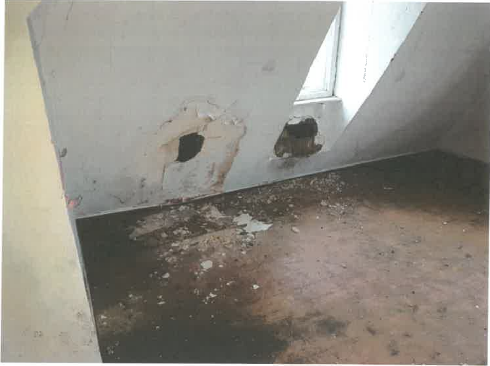
Fot. 16 – Zniszczenia mechaniczne i zawilgocenia podbitki na poddaszu. Widoczne ślady zawilgoceń podłogi.
