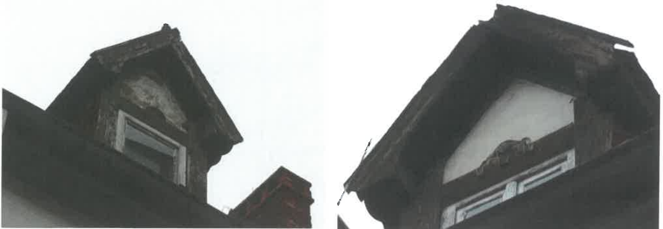
Fot. 30, 31 – Zły stan lukarn dachowych.
