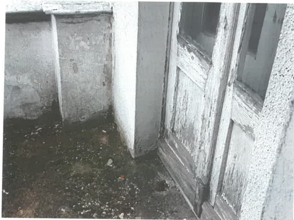
Fot. 100 – Przykład zużycia technicznego drewnianych drzwi balkonowych.
