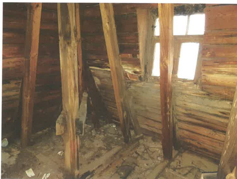
Fot. 8 – Porażona biologicznie, silnie zawilgocona konstrukcja drewniana dachu wieży. W pasie podokiennym widoczne silne zawilgocenia i butwienie deskowania dachu.
