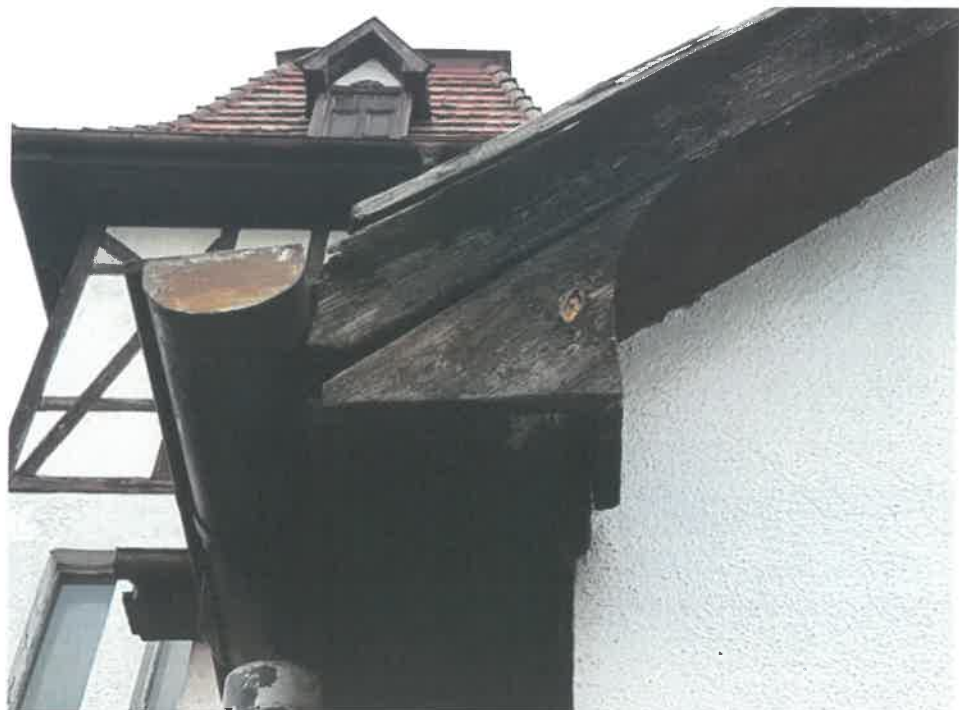
Fot. 29 – Zły stan drewnianych wiatrownic.
