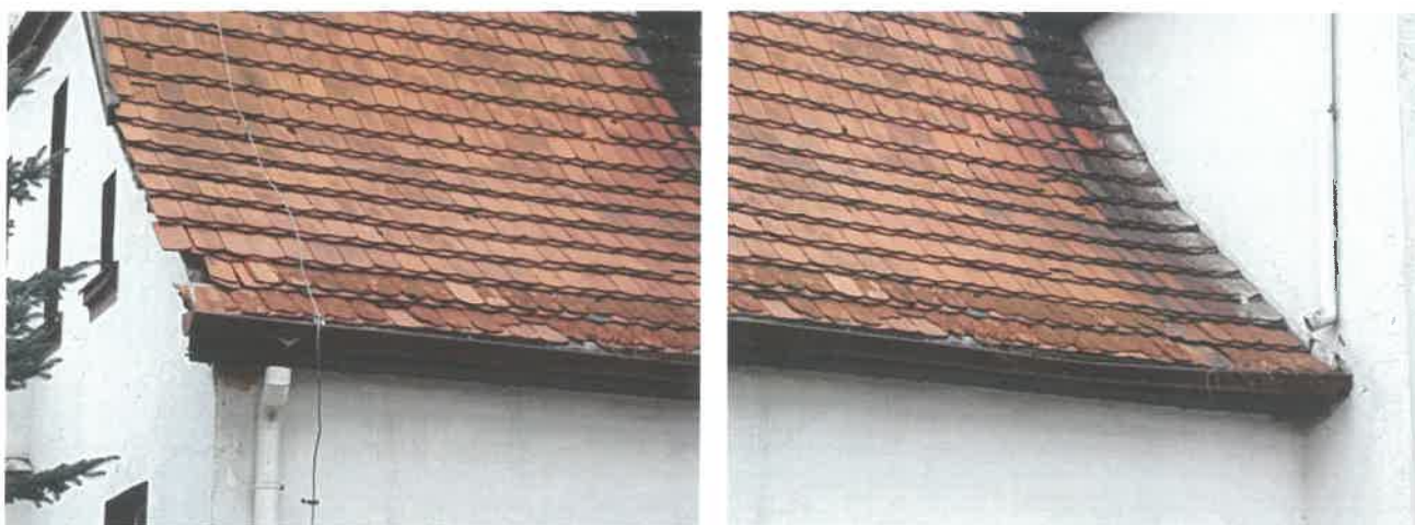
Fot. 20, 21 – Ubytki i zniszczenia dachówki na połaci południowej budynku. Widoczny brak wiatrownicy oraz porost roślinności w rynnie dachowej.
