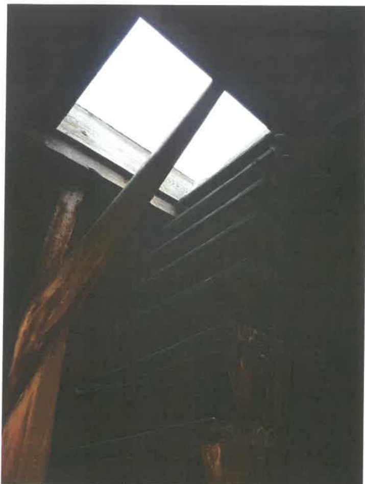
Fot. 7 – Niezabezpieczony otwór wyłazowy w dachu wieży, przez który do środka wnikają wody opadowe. Widoczna korozja biologiczna (butwienie) drewna schodów wyłazowych,
