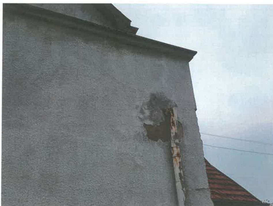
Fot. 37 – Skorodowana rura spustowa. Widoczny zaciek przy przejściu rury przez ścianę świadczący o istniejącej nieszczelności.
