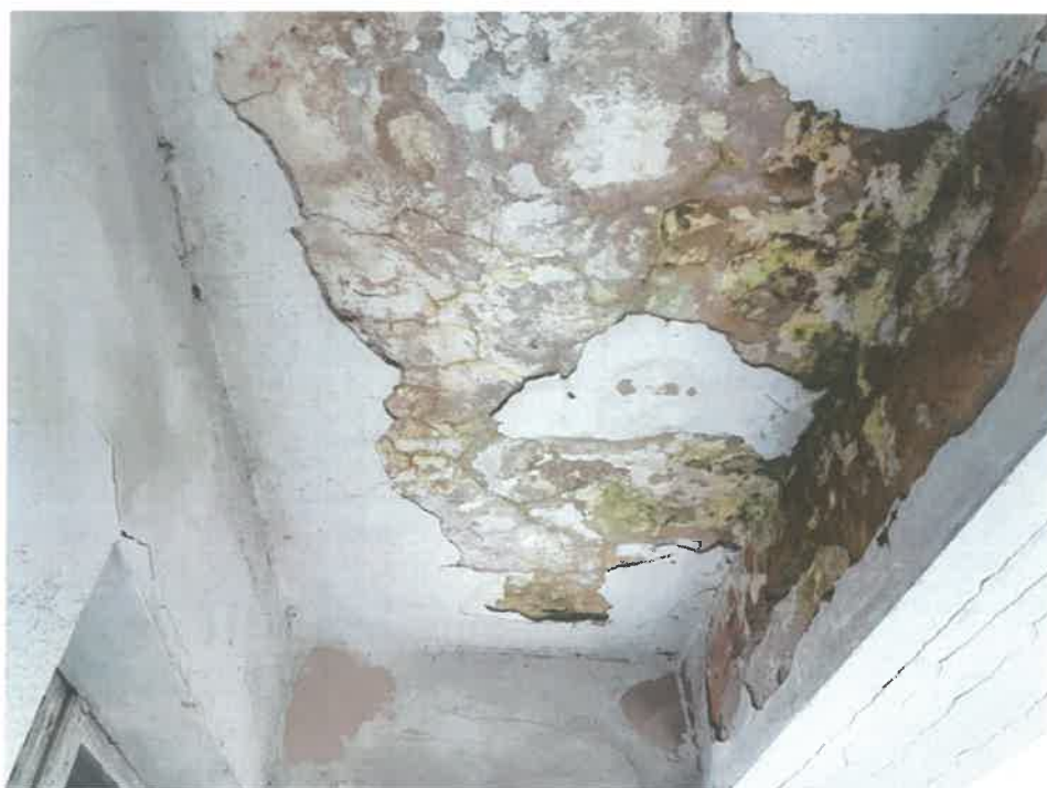
Fot. 77 – Przykład destrukcji płyty stropowej balkonu (elewacja boczna) nad loggią w poziomie 1 piętra.
