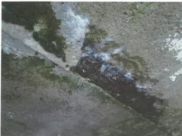
Fot. 79, 80, 81 – Totalna dewastacja stropu nad garażem. Silna korozja belek stalowych, widoczne nacieki i wykwity węglanu wapnia oraz ogniska pleśni i glonów.
