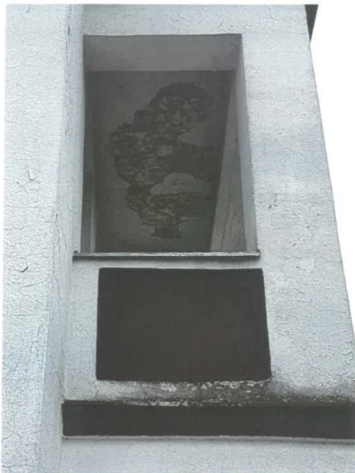
Fot. 73 – Ubytki tynku i silne zawilgocenia zadaszenia loggi na elewacji bocznej (stronie północno-wschodniej).
