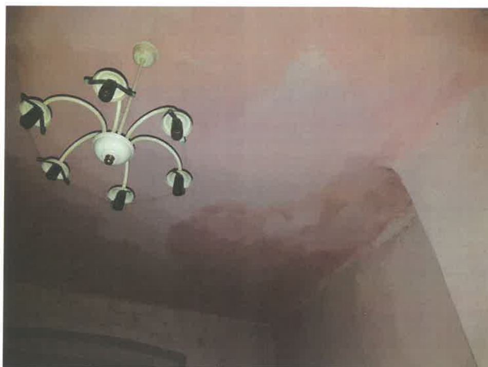
Fot. 85 – Silnie zawilgocony strop nad parterem.
