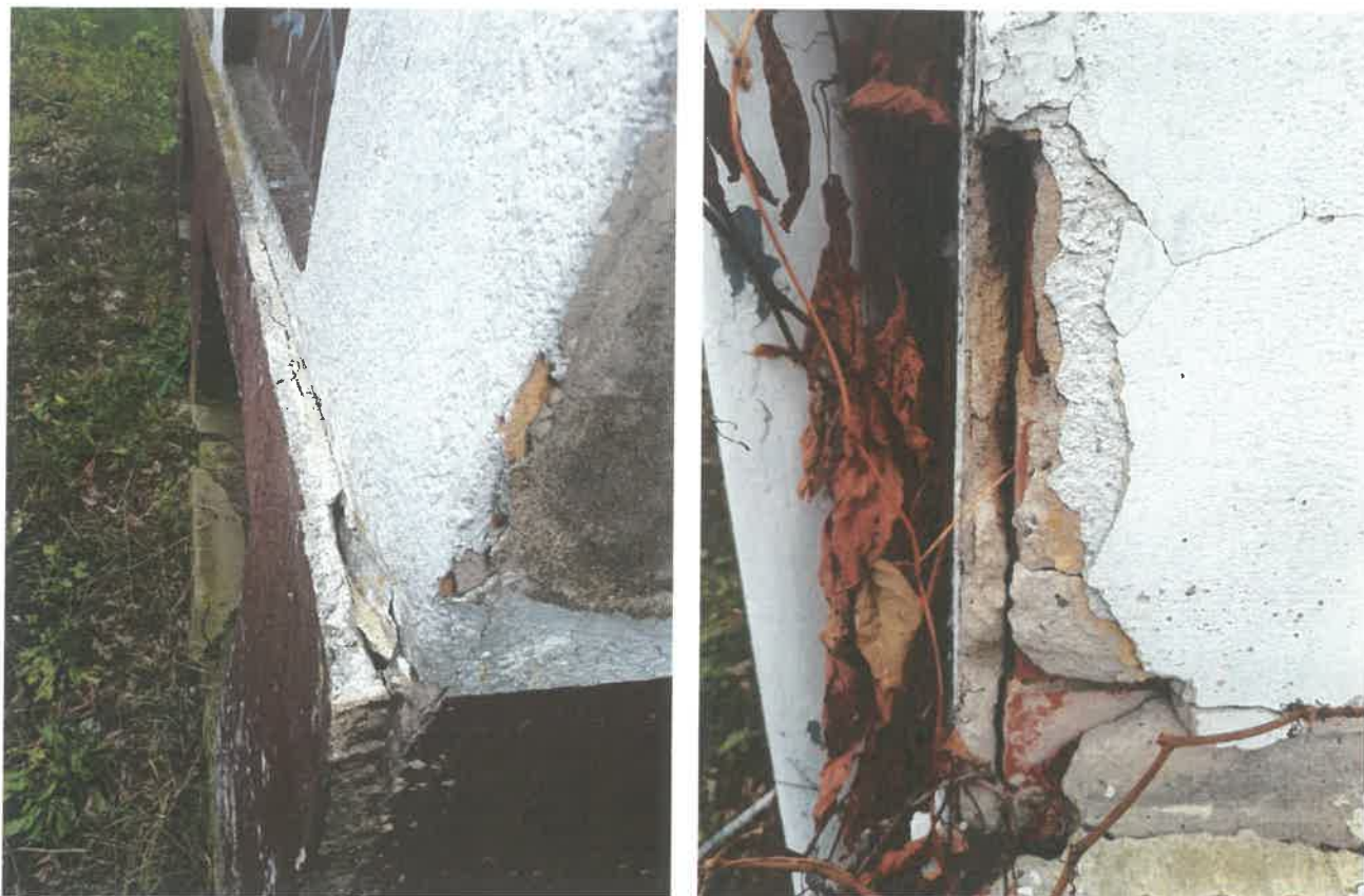
Fot. 54, 55 – Kolejny przykład destrukcji tynków. Na zdjęciu po prawej widoczne całkowite odspojenie tynku od muru.
