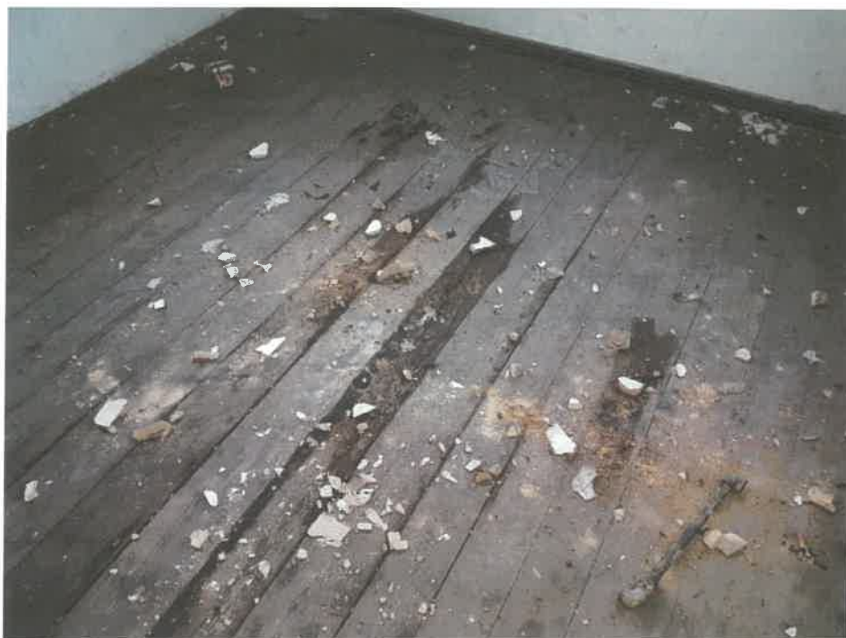
Fot. 13 – Zawilgocenia podłogi drewnianej poddasza użytkowego pod wieżą.
