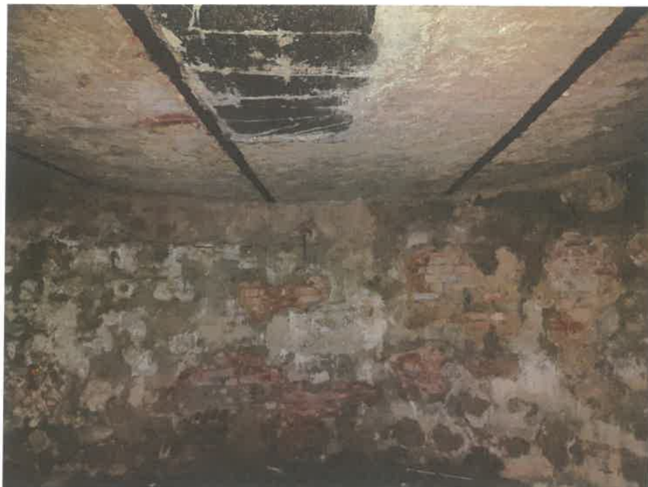
Fot. 70 – Stan murów pomieszczenia pod tarasem (schronu) w tylnej części budynku. Ściany silnie zawilgocone, tynki zdestruowane.
