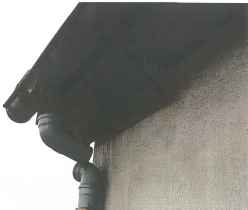
Fot. 36 – Poluzowana podbitka dachowa oraz brak właściwego połączenia kolan rury spustowej.
