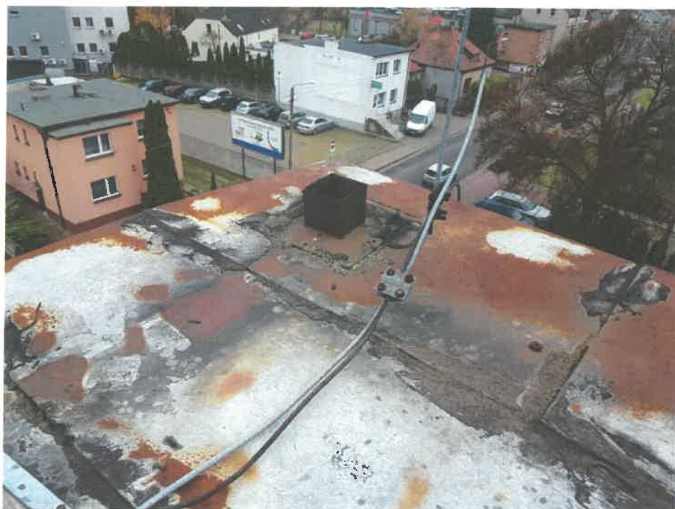
Fot. 35 – Korozja obróbek blacharskich na dachu wieży.
