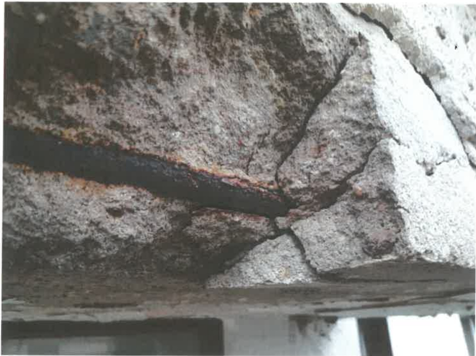
Fot. 61 – Ubytki otuliny betonowej oraz korozja pręta zbrojenia oczepu stanowiącego podparcie balkonu na elewacji tylnej, widocznego na fot. 58.
