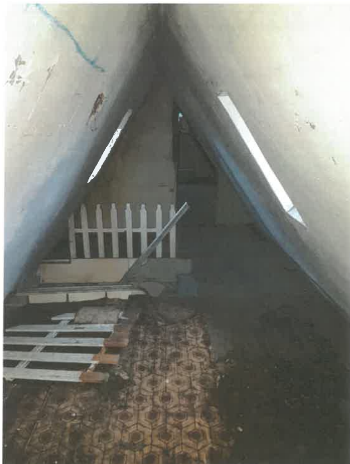
Fot. 14 – Poddasze nieużytkowe – widoczne silne zawilgocenia na podłodze na skutek nieszczelności pokrycia dachowego.
