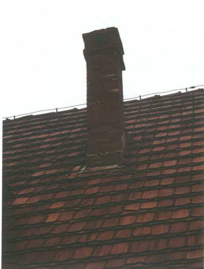
Fot. 38 – Niezadowalający stan komina murowanego ponad połacią dachową. Widoczne wypłukania spoin oraz korozja powierzchniowa cegły.
