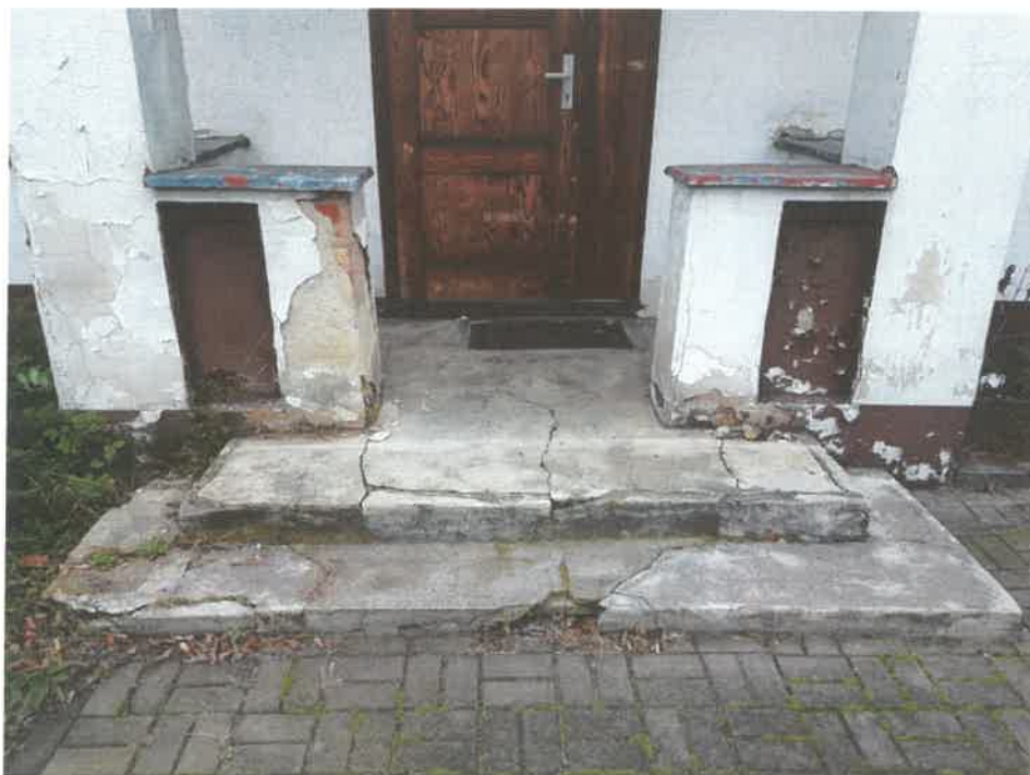
Fot. 88 – Zniszczone główne schody wejściowe do budynku.
