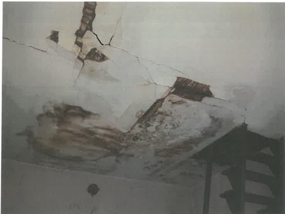
Fot. 12 – Zniszczony sufit na poddaszu użytkowym pod wieżą.
