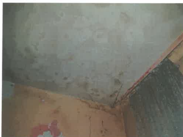
Fot. 82, 83, 84 – Przykłady silnych zawilgoceń stropów poddasza.
