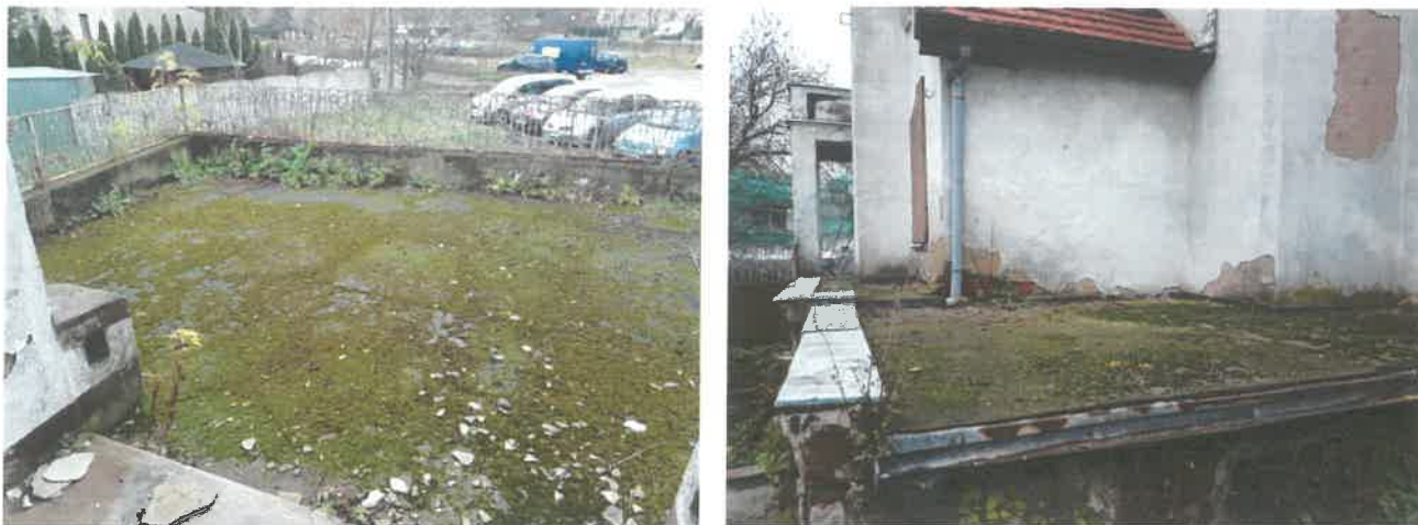
Fot. 75, 76 – Korozja biologiczna betonu na tarasach zlokalizowanych przy elewacji tylnej budynku, stanowiących równocześnie stropodach schronu oraz garażu.
