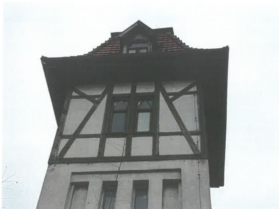
Fot. 18 – Wieża wykonana w technologii muru pruskiego. Drewno nosi ślady korozji technicznej, nie posiada w zasadzie żadnego zabezpieczenia. Powłoki ochronne uległy złuszczeniu. Drewno jest zwietrzałe.
