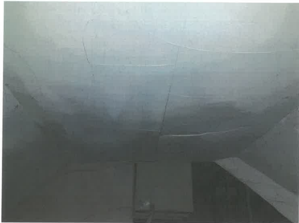
Fot. 17 – Sufit poddasza użytkowego – widoczne spękania i wyraźne ugięcie sufitu.
