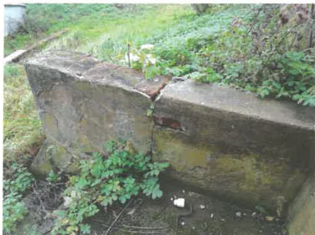
Fot. 90, 91, 92 – Zdewastowane schody i obudowa zejścia prowadzące z tarasu do kotłowni i garażu.
