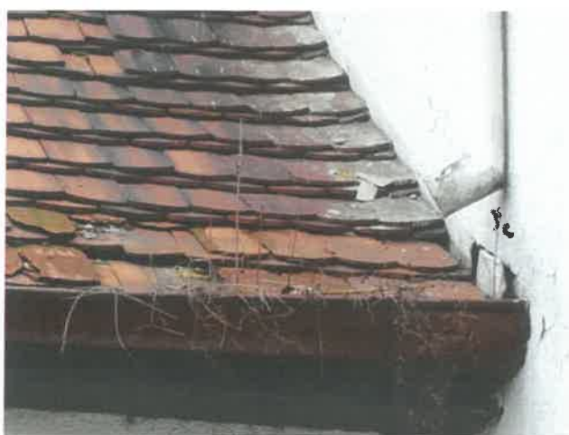
Fot. 22, 23, 24 – Szczegóły nieprawidłowości na połaci dachowej widocznej na fot. 20, 21.
