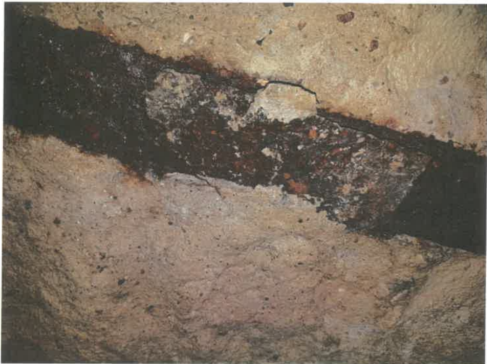
Fot. 87 – Odspojenie fragmentu nośnej belki stalowej stropu na skutek silnej korozji.
