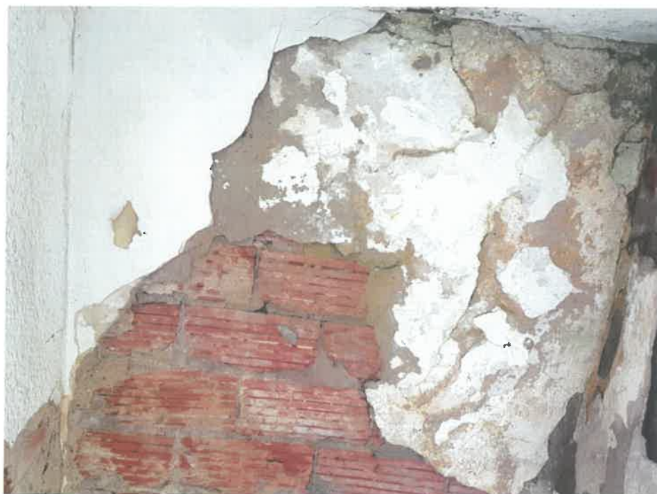
Fot. 72 – Ubytki tynku na stropie balkonu stanowiącego zadaszenie wejścia głównego do budynku. Dobry stan pustaków ceramicznych stropu typu Foerster.
