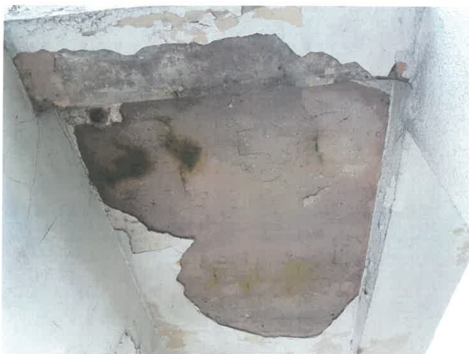
Fot. 74 – Ubytki tynku oraz widoczne ogniska korozji biologicznej stropu balkonu na elewacji tylnej (nad wyjściem na taras).
