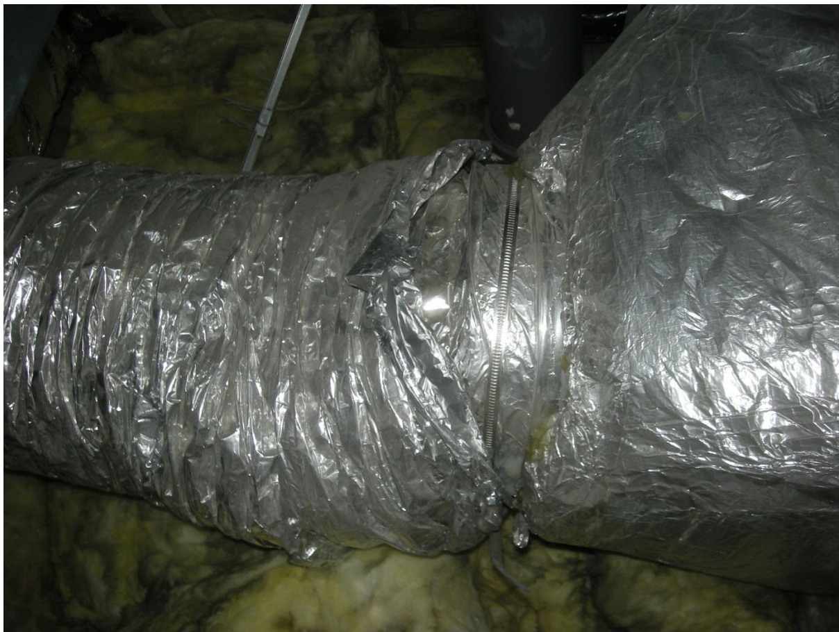
Zdjęcie nr 3. Nieprawidłowy przewód flex zamiast spiro do wymiany. Należy zamontować kolano z przewodem spiro fi 250mm i zaizolować wełną mineralną.
