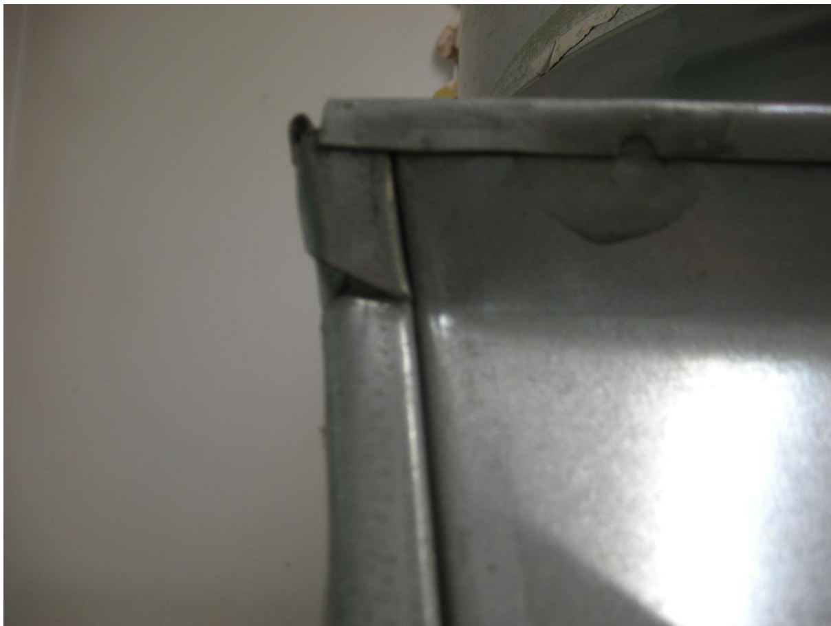
Zdjęcie nr 8. Przykład kanału wentylacyjnego do wykonania doszczelnienia taśmą wentylacyjną w maszynowni. Do doszczelnienia wszystkie połączenia.
