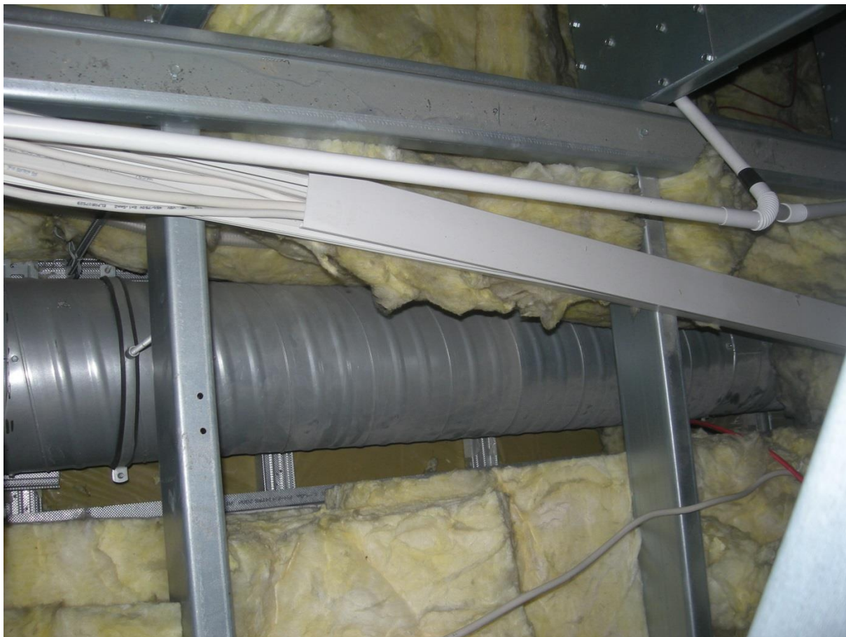
Zdjęcie nr 5. Przykład miejsc do uszczelnienia połączeń na rurach spiro (poddasze). Doszczelnić należy wszystkie połączenia.
