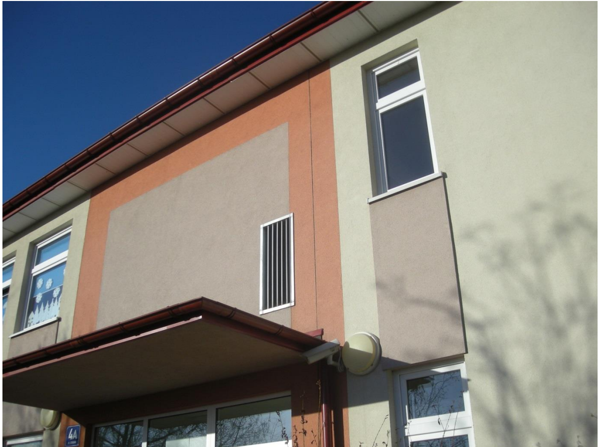
Zdjęcie nr 1. Nieprawidłowa czerpnia na elewacji do wymiany. Należy zamontować czerpnię wymiarach 400x1000mm z poziomymi lamelami.
