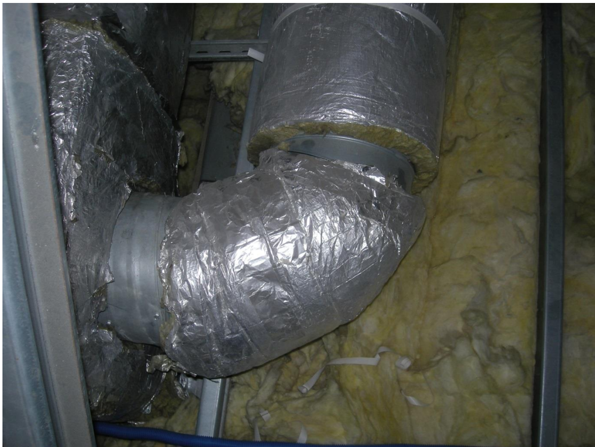
Zdjęcie nr 6. Przykład miejsc do uszczelnienia połączeń na rurach spiro (poddasze). Doszczelnić wszystkie połączenia.
