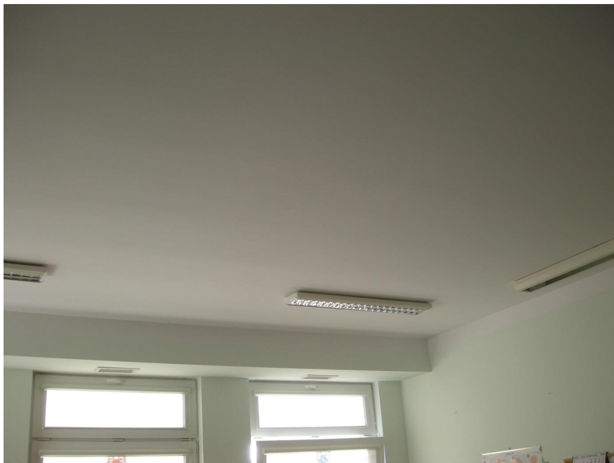
Zdjęcie nr 2. Jedna z kratek nawiewnych z niesprawną przepustnicą do wymiany (300x150 mm).
