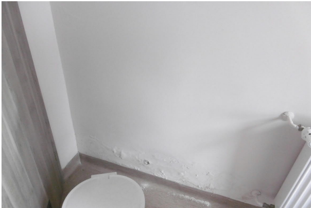
Fot. 13 – Widok zawilgocenia ścian w pomieszczeniu holu
