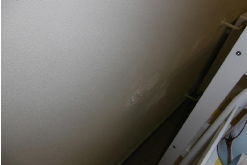
Fot. 11 – Widok zawilgocenia ścian w pomieszczeniu zabiegowym
