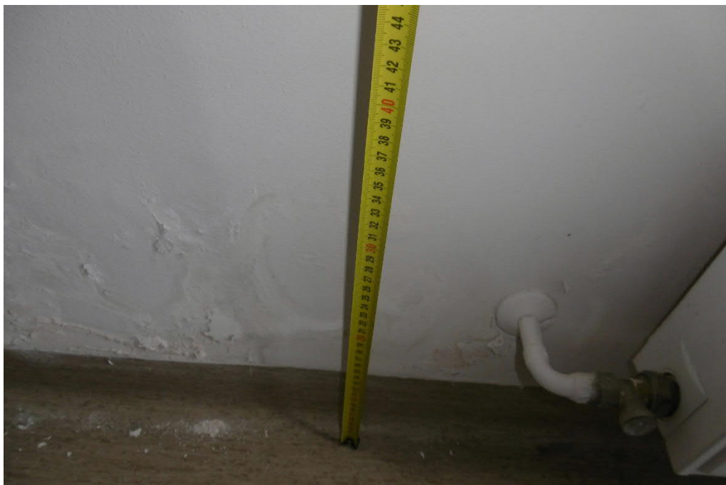
Fot. 14 – Widok zawilgocenia ścian w pomieszczeniu holu
