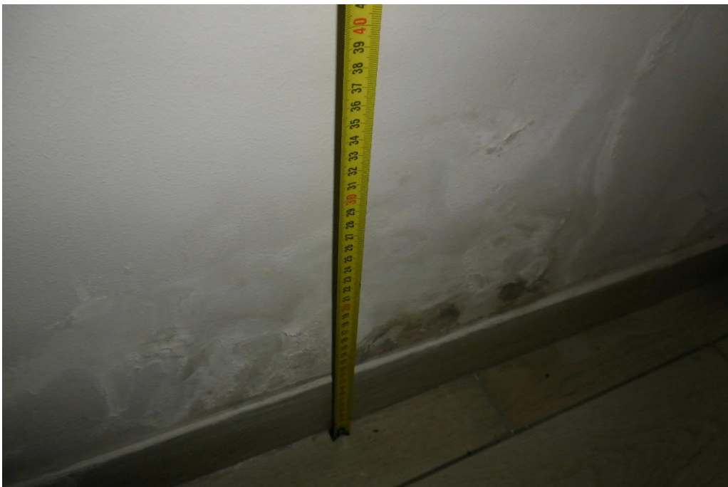
Fot. 12 – Widok zawilgocenia ścian w pomieszczeniu holu
