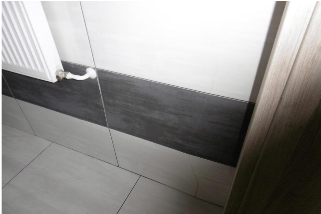
Fot. 15 – Widok pękniętych płytek w pomieszczeniu łazienki
