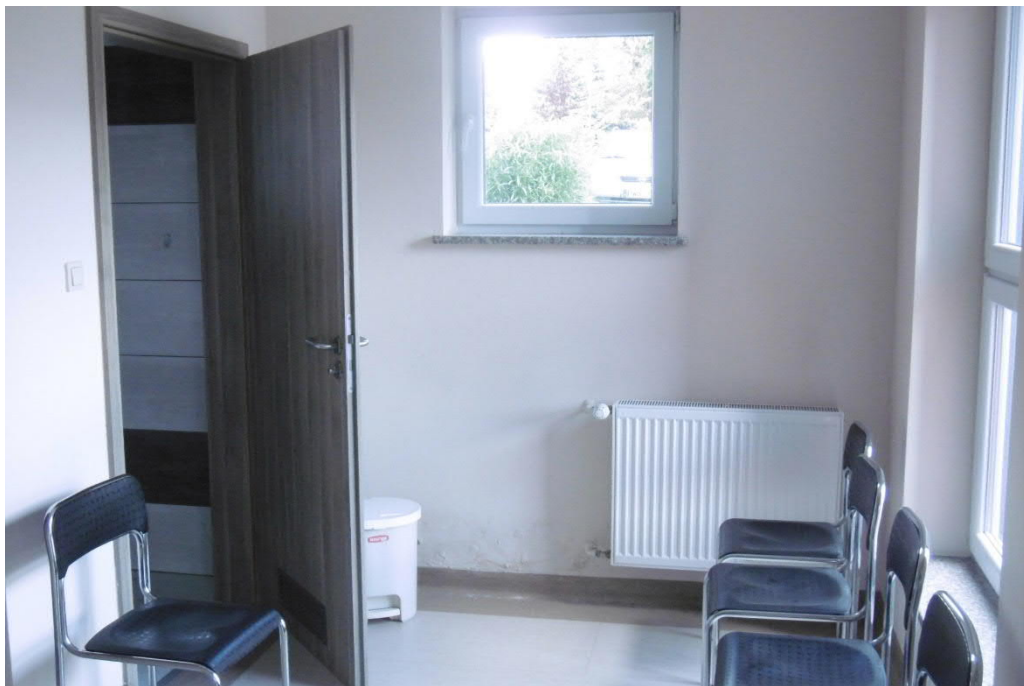
Fot. 16 – Widok zawilgoceń w holu
