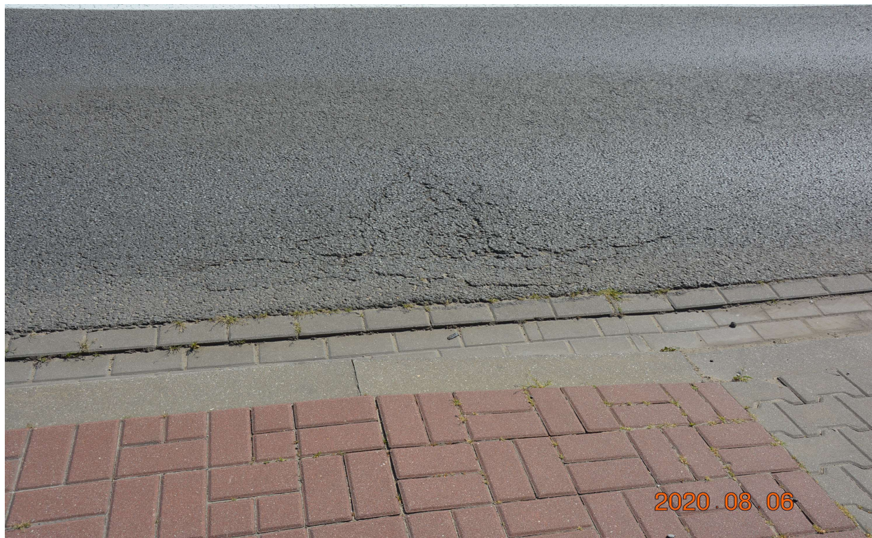
Fot. 5. Zarysowania nawierzchni jezdni.
