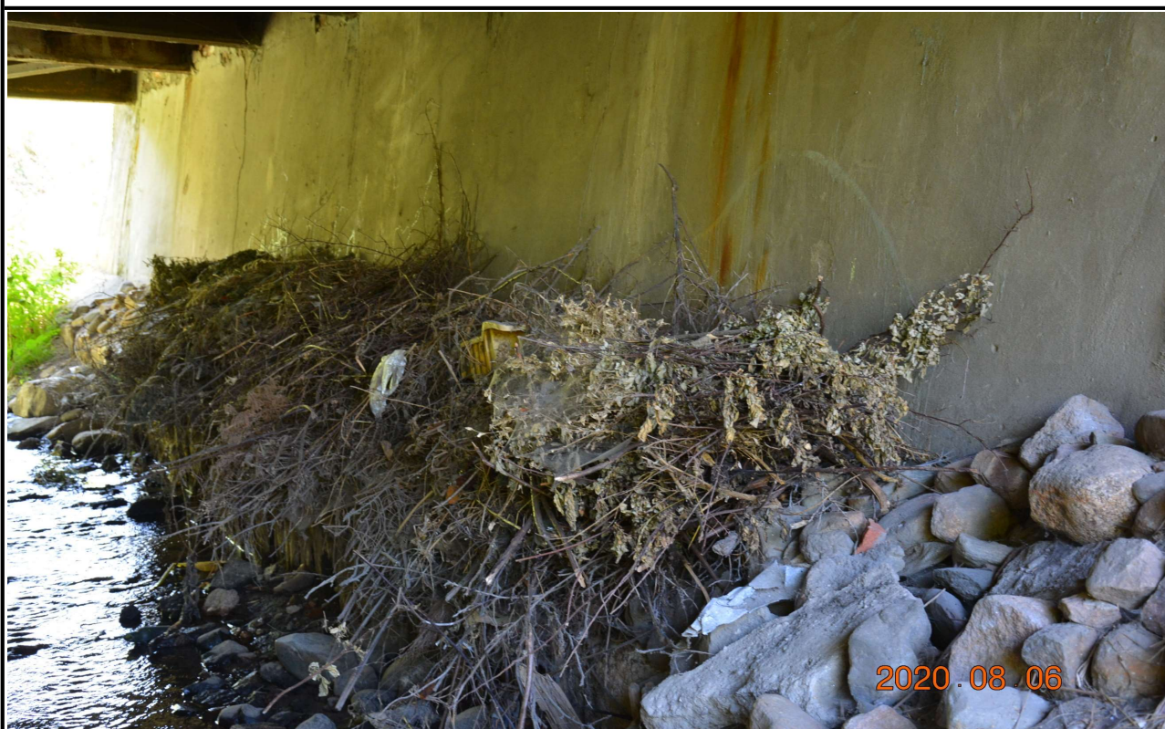
Fot. 12. Zanieczyszczenia przestrzeni podmostowej.
