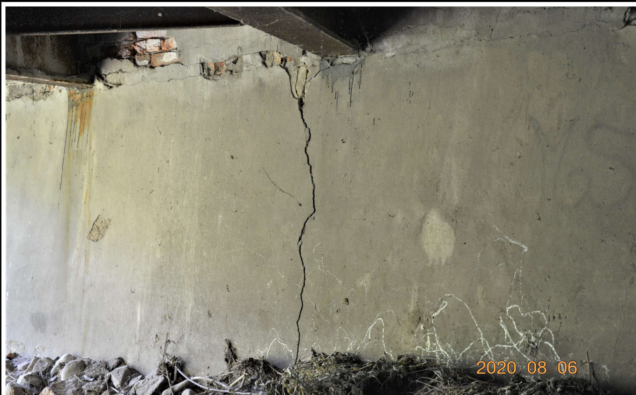
Fot. 10. Pęknięcie betonu przyczółka.
