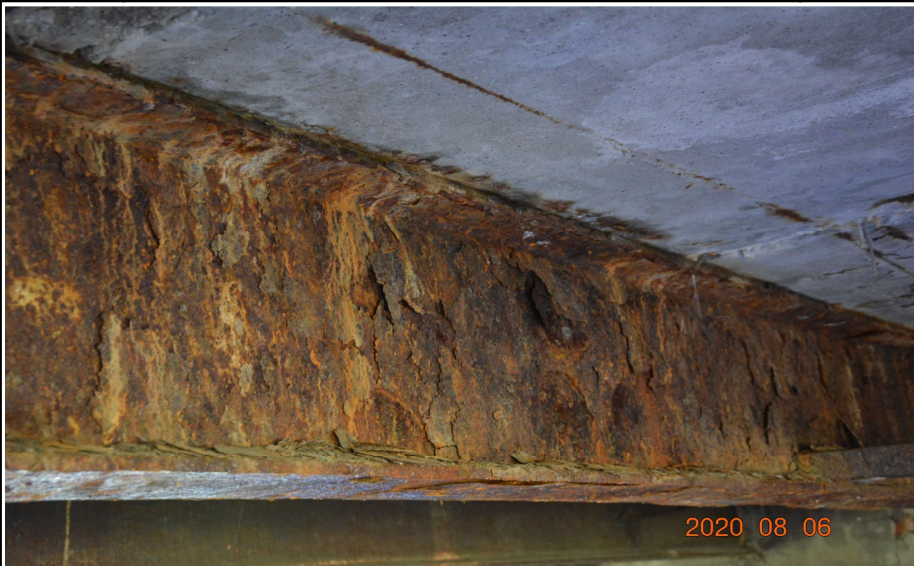
Fot. 9. Korozja wżerowa stalowego dźwigara.
