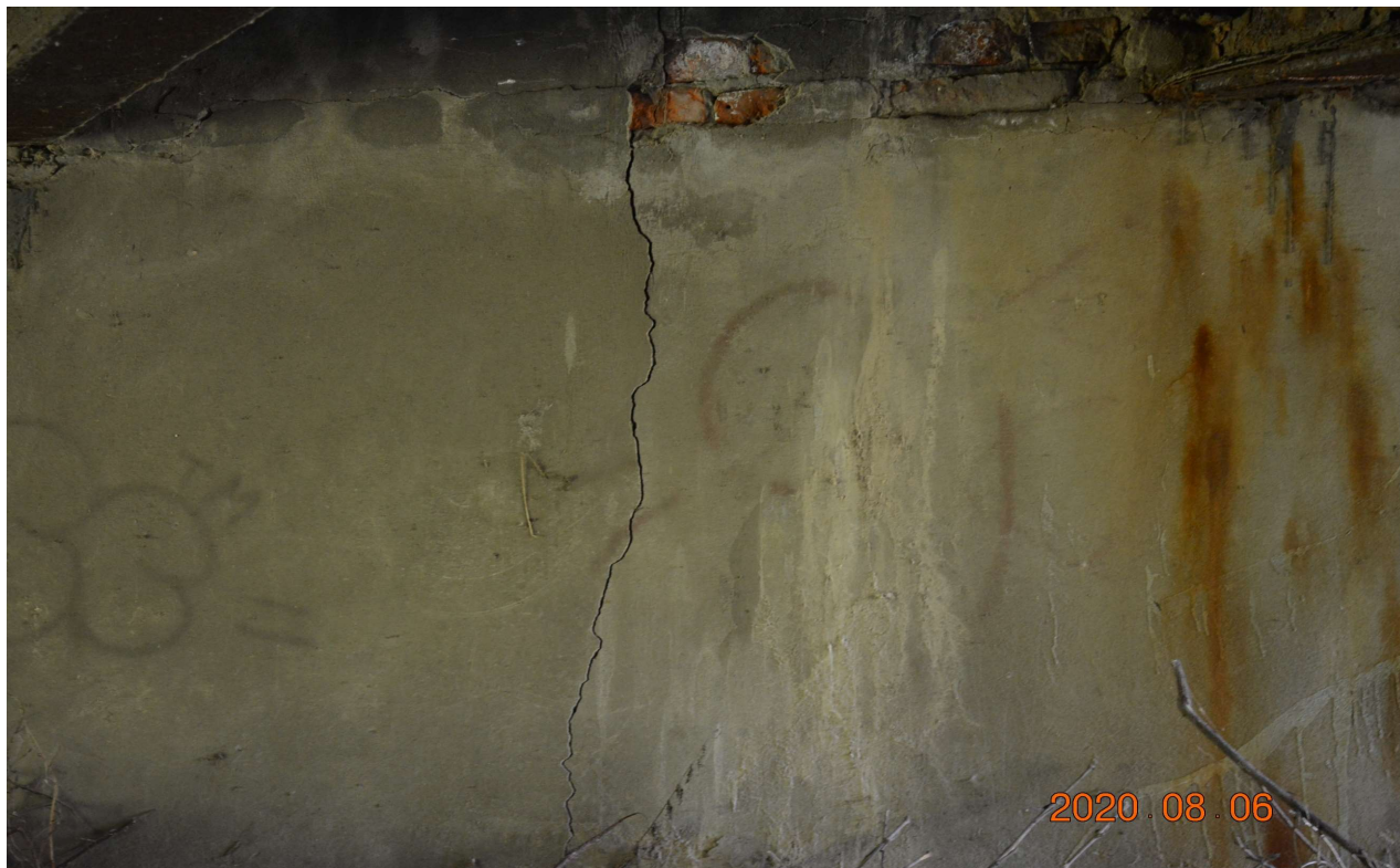
Fot. 11. Pęknięcie betonu przyczółka.
