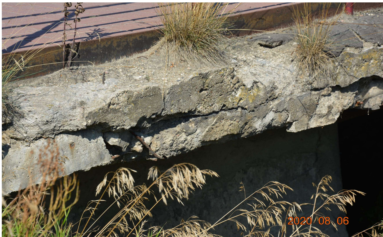
Fot. 7. Korozja zbrojenia i ubytki betonu gzymsu.
