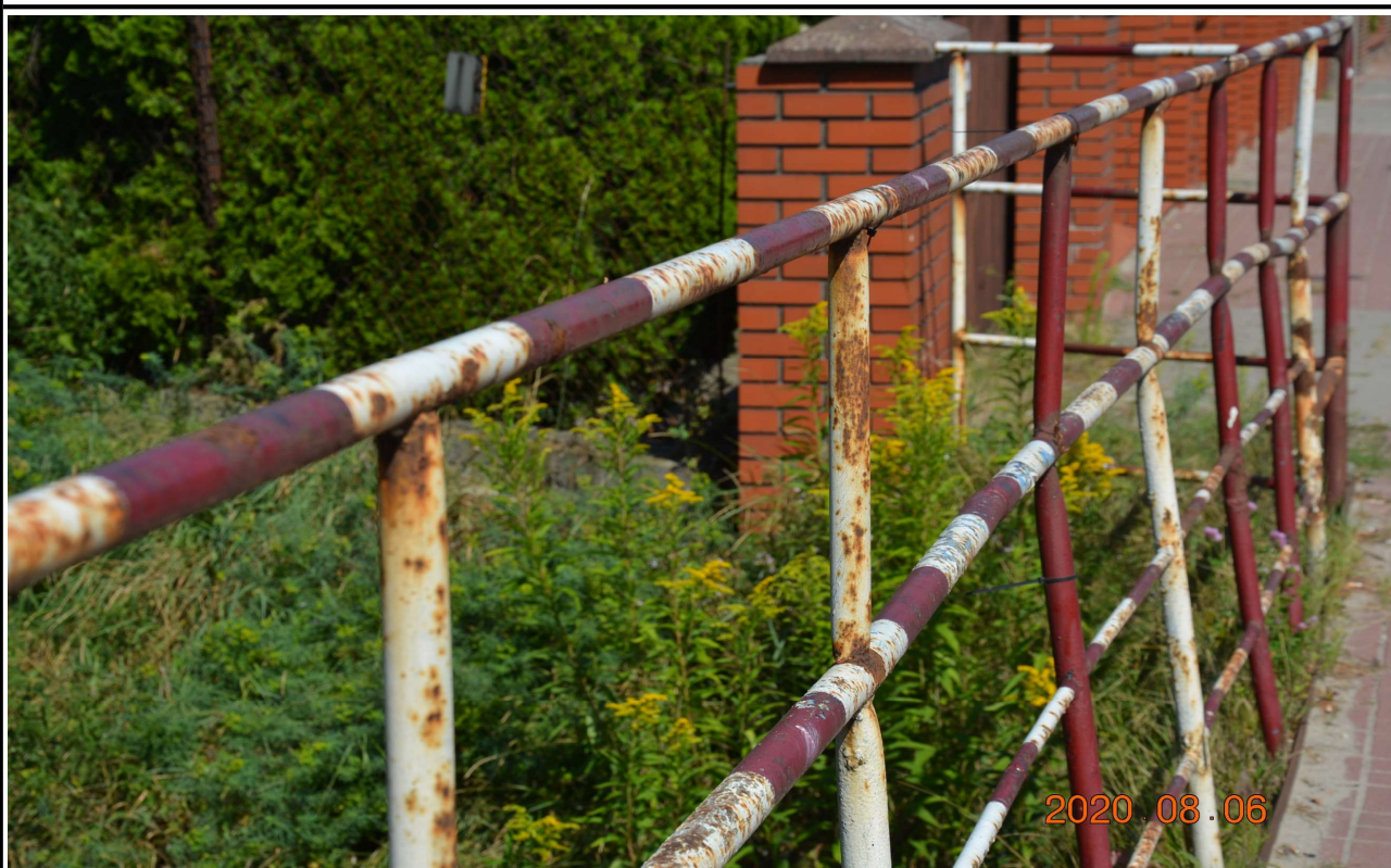
Fot. 6. Korozja i deformacje balustrady.
