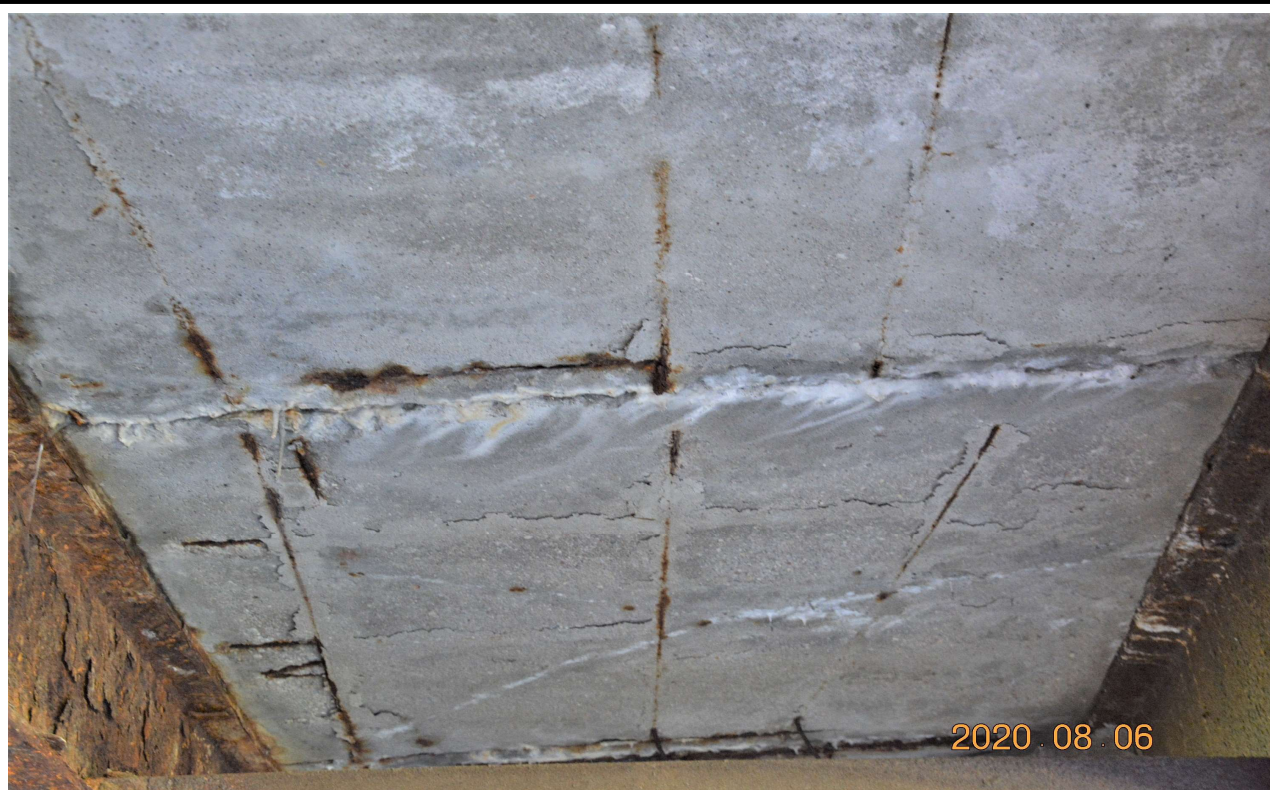
Fot. 8. Korozja zbrojenia, ubytki betonu oraz zacieki i osady konstrukcji pomostu świadczące o nieskuteczności izolacji.
