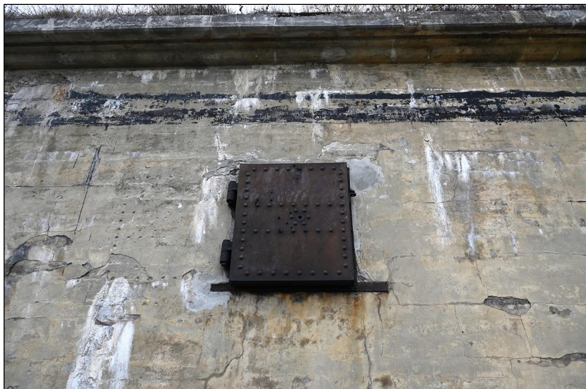
Fot. 13. Wykwity solne i nacieki mineralne na elewacji. Widoczne także ubytki odspojonego tynku i reperacje.
