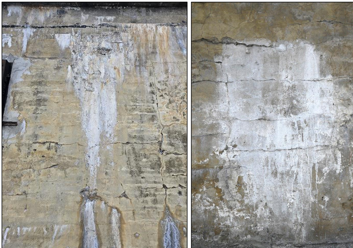
Fot. 14. Fot. 15. Nacieki solne – ich forma wskazuje jednoznacznie na wycieki wody ze szczelin i pęknięć konstrukcji. Wokół wykwitów widoczne wyraźnie zawilgocenie.
