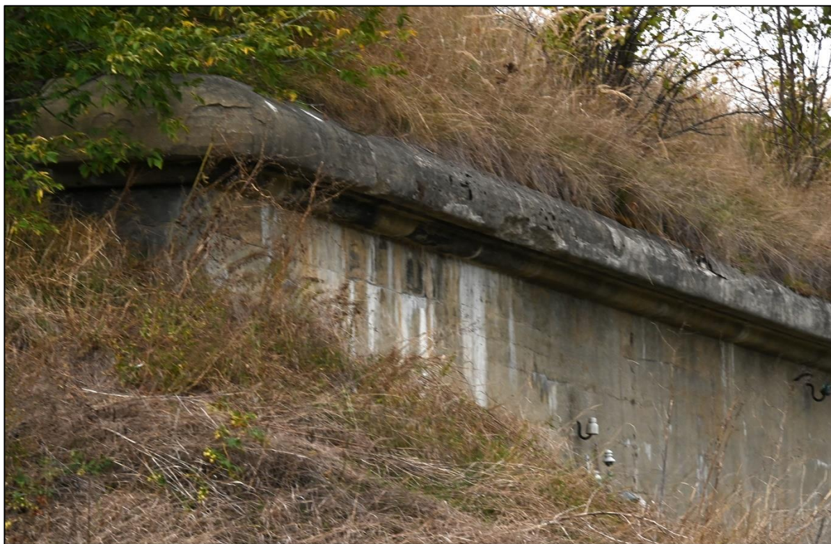
Fot. 7. Widok elewacji prochowni od strony południowo-zachodniej. Humus z nasypu ziemnego zsunięty na gzyms i porośnięty roślinnością. Zdegradowany betonowy gzyms.
