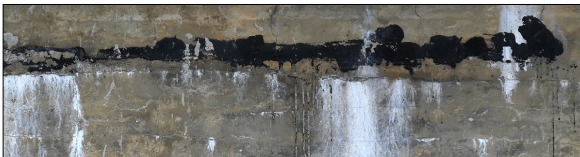
Fot. 10. Prawdopodobnie próba uszczelnienia przecieków wody lepikiem.
