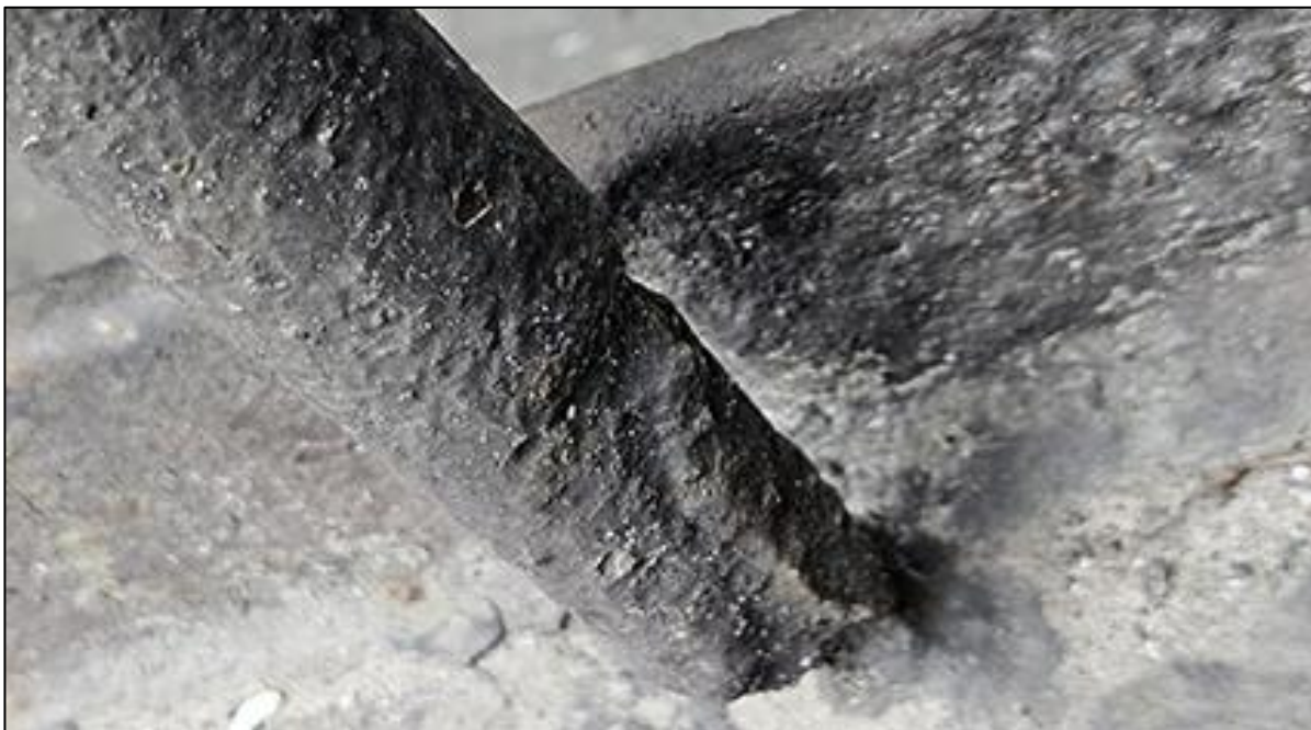
Fot. 47. Silnie skorodowana dolna część pręta.
