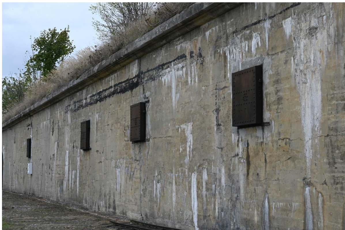
Fot. 5. Widok elewacji prochowni od strony północno wschodniej. Widoczne pozostałości żółtego wymalowania i liczne nacieki mineralne.
