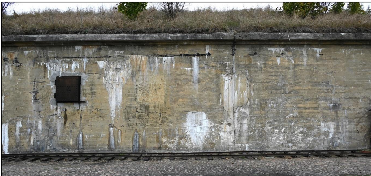
Fot. 8. Widok od frontu. Widoczne pozostałości żółtego wymalowania, liczne nacieki mineralne i reperacje.
