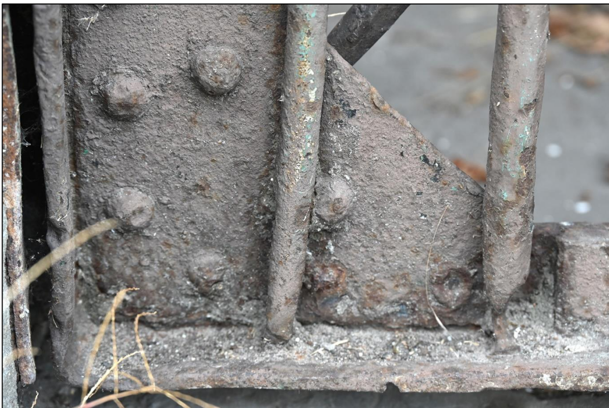
Fot. 28. Oryginalne i wtórne silnie skorodowane elementy.
