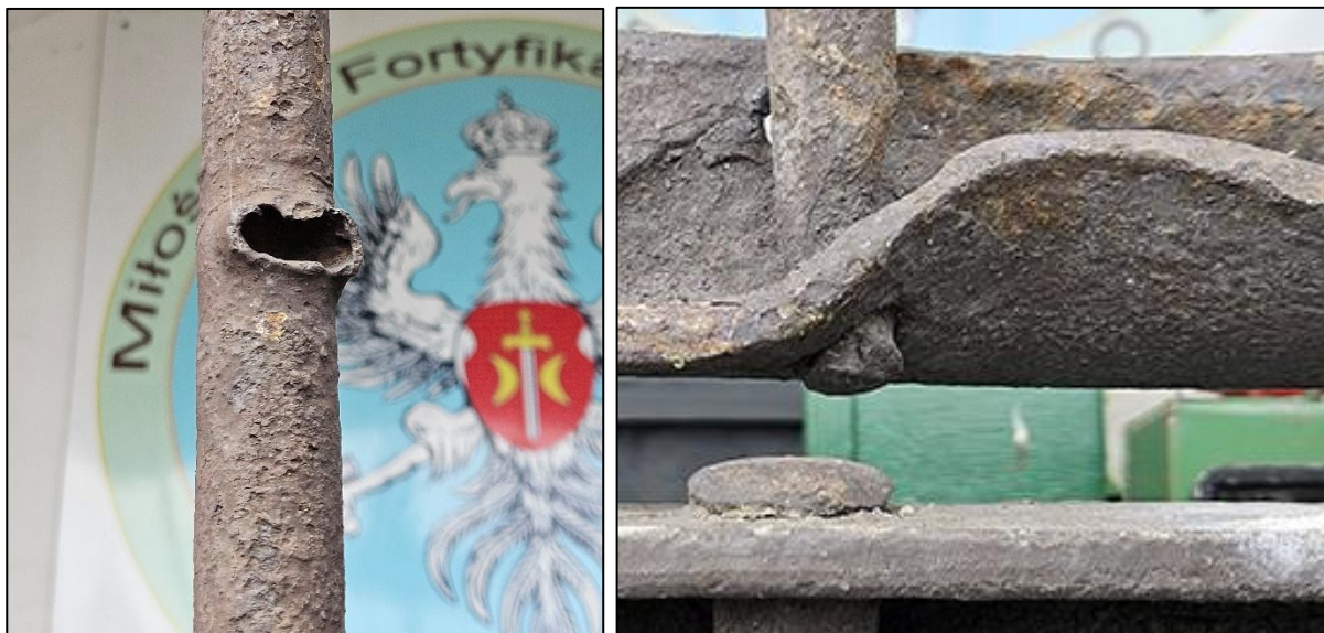
Fot. 43. Fot. 44.uszkodzenie spowodowane przez pocisk i deformacja kątownika; widoczny sposób łączenia elementów.
