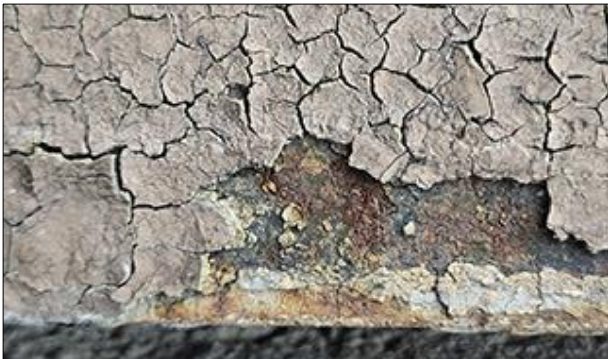
Fot. 50. W ubytkach grubych i spękanych przelawień widoczny skorodowany metal i, prawdopodobnie, oryginalne czarne wymalowanie
