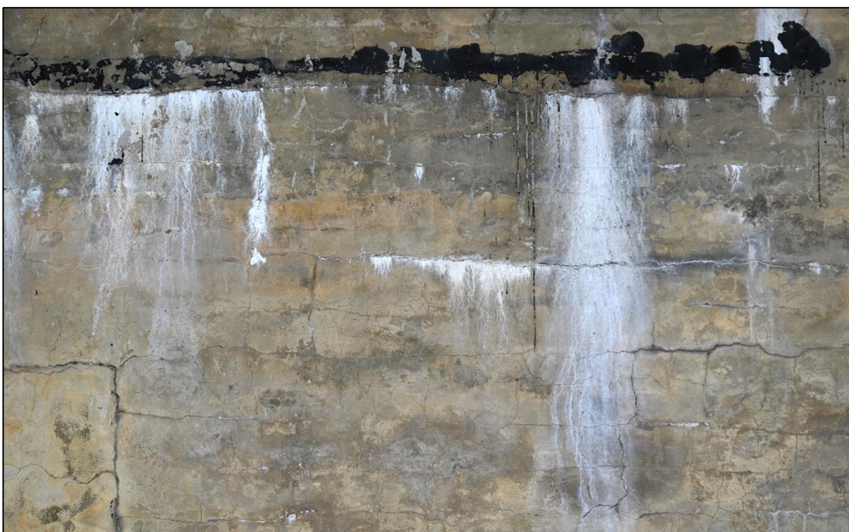
Fot. 9. Widoczne pozostałości żółtego wymalowania, siatka spękań tynku, solne nacieki i reperacje wykonane lepikiem.
