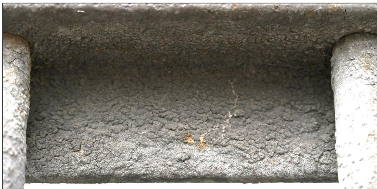
Fot. 45. Grube, spękanе warstwy wtórnych wymalowań; pod nimi skorodowany metal.
