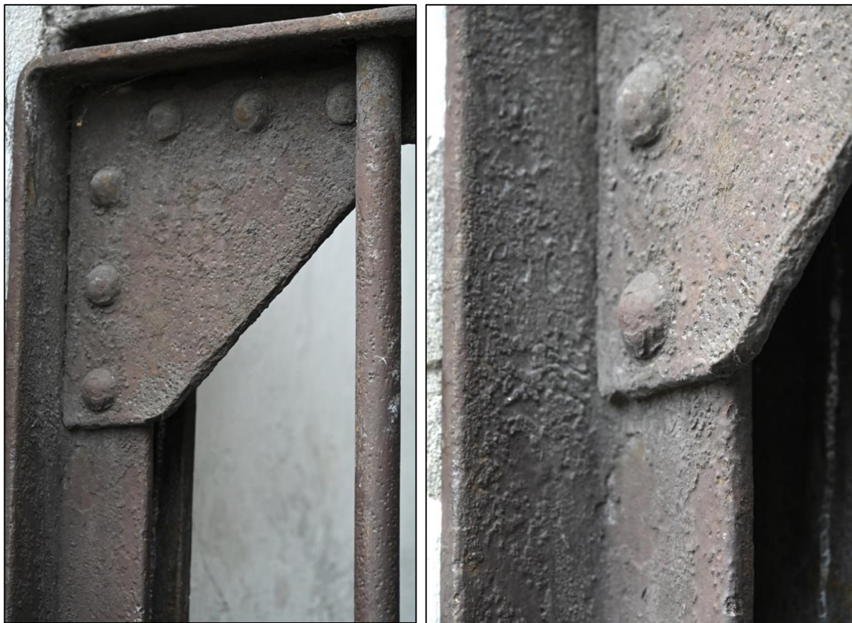
Fot. 39. Fot. 40. Nitowana do profilu płytka wzmacniająca konstrukcję bramy. Pod wymalowaniami widoczne wżery korozyjne.
