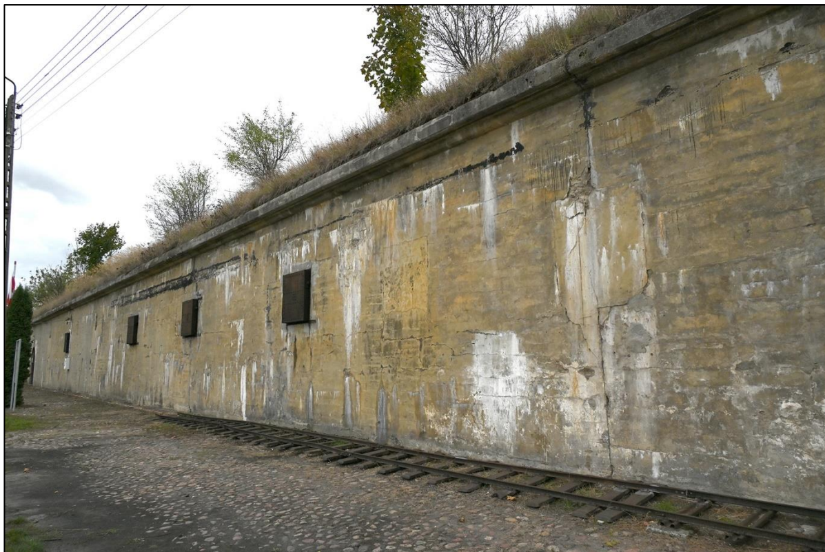
Fot. 4. Widok elewacji prochowni od strony północno wschodniej. Widoczne pozostałości żółtego wymalowania i liczne nacieki mineralne. Na nasypie ziemnym bujna roślinność.
