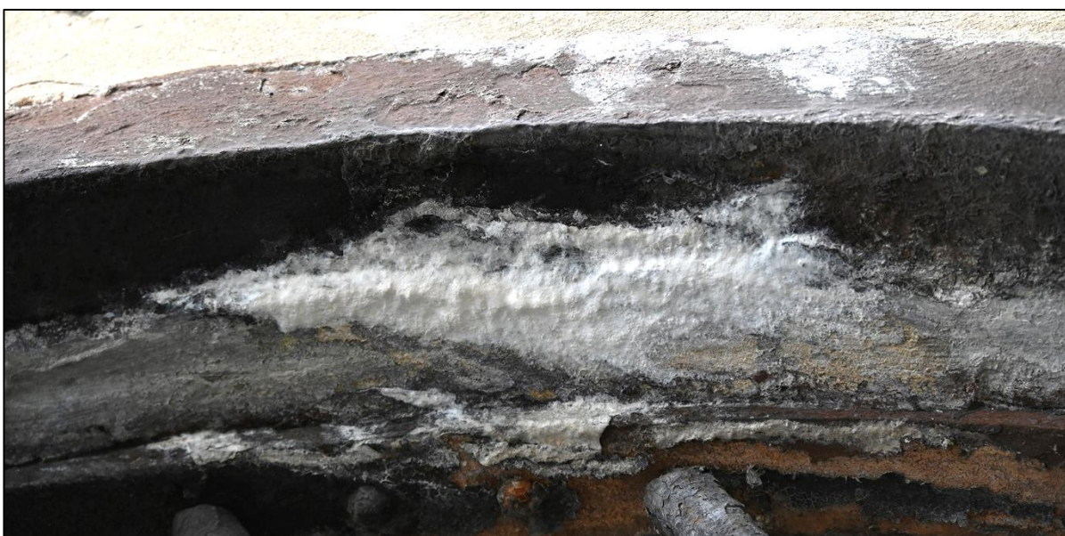
Fot. 38. Naciek solny na murze pomiędzy obramieniem otworu a kratą zachodzi także na elementy metalowe.
