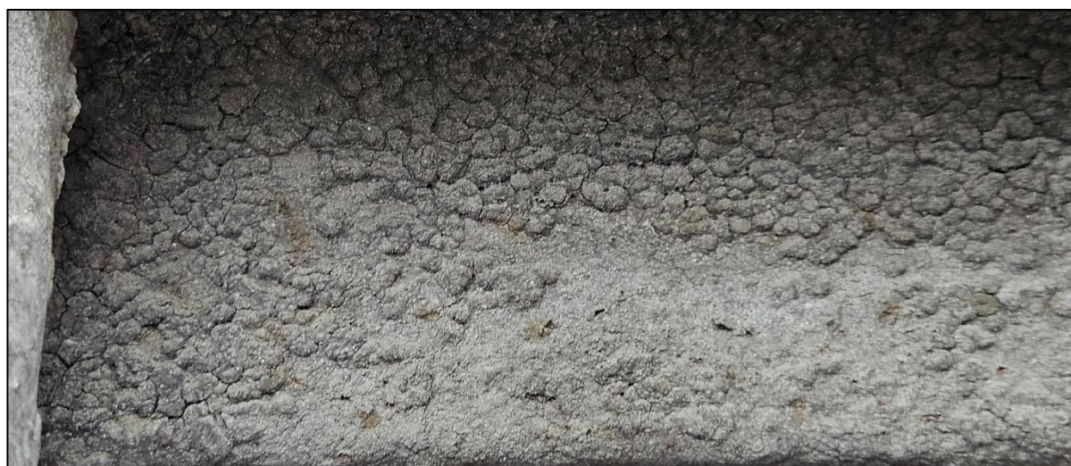
Fot. 46. Grube, spękanе warstwy wtórnych wymalowań; pod nimi skorodowany metal.
