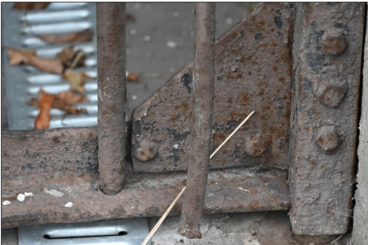
Fot. 27. Nitowane i śrubowe połączenia elementów. Widoczny wtórnie zamontowane pręt. Powierzchnia metalu silnie skorodowana i wielokrotnie przemalowana.
