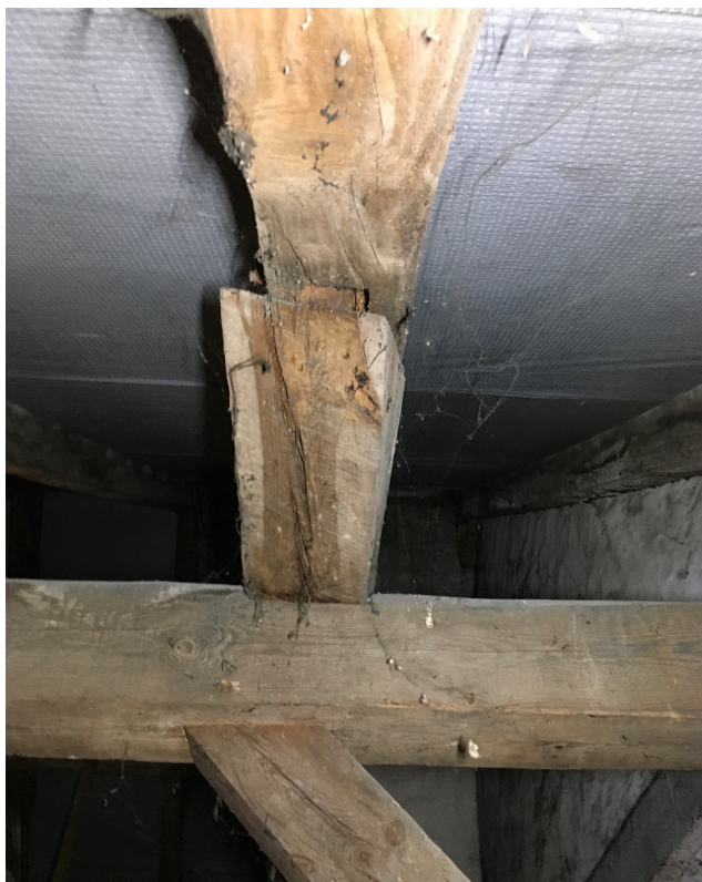
Fot. nr. 10. Zdeformowane łączenie kleszcza z krokwią.
