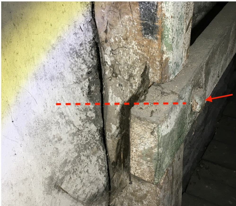
Fot. nr. 9. Kotwienie więźby dachowej w ścianie szczytowej - kotwa stalowa, przechodząca przez kleszcze i słup wprowadzona wewnątrz muru ściany szczytowej.
