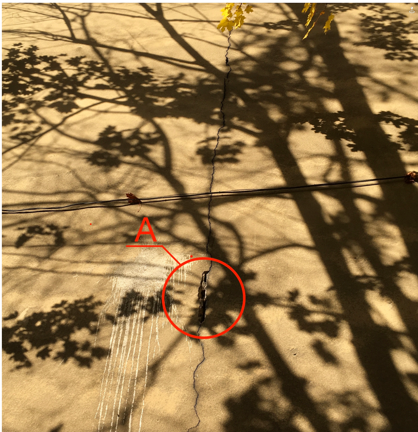
Fot. nr. 5. Zarysowania i spękania w środku ściany - widok pozostałej części ściany
