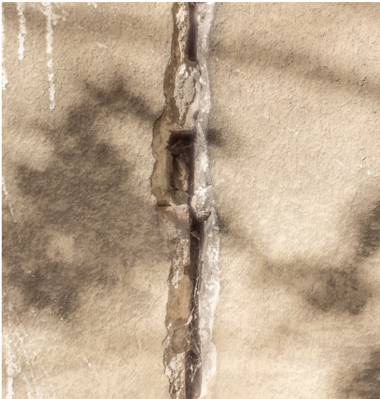
Fot. nr. 6. Zarysowanie przechodzące w pęknięcie ściany (szczegół „A” - patrz fot. nr 5)
