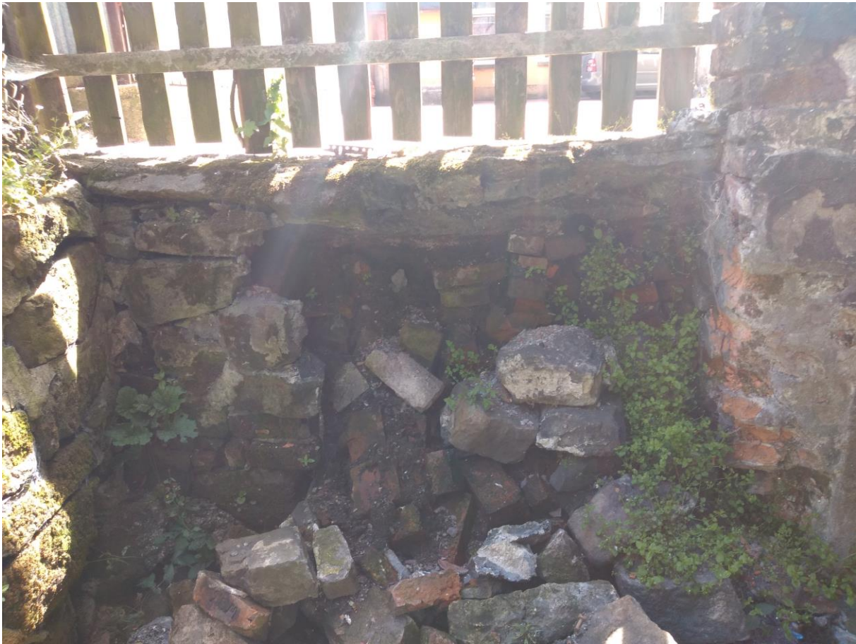
zawalony fragment muru oporowego
