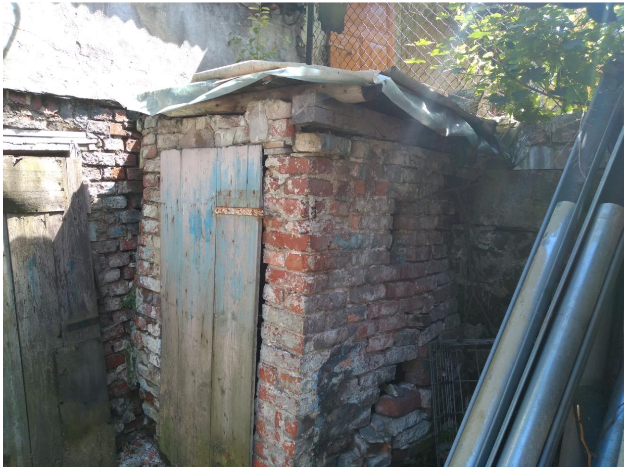
komórka murowana w złym stanie technicznym
