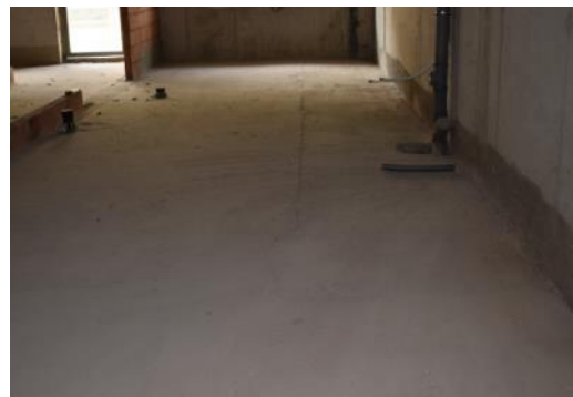
Zarysowania płyty na gruncie w piwnicy w osiach 8B-10B/CB-GB
