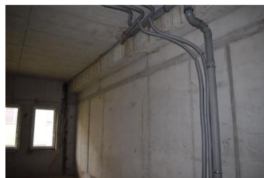
Zawilgocenia i zacieki na ścianie w osi CB
