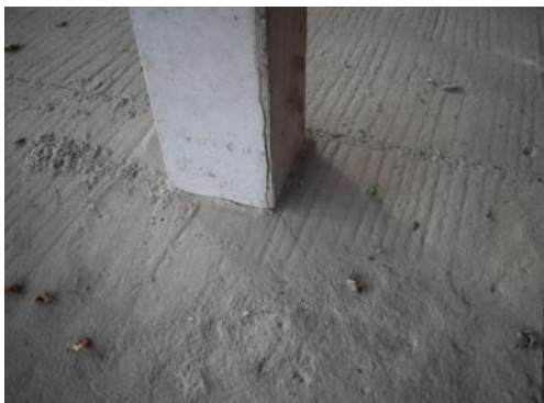
Zarysowanie płyty na gruncie – naroże słupa
