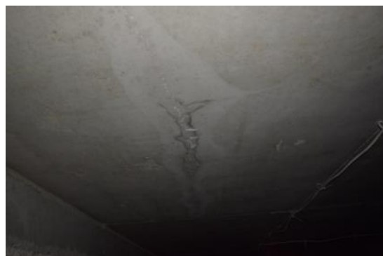
Zawilgocenia płyty stropodachu w miejscach zarysowań
