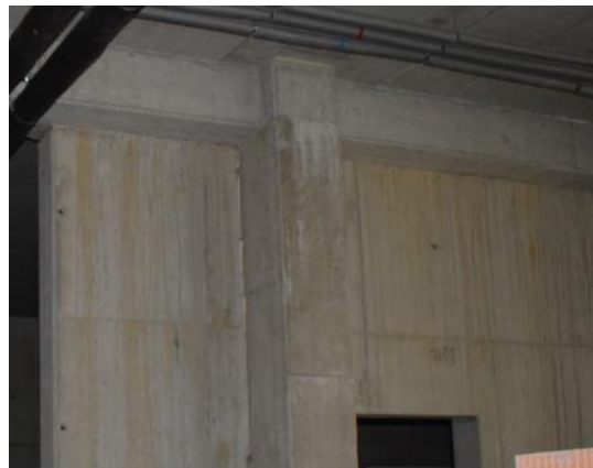
| 16 | Zawilgocenia i rdzawe zacieki na ścianie przy dylatacji z Segmentem D
