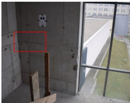
Ściana zewnętrzna w osi 4A (klatka schodowa K2) – lokalizacja odstąpiętego zbrojenia
