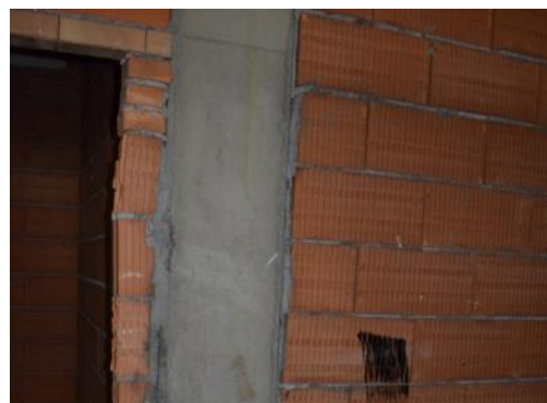
Wykorzystanie uszkodzonych pustaków do wykonania fragmentu ściany, niepoprawne połączenie muru z elementem konstrukcyjnym
