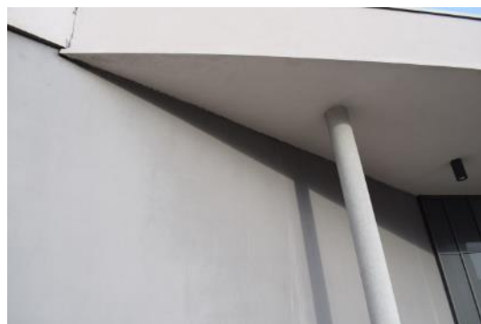
Zarysowania i zacieki na elewacji w osiach 6B-7B/LB
