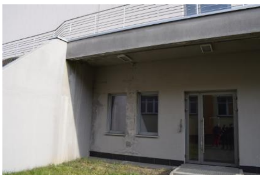
Zawilgocenia na elewacji – narożnik przy ścianach w osiach CB i 10B
