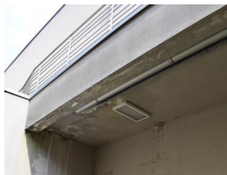
Zawilgocenia na elewacji – narożnik przy ścianach w osiach CB i 10B
