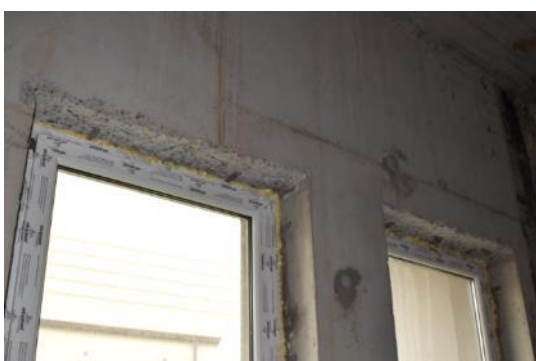
Podkute nadproża ściany w osi 10B – poziom -1
