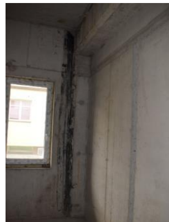
Zawilgocenia i zacieki na ścianie w osi 10B przy osi CB
