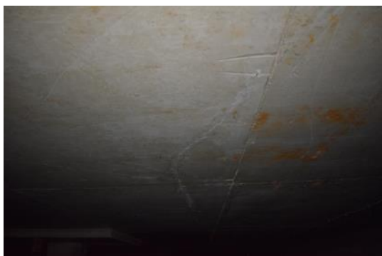
Zarysowania i rdzawe naloty na dolnej powierzchni stropodachu – widok 2
