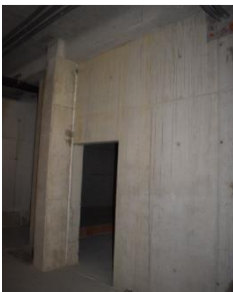
Zawilgocenia i rdzawe zacieki na ścianie przy dylatacji z Segmentem D | 15
