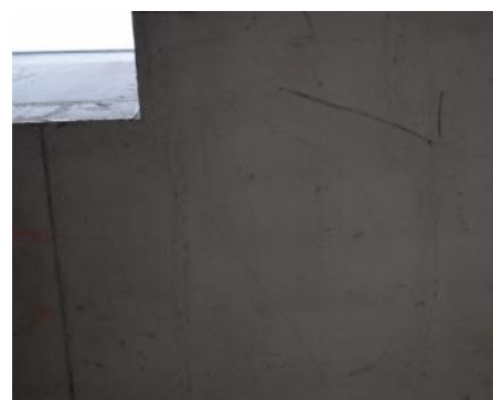
Zarysowania stropu nad parterem przy otworach – część nieużytkowana
