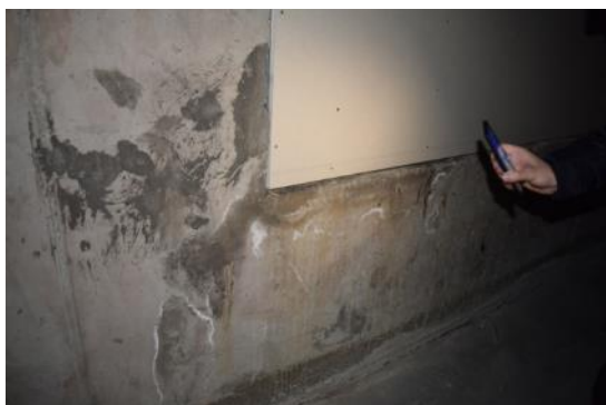
Zawilgocenie ściany przy dylatacji w części podziemnej
