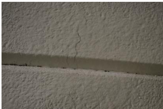
Zarysowania wykończenia słupa – poziom -1
