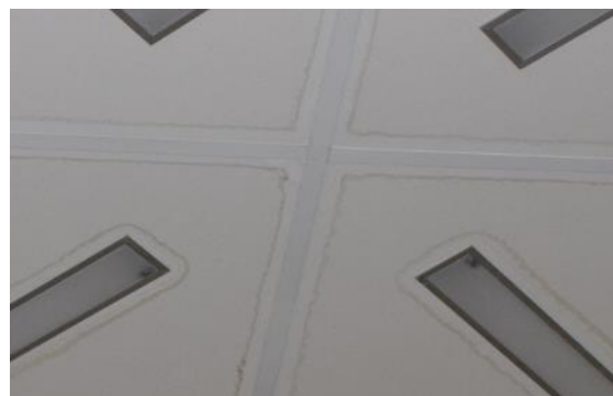
Zacieki na suficie podwieszanym w obszarze dylatacji pomiędzy segmentami
