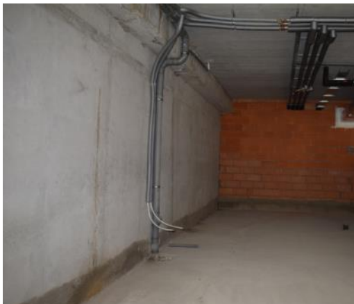
Zawilgocenia i zacieki na ścianie w osi CB
