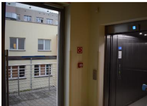
Winda zlokalizowana przy ścianie zewnętrznej w osi 10B - parter
