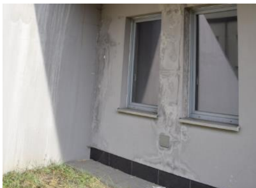
Zawilgocenia na elewacji – narożnik przy ścianach w osiach CB i 10B
