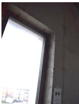
Wycięty otwór w ścianie żelbetowej i niezabezpieczone pręty zbrojeniowe
