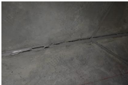
Zarysowanie posadzki w miejscu nacięcia, brak szczelnego wypełnienia nacięć na posadzce
