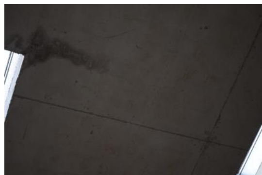
Zarysowania i zawilgocenia stropu nad parterem przy otworach – część nieużytkowana
