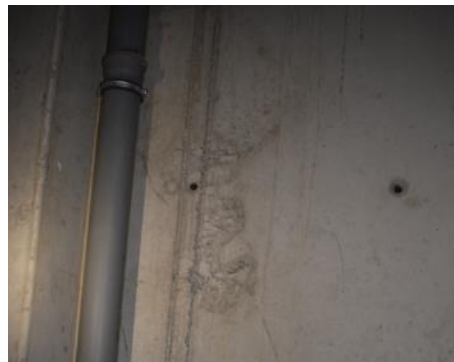
| 18 | „Raki” na ścianie w osi 1B
