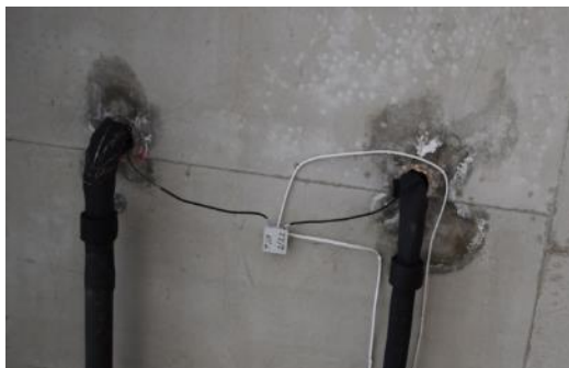
Zawilgocenia stropu nad parterem w miejscu prowadzenia instalacji wod.-kan. – część nieużytkowana
