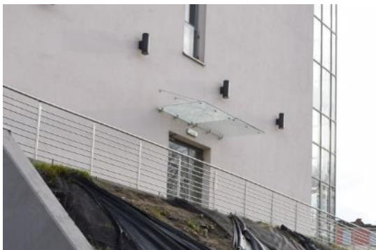
Uszkodzony daszek nad wejściem do Segmentu B w osi 10B – parter
