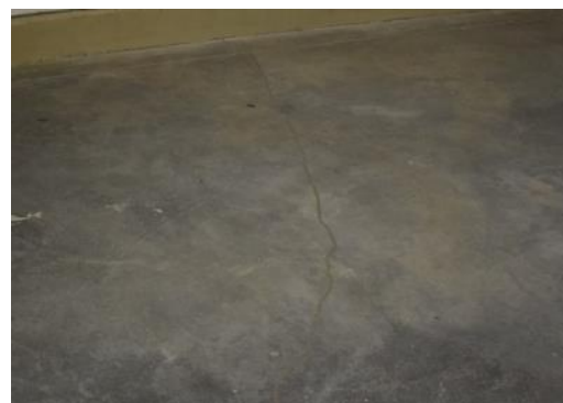
Lokalne zarysowania posadzki betonowej w garażu
