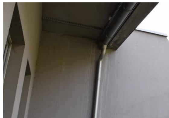
Zawilgocenia na elewacji – narożnik przy ścianach w osiach 10B i HB
