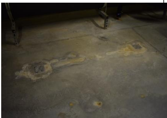
Zacieki na posadzce w obszarze odpływów
