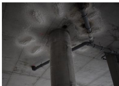
Pianka przeciwgrzybicza/izolacyjna w obszarze słupa okrągłego – strop nad parterem
