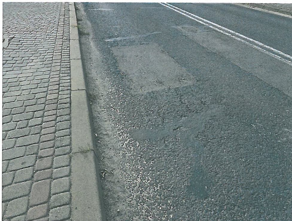
Fot.2 Skoleinowana nawierzchnia bitumiczna
