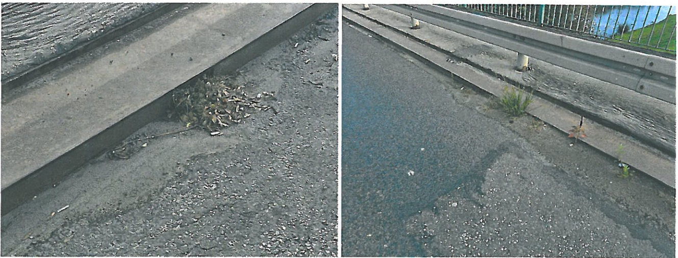
Fot.7 Zanieczyszczenia i zastoiska przy urządzeniach odwadniających
