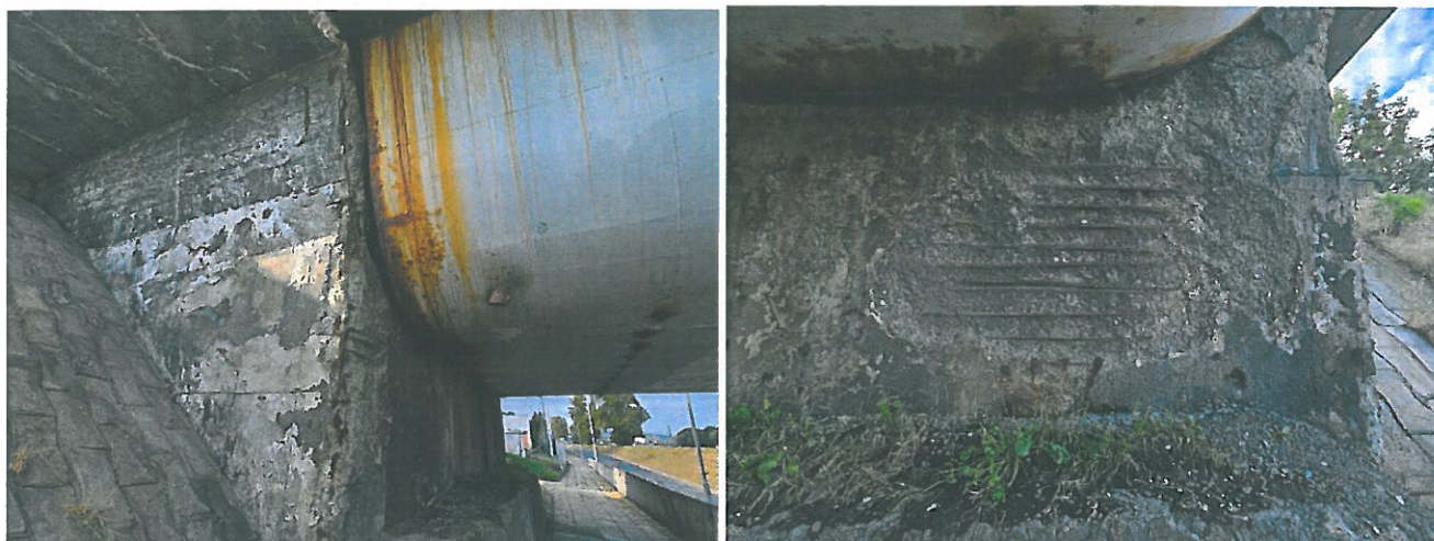
Fot. 10 Korozja przyczółków
