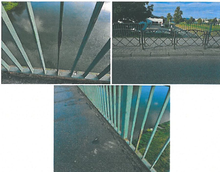
Fot.8 Skorodowane elementy barierek
