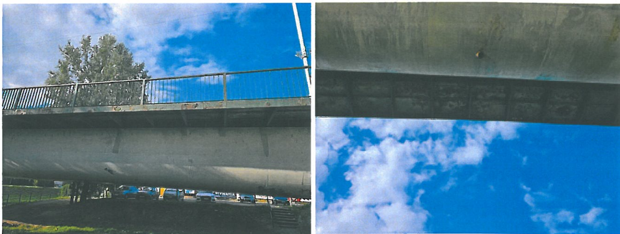
Fot.9 Widoczna korozja elementów kap chodnikowych
