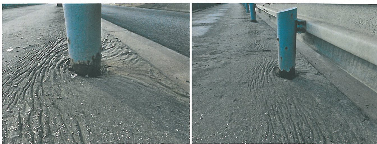
Fot.5 korozja słupków barier energochłonnych, uszkodzenia nawierzchni chodników
