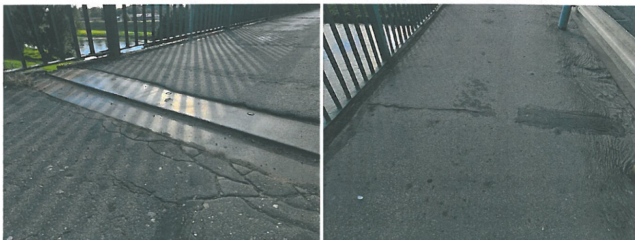
Fot.4 Spękania, skoleinowania na nawierzchni chodnika
