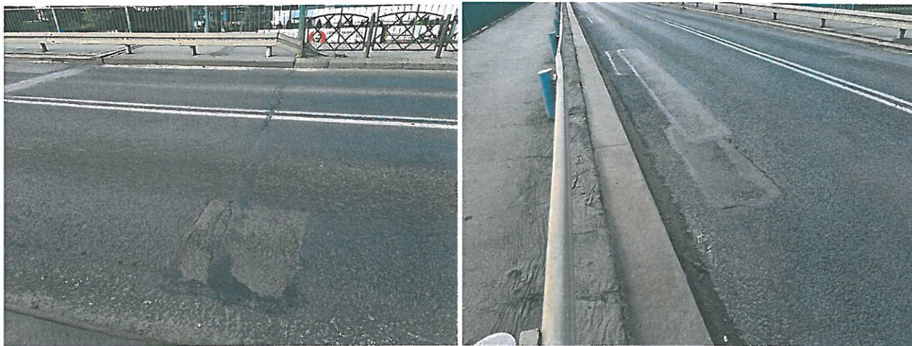
Fot.3 Spękania nawierzchni bitumicznej
