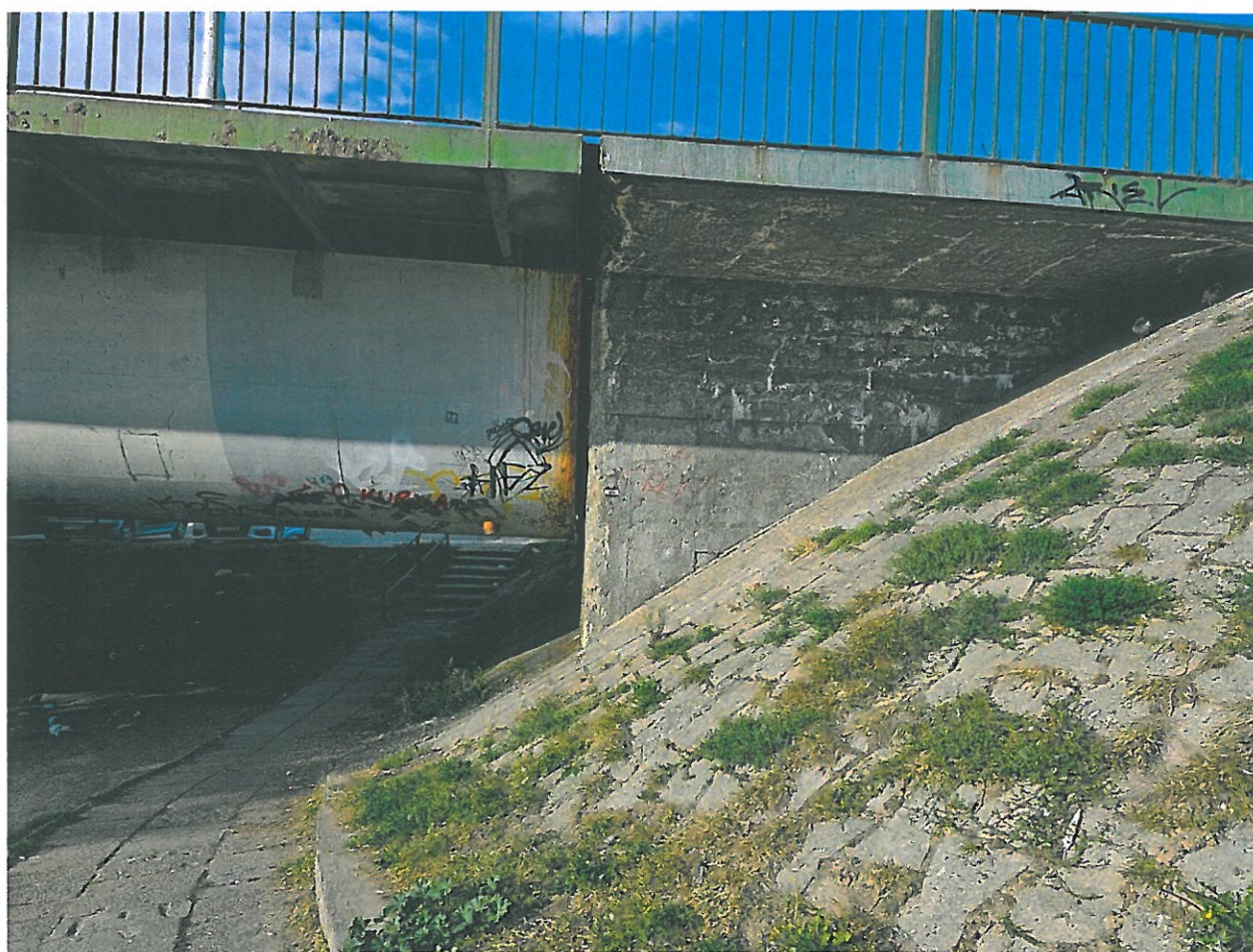
Fot.10 Widoczne przecieki/nieszczelność dylatacji
