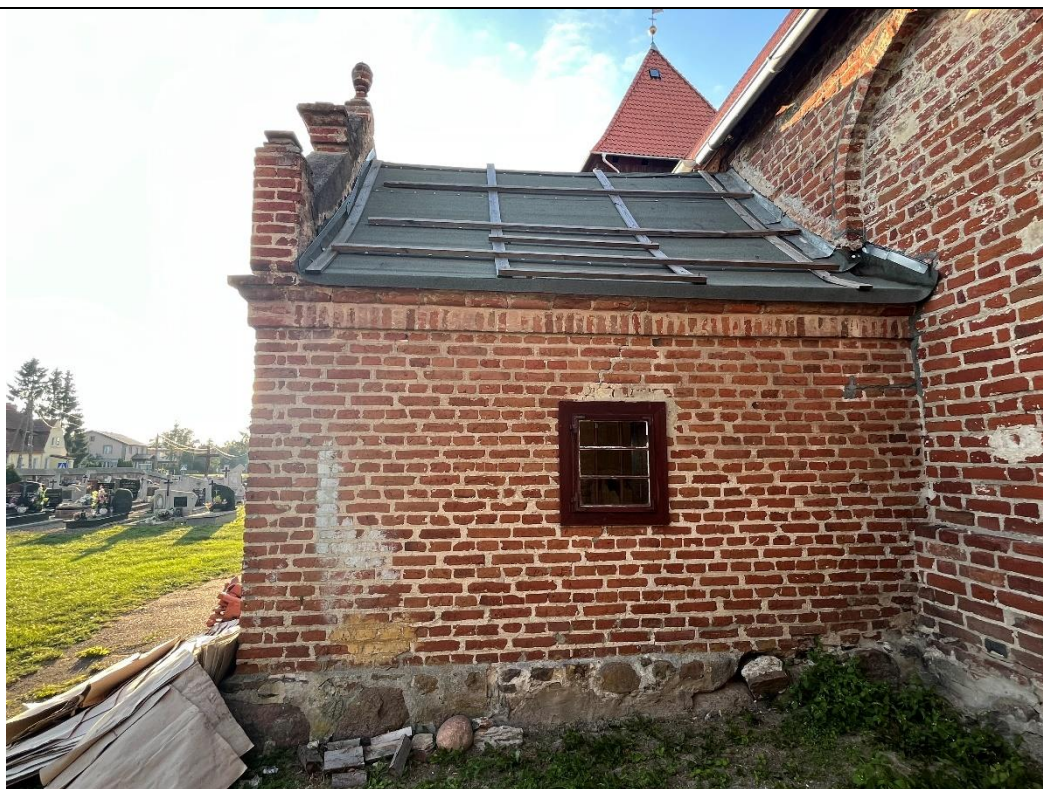
27. Kwietniewo; kościół paraf. pw. Podwyższenia Krzyża Świętego – kruchta boczna; elewacja wschodnia. Obszerne, współczesne uzupełnienia zaprawą cementową w strefie cokołowej; zabrudzenia i miejscowe przemalowania wątku ceglanego; spękanie powyżej otworu okiennego.
