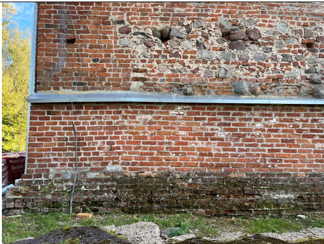
3. Kwietniewo; kościół paraf. pw. Podwyższenia Krzyża Świętego – korpus; elewacja północna, skraj wschodni (przyziemie). Relikty rozebranego aneksu zakrystii; cokół i pogrubienie dolnej części muru z odsadzką nakrytą blachą; zawilgocenie, nawarstwienia mikrobiologiczne w partii przyziemnej.
