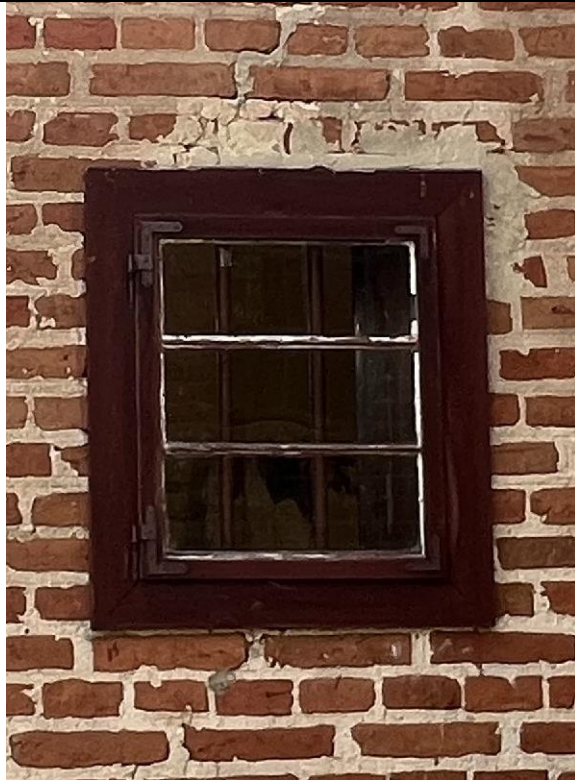
45. Kwietniewo; kościół paraf. pw. Podwyższenia Krzyża Świętego – kruchta boczna; elewacja wschodnia, okno (awers). Konstrukcja pokryta brązowo-bordową bejcą; ubytki kitu szklarskiego; korozja zawiasów i narożników.
