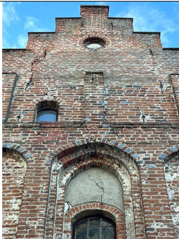
12. Kwieńtiewo; kościół paraf. pw. Podwyższenia Krzyża Świętego – korpus; elewacja wschodnia, odcinek środkowy (strefa podszczytowa i szczyt). Spękania na osiach otworów okiennych i w części południowej szczytu; wzmocnienia zaprawą cementową. w zwieńczeniu wnętrza otworu okiennego.
