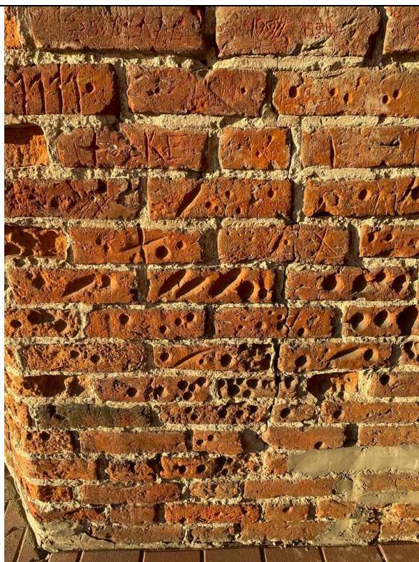
20. Kwietniewo; kościół paraf. pw. Podwyższenia Krzyża Świętego – wieża; elewacja zachodnia, odcinek środkowy (przyziemie). Liczne „ślady dołkowe” i zagłębienia podłużne, grafitti na ościeżach portalu; ubytki budulca i spoinowań; współczesne uzupełnienia zaprawą cementową.
