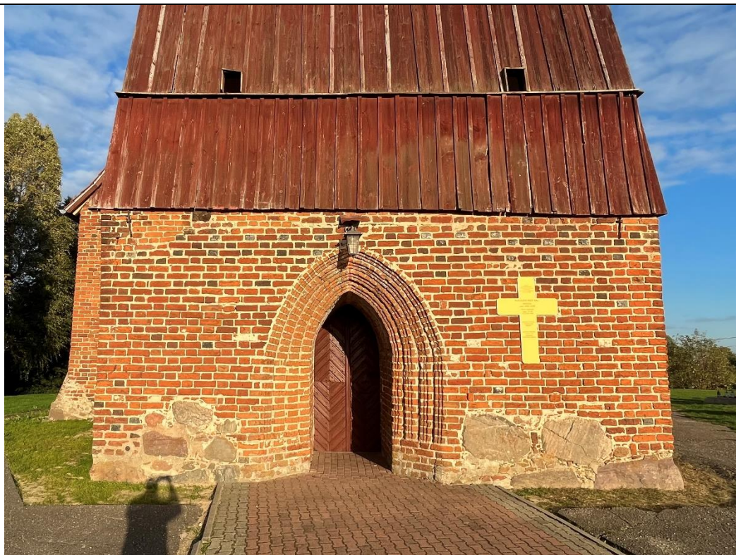
24. Kwietniewo; kościół paraf. pw. Podwyższenia Krzyża Świętego – wieża; elewacja zachodnia; (przyziemie i nadbudowa). Odspojenia, wypaczenie elementów w dolnej części szalunku; uszkodzenia powłoki ochronnej.
