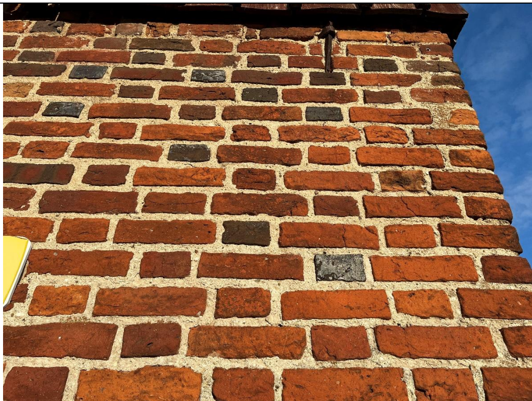
22. Kwietniewo; kościół paraf. pw. Podwyższenia Krzyża Świętego – wieża; elewacja zachodnia, odcinek południowy (przyziemie). Powierzchniowe zabrudzenia, przebarwienia lica; spękania, drobne ubytki budulca; historyczne uzupełnienia spoinowań zaprawą wapienną.
