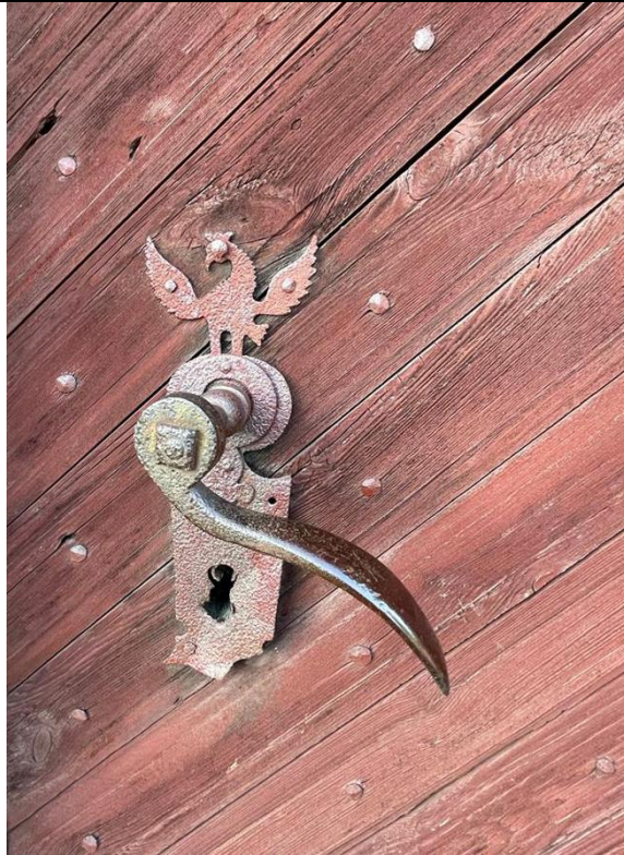
42. Kwietniewo; kościół paraf. pw. Podwyższenia Krzyża Świętego – przedsionek; elewacja południowa, drzwi (awers). Spękania drewna; otarcia, korozja okuć zamykających.
