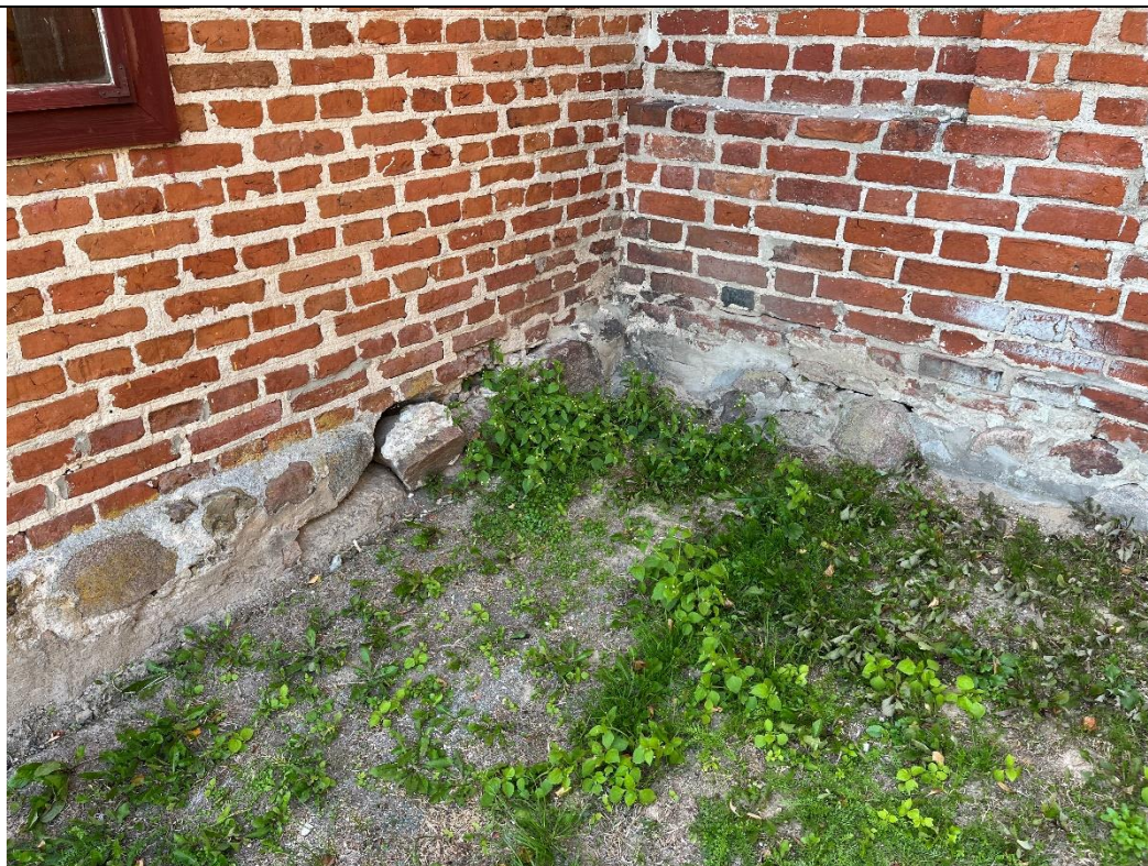
28. Kwietniewo; kościół paraf. pw. Podwyższenia Krzyża Świętego – kruchta boczna; elewacja wschodnia, odcinek północny (przyziemie). Odspojenia, głębokie ubytki budulca i zapraw w strefie cokołowej.
