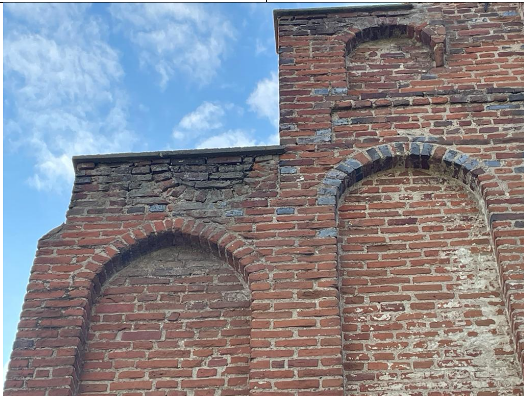
13. Kwieńtiewo; kościół paraf. pw. Podwyższenia Krzyża Świętego – korpus; elewacja wschodnia, skraj południowy (szczyt). Zawilgocenie, ubytki spoinowań poniżej krawędzi stopni; rozebrane współcześnie, przemurowane elementy wieńczące stopni, nakryty z zaprawy cementowej; relikty wypraw i pobiał wapiennych w polach blend i fryzu.
