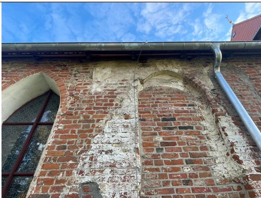
10. Kwietniewo; kościół paraf. pw. Podwyższenia Krzyża Świętego – korpus; elewacja północna, odcinek środkowy (strefy środkowa i podokapowa). Relikty wypraw i pobiał w miejscu rozebranego aneksu; obszerne uzupełnienia spoinowań zaprawą cementową; niewielki otwór okienny zaślepiiony współczesnym zamurowaniem z cegieł maszynowych na zaprawie cementowej.
