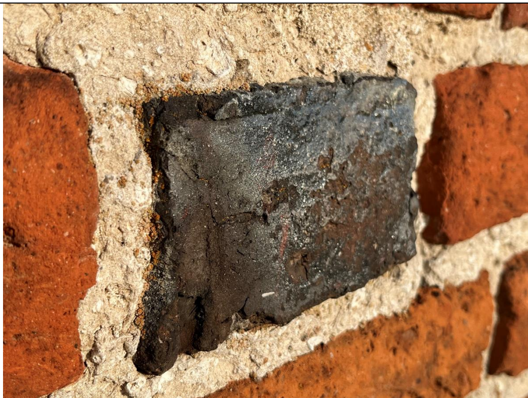
17. Kwietniewo; kościół parafialny pw. Podwyższenia Krzyża Świętego – wieża; elewacja zachodnia, odcinek północny (przyziemie). Dezintegracja, ubytki budulca i spoinowań pierwotnego wątku ceglano.
