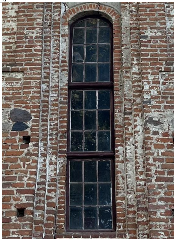
43. Kwietniewo; kościół paraf. pw. Podwyższenia Krzyża Świętego – korpus; elewacja wschodnia, okno (awers). Konstrukcja pokryta brązowo-bordową bejcą; ubytki kitu szklarskiego; osłabienie i spękanie drewna.
