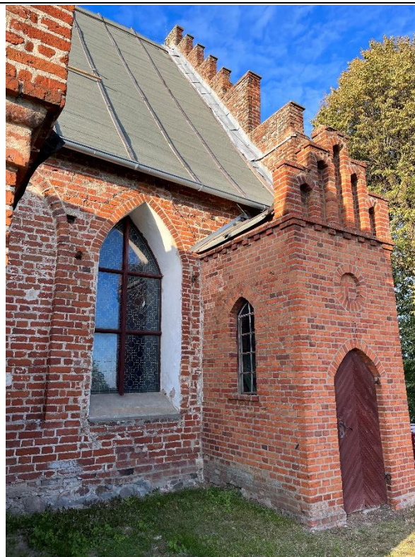
33. Kwietniewo; kościół paraf. pw. Podwyższenia Krzyża Świętego – przedsionek; elewacje zachodnia i południowa. Zawilgocenie partii przyziemnych, gzymsu wieńczącego, stopni szczytu.
