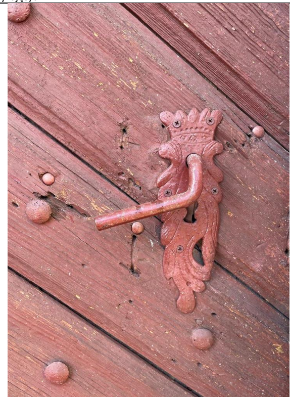
40. Kwietniewo; kościół paraf. pw. Podwyższenia Krzyża Świętego – kruchta boczna; elewacja południowa, drzwi (awers). Miejscowe uszkodzenia powłoki ochronnej; ubytki, spękania drewna; współczesne elementy mocujące, gwoździe i wkręty.
