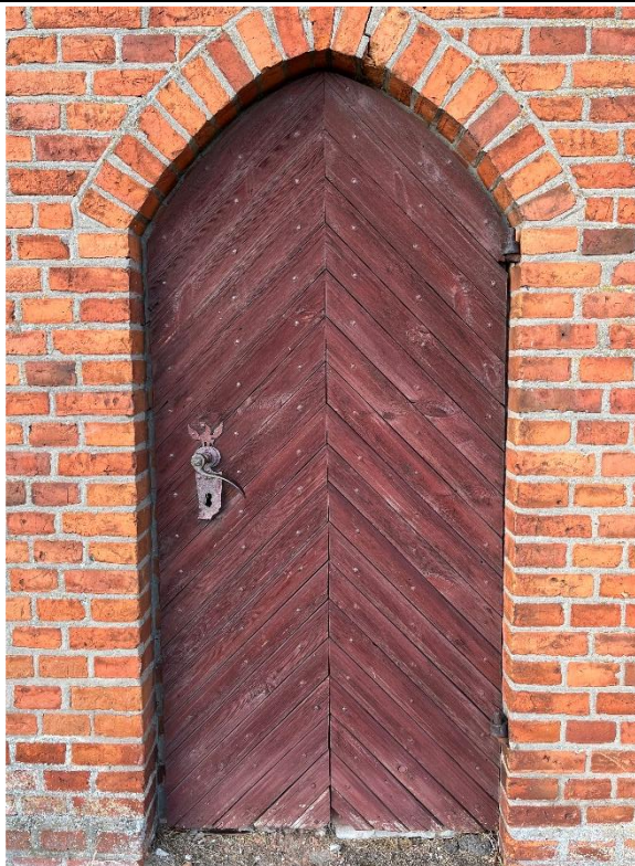
41. Kwietniewo; kościół paraf. pw. Podwyższenia Krzyża Świętego – przedsionek; elewacja południowa, drzwi (awers). Uszkodzenia powłoki ochronnej; ubytki, odkształcenia deszczułek w partii przyziemnej.
