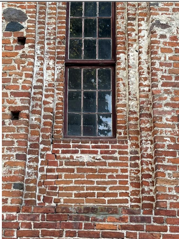
11. Kwieńtiewo; kościół paraf. pw. Podwyższenia Krzyża Świętego – korpus; elewacja wschodnia, odcinek środkowy (strefa środkowa). Spękania, ubytki spoinowań, relikty pobiał wapiennych we wnęce otworu okiennego; współczesne wzmocnienia parapetu zaprawą cementową.
