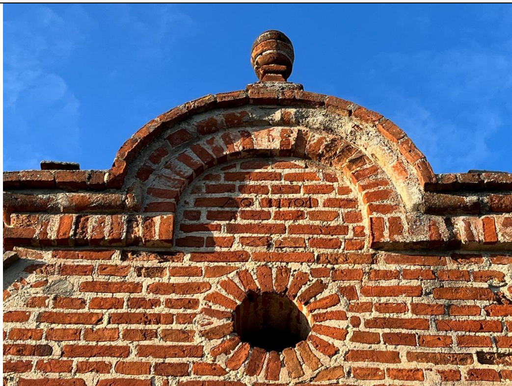
31. Kwietniewo; kościół paraf. pw. Podwyższenia Krzyża Świętego – kruchta boczna; elewacja południowa (szczyt). Liczne uszkodzenia w obrębie lica i gzymsu okalającego krawędzie szczytu; ubytki sterczyn w częściach bocznych zwieńczenia.
