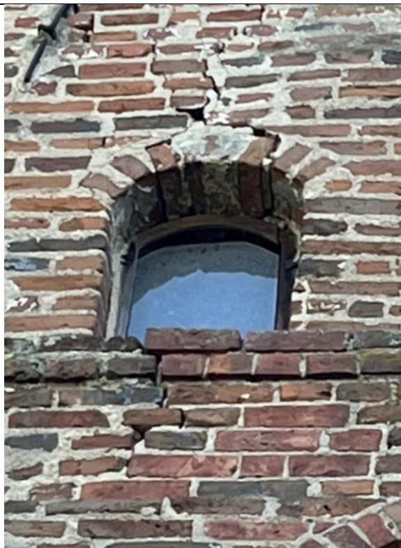
47. Kwietniewo; kościół paraf. pw. Podwyższenia Krzyża Świętego – korpus; szczyt wschodni, okno (awers). Współczesne szklenie, uproszczone podziały skrzydła; ubytki kitu szklarskiego; uszkodzenia powłoki ochronnej.
