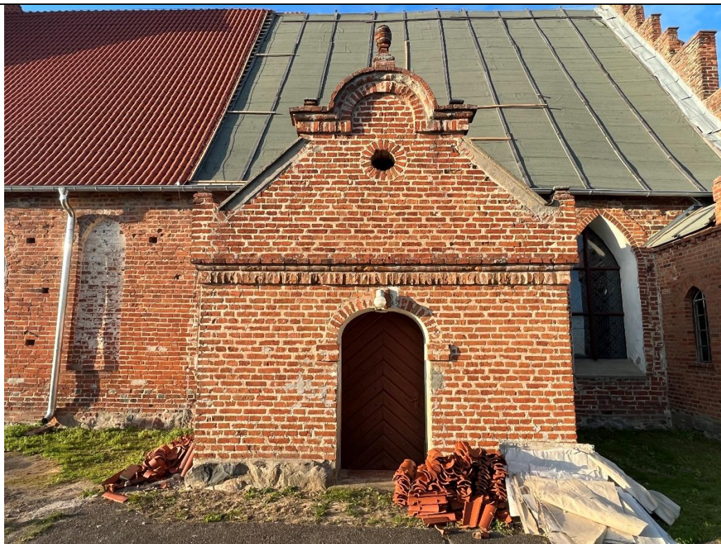
26. Kwietniewo; kościół paraf. pw. Podwyższenia Krzyża Świętego – kruchta boczna; elewacja południowa. Uszkodzenia lica i gzymsu wieńczącego; współczesne, miejscowe uzupełnienia zaprawą cementową.
