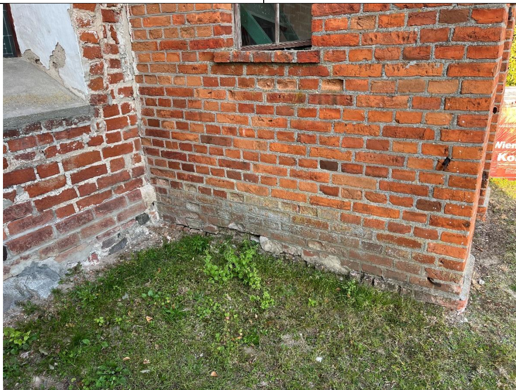
34. Kwietniewo; kościół paraf. pw. Podwyższenia Krzyża Świętego – przedsionek; elewacja zachodnia (przyziemie). Powierzchniowe zabrudzenia i przebarwienia lica; ubytki budulca w partiach przyziemnych i poniżej parapetu otworu okiennego.
