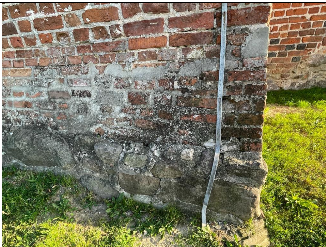
6. Kwietniewo; kościół paraf. pw. Podwyższenia Krzyża Świętego – korpus; elewacja północna, skraj zachodni (przyziemie). Odspojenia, głębokie ubytki, uzupełnienia zaprawami cementową, cementowo-wapienną; silne powierzchniowe zabrudzenia, przebarwienia i nawarstwienia mikrobiologiczne.
