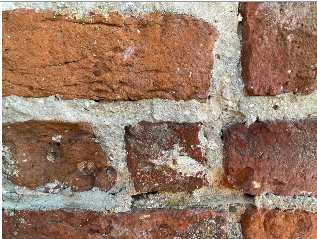
7. Kwietniewo; kościół paraf. pw. Podwyższenia Krzyża Świętego – korpus; elewacja północna, odcinek zachodni (przyziemie). Dezintegracja, ubytki budulca i spoinowań pierwotnego wątku ceglanego; fragmentaryczne uzupełnienia spoinowań zaprawą cementową.
