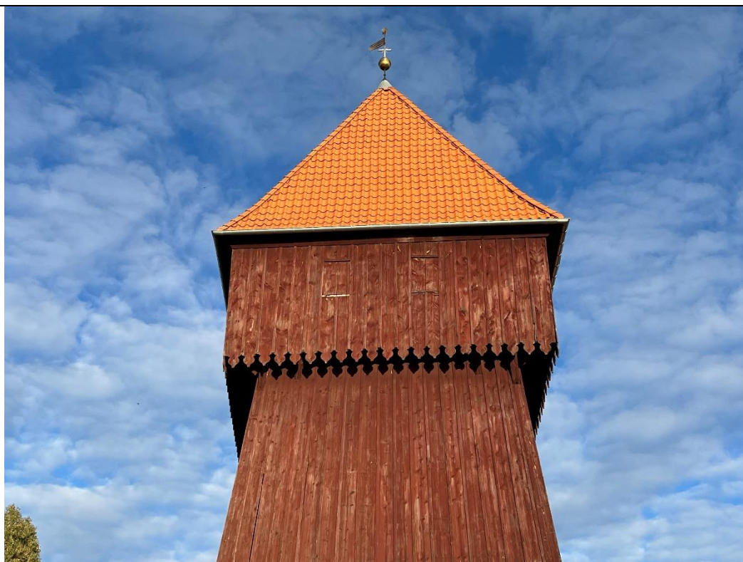
25. Kwietniewo; kościół paraf. pw. Podwyższenia Krzyża Świętego – wieża; elewacja zachodnia (nadbudowa). Uszkodzenia powłoki ochronnej; pojedyncze ubytki listew szalunku.
