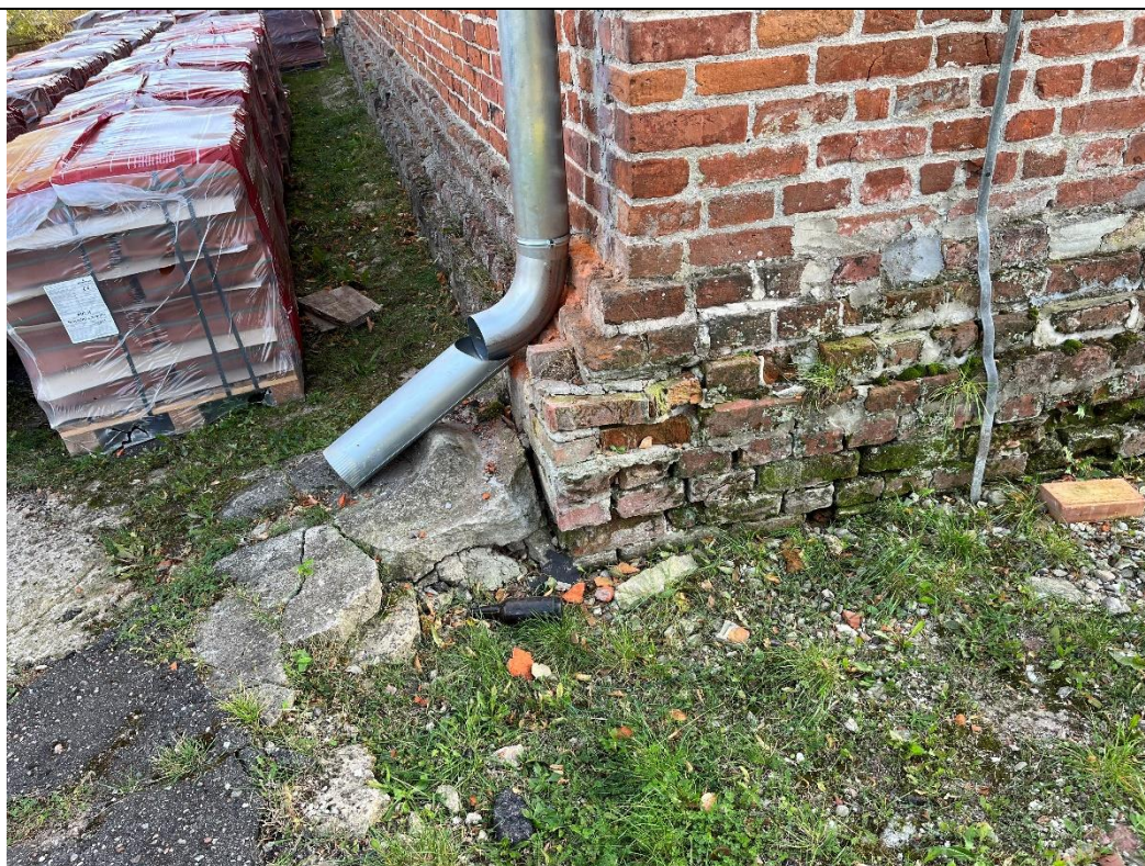
4. Kwietniewo; kościół parafialny pw. Podwyższenia Krzyża Świętego – korpus; elewacje wschodnia i północna/naroże północno-wschodnie (przyziemie i strefa środkowa). Ubytki budulca i zapraw, rozwarstwienie struktury murowej cokołu; ukorzenione siewki traw; miejscowe uzupełnienia zaprawą cementową.
