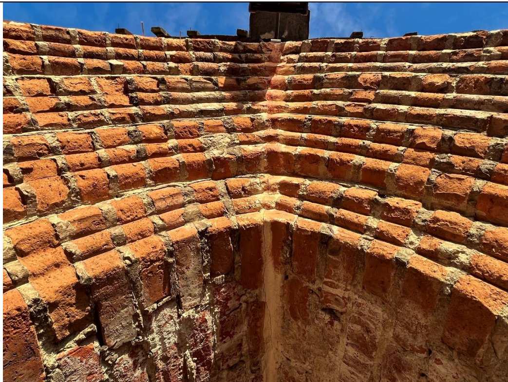
19. Kwietniewo; kościół paraf. pw. Podwyższenia Krzyża Świętego – wieża; elewacja zachodnia, odcinek środkowy (przyziemie). Ubytki zapraw, budulca, spękania w podłuczu portalu; uzupełnienia i obszerne zabrudzenia zaprawą wapienno-cementową.
