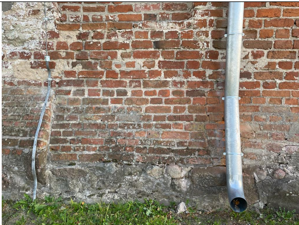
5. Kwietniewo; kościół paraf. pw. Podwyższenia Krzyża Świętego – korpus; elewacja północna, odcinek środkowy (przyziemie). Zawilgocenie, silne powierzchniowe zabrudzenia i nawarstwienia mikrobiologiczne w strefie cokołowej; obszerne przemurowania, uzupełnienia zaprawą cementową.
