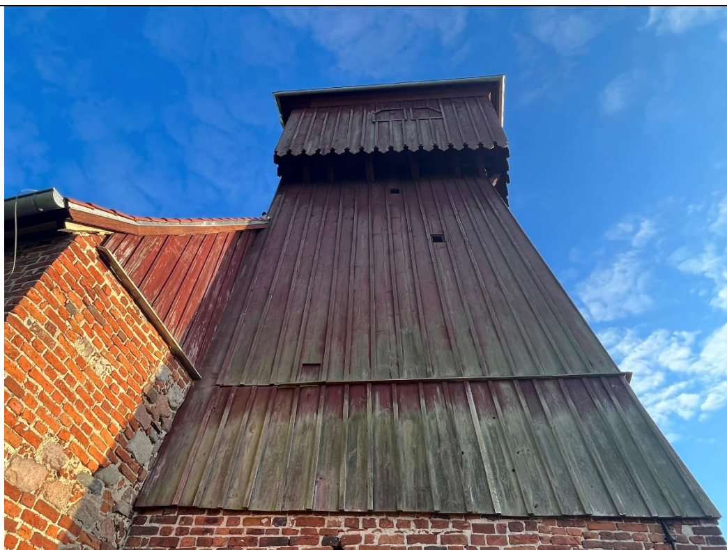
23. Kwietniewo; kościół paraf. pw. Podwyższenia Krzyża Świętego – wieża; elewacja północna (nadbudowa). Powierzchnia szalunku pokryta brązowo-bordową bejcą; ubytki powłoki ochronnej, zawilgocenie drewna, nalot z glonów; uszkodzenia gzymsu kapnikowego.
