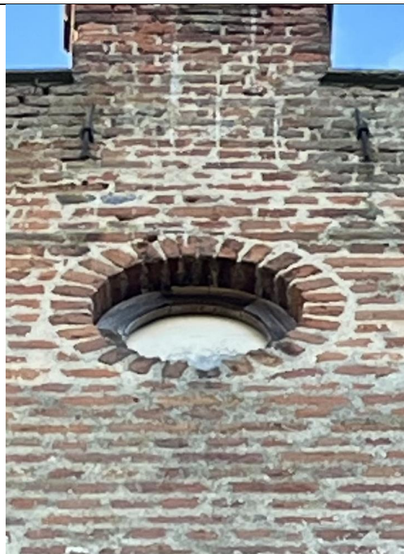
48. Kwietniewo; kościół paraf. pw. Podwyższenia Krzyża Świętego – korpus; szczyt wschodni, okno (awers). Uszkodzenia powłoki ochronnej, spękania drewna; skrzydło zaślepione płytą pilśniową.
