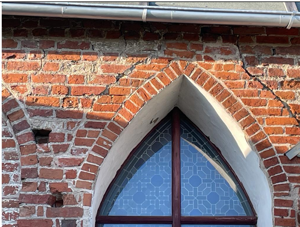
9. Kwietniewo; kościół paraf. pw. Podwyższenia Krzyża Świętego – korpus; elewacja południowa, odcinek środkowy (strefy środkowa i podokapowa). Spękania, ubytki zapraw w obrębie pierwotnych wątków ceglanych i historycznych przemurowań ościeży otworów okiennych.
