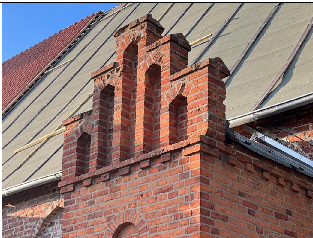
36. Kwietniewo; kościół paraf. pw. Podwyższenia Krzyża Świętego – przedsionek; elewacje południowa i wschodnia (strefy podokapowa, podszczytowa i szczyt). Ubytki budulca w okolicy gzymsu wieńczącego; odspojone fragmenty nakryw na stopniach szczytu.
