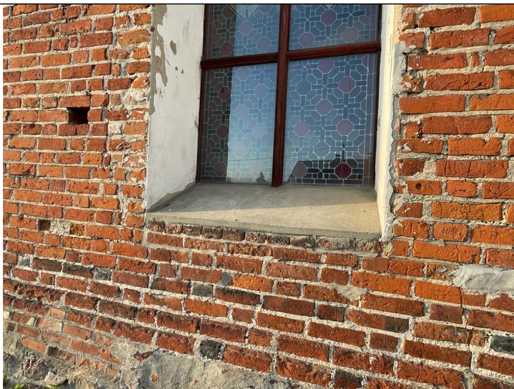
8. Kwietniewo; kościół paraf. pw. Podwyższenia Krzyża Świętego – korpus; elewacja południowa, odcinek środkowy (przyziemie i sreefa środkowa). Ościeża, parapet otworu okiennego pokryte zaprawą cementową; fragmenty pierwotnego wątku ceglanego z zachowanym kształtem spoinowań; na licu cegieł liczne, ryte znaki, gmerki, grafitta.
