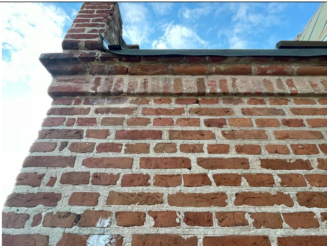
30. Kwietniewo; kościół paraf. pw. Podwyższenia Krzyża Świętego – kruchta boczna; elewacja wschodnia, odcinek południowy (przyziemie i strefa podokapowa). Lokalne spękania, ubytki budulca i spoinowań; pociemniałe, osłabione fragmenty gzymsu wieńczącego z reliktnymi wyprawami wapiennej.
