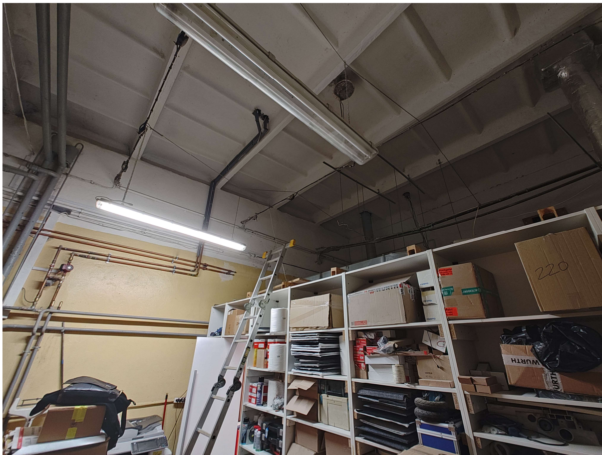
Zdjęcie 6. Pomieszczenie techniczne hali przylegające do pomieszczenia serwerowni
