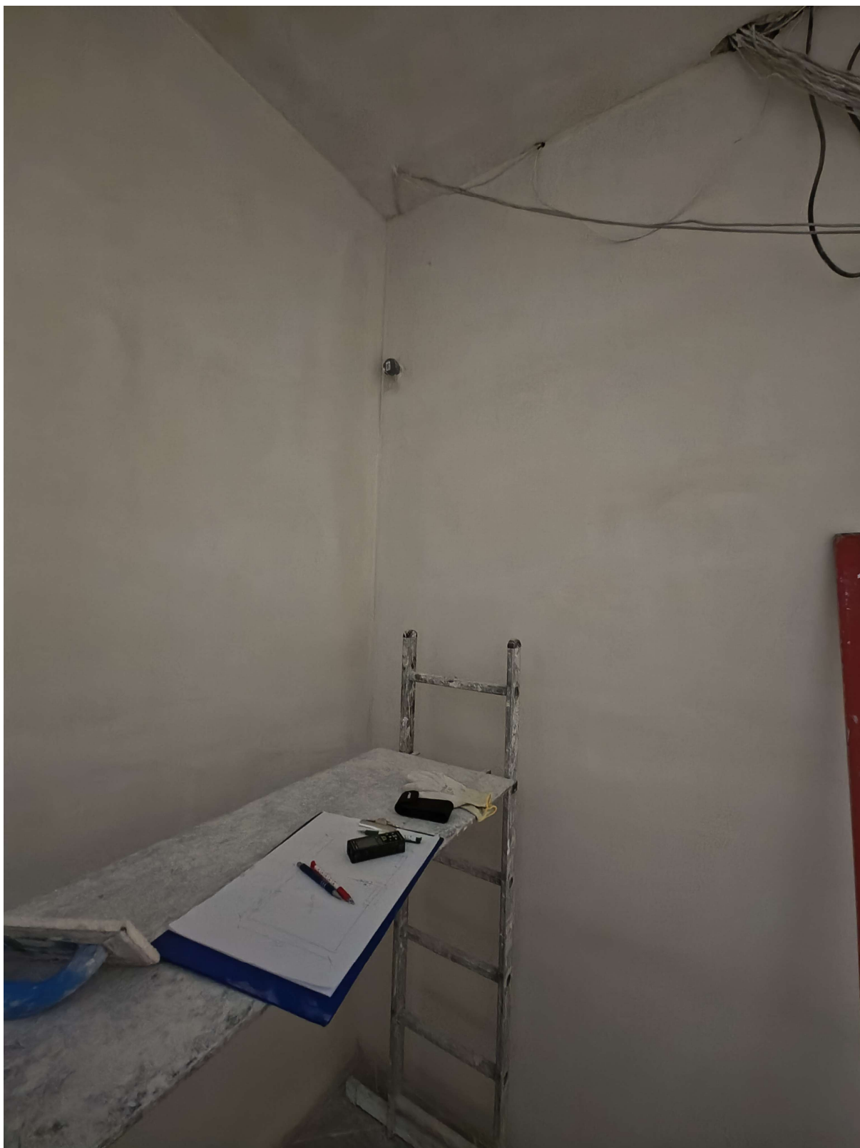
Zdjęcie 10. Odejście trójnikowe z istniejącego pionu kanalizacji sanitarnej w pomieszczeniu technicznym przez ścianę do pomieszczenia serwerowni
