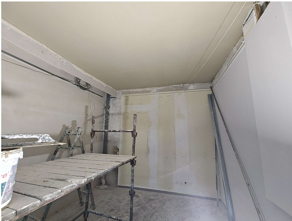
Zdjęcie 3. Pomieszczenie techniczne przylegające do projektowanej serwerowni
