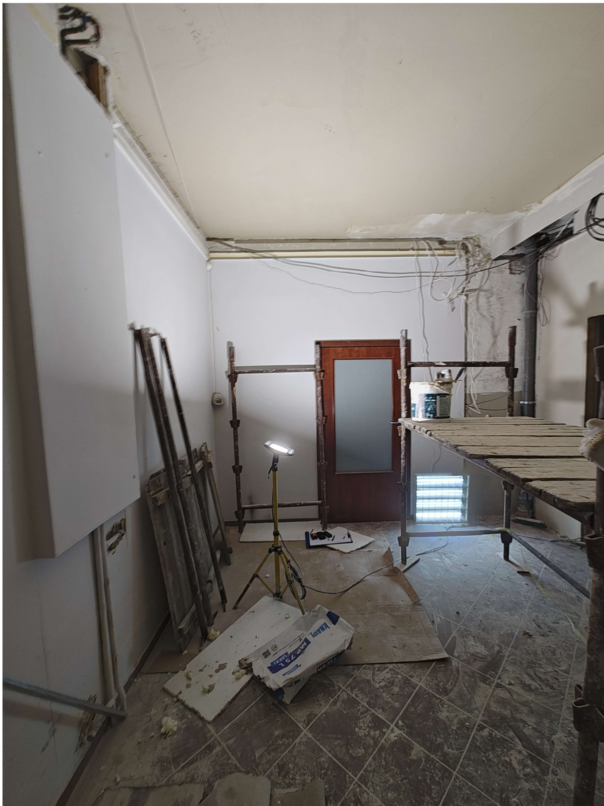
Zdjęcie 4. Pomieszczenie techniczne przylegające do projektowanej serwerowni
