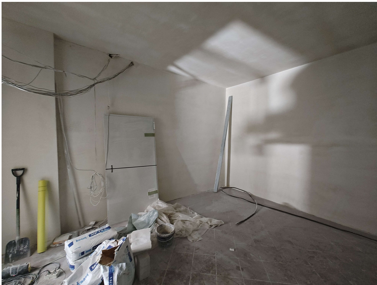
Zdjęcie 2. Pomieszczenie projektowanej serwerowni
