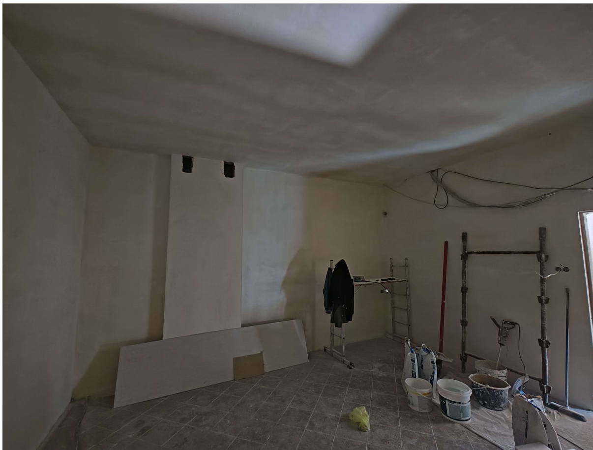
Zdjęcie 1. Pomieszczenie projektowanej serwerowni
