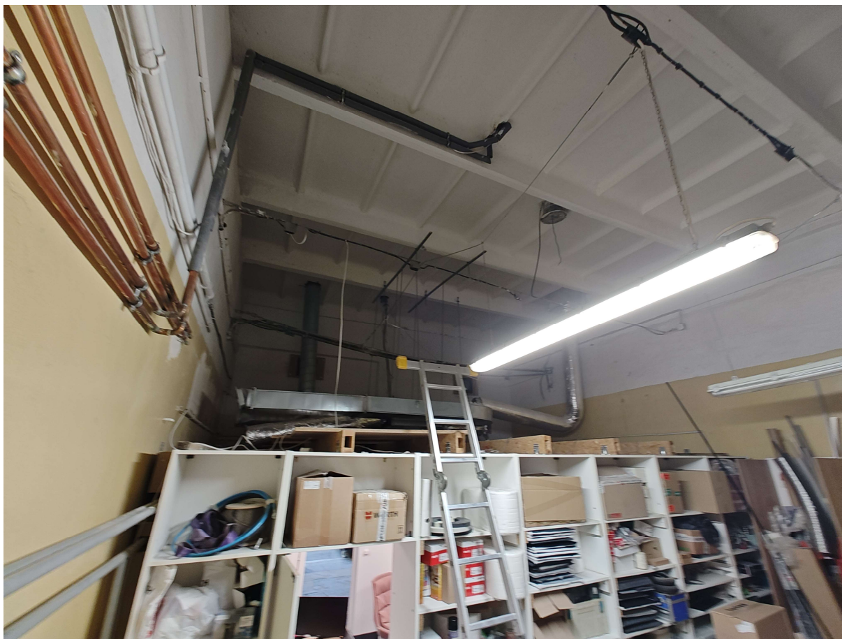
Zdjęcie 5. Pomieszczenie techniczne hali przylegające do pomieszczenia serwerowni
