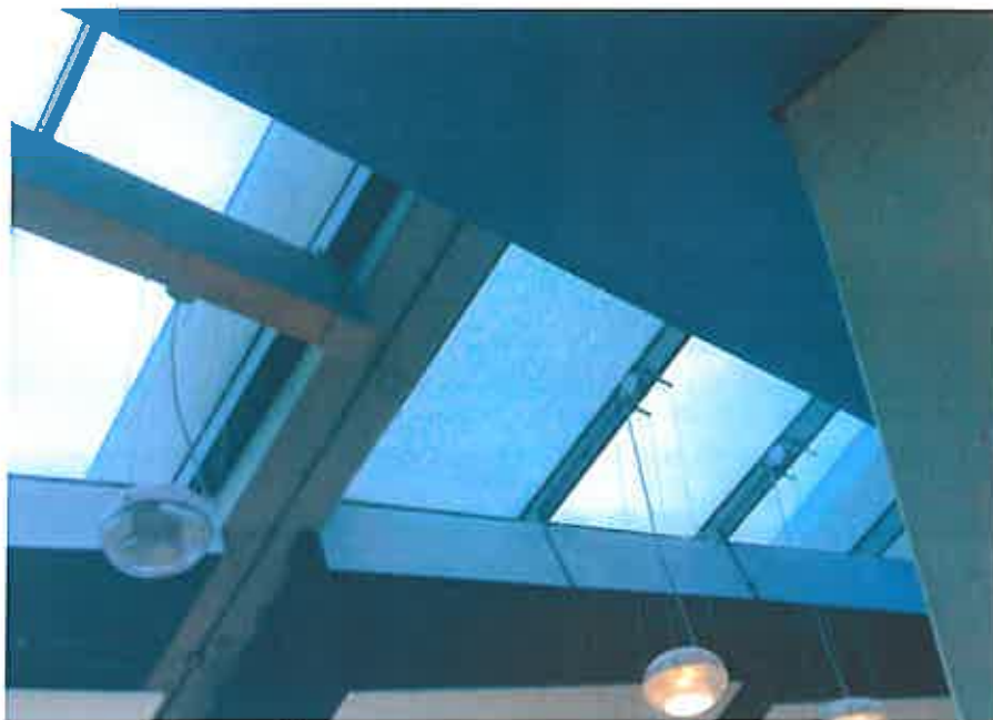
Zdjęcie nr 2. Pęknięta szyba świetlika fasady frontowej
