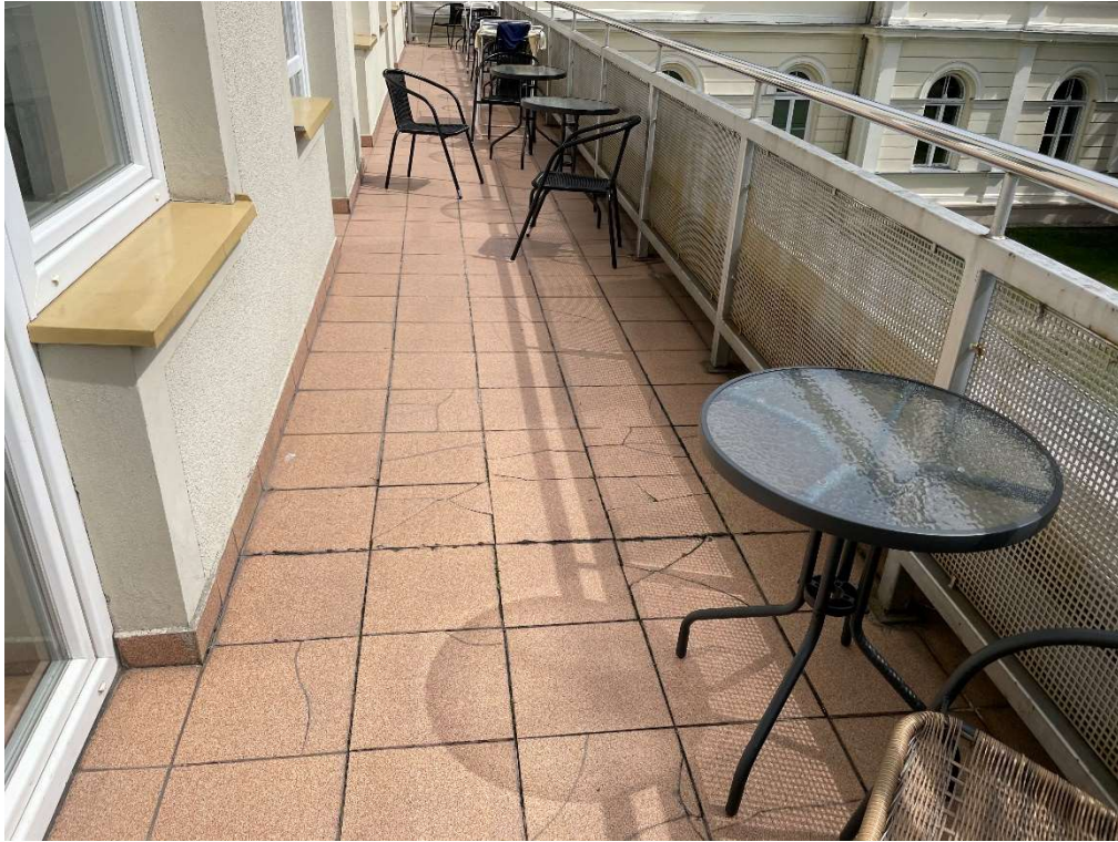
Fot 2. Widok tarasu. Wskutek złej izolacji i przemarzania płytki odpadają, są popękane; stanowią zagrożenie dla kuracjuszy.
