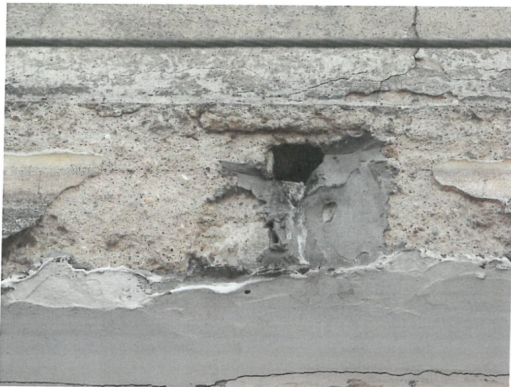
Fot. 2 Nisza gniazdowa wróbla w szczelinie na ścianie frontowej.
