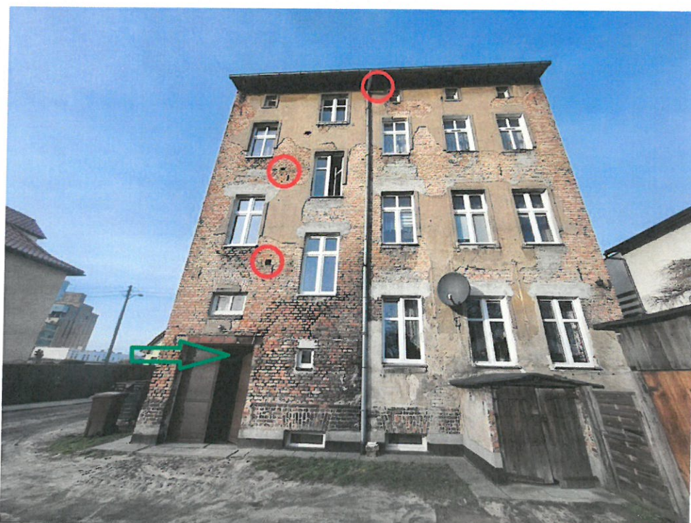
Fot. 3 Widok ściany tylnej budynku z zaznaczonymi na czerwono stwierdzonymi niszami gniazdowymi wróbla i zaznaczoną zieloną strzałką lokalizację gniazda kopciuszka na klatce schodowej.
