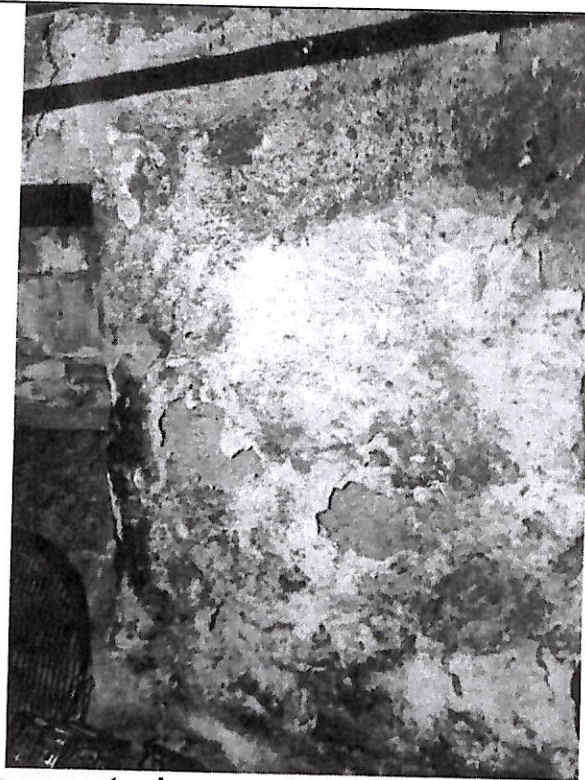
Zawilgocony tynk w pomieszczeniach piwnicznych
