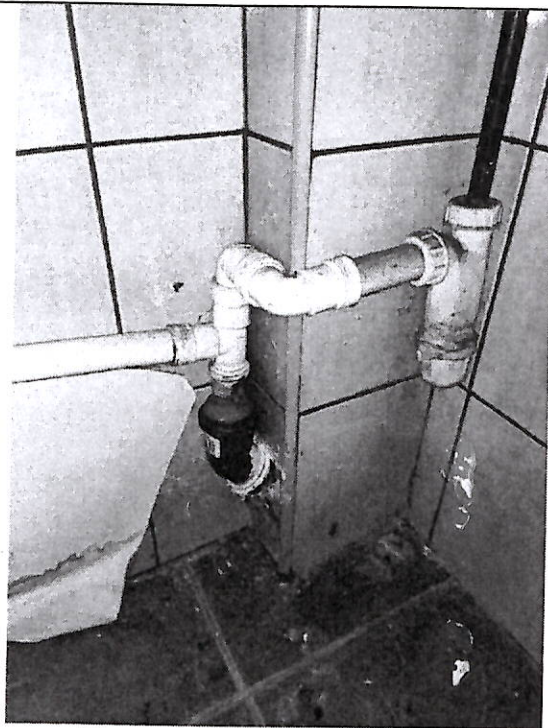
Nieprawidłowy montaż rur
