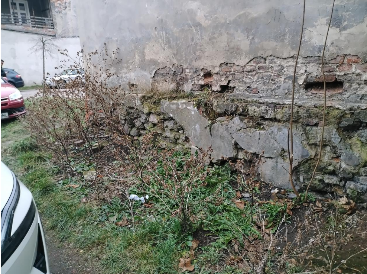
ubytki betonu, cegieł i kamienia na ścianie cokołowej lewego szczytu
