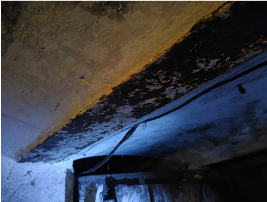
korozja dolnych stopek belek stalowych stropu odcinkowego
