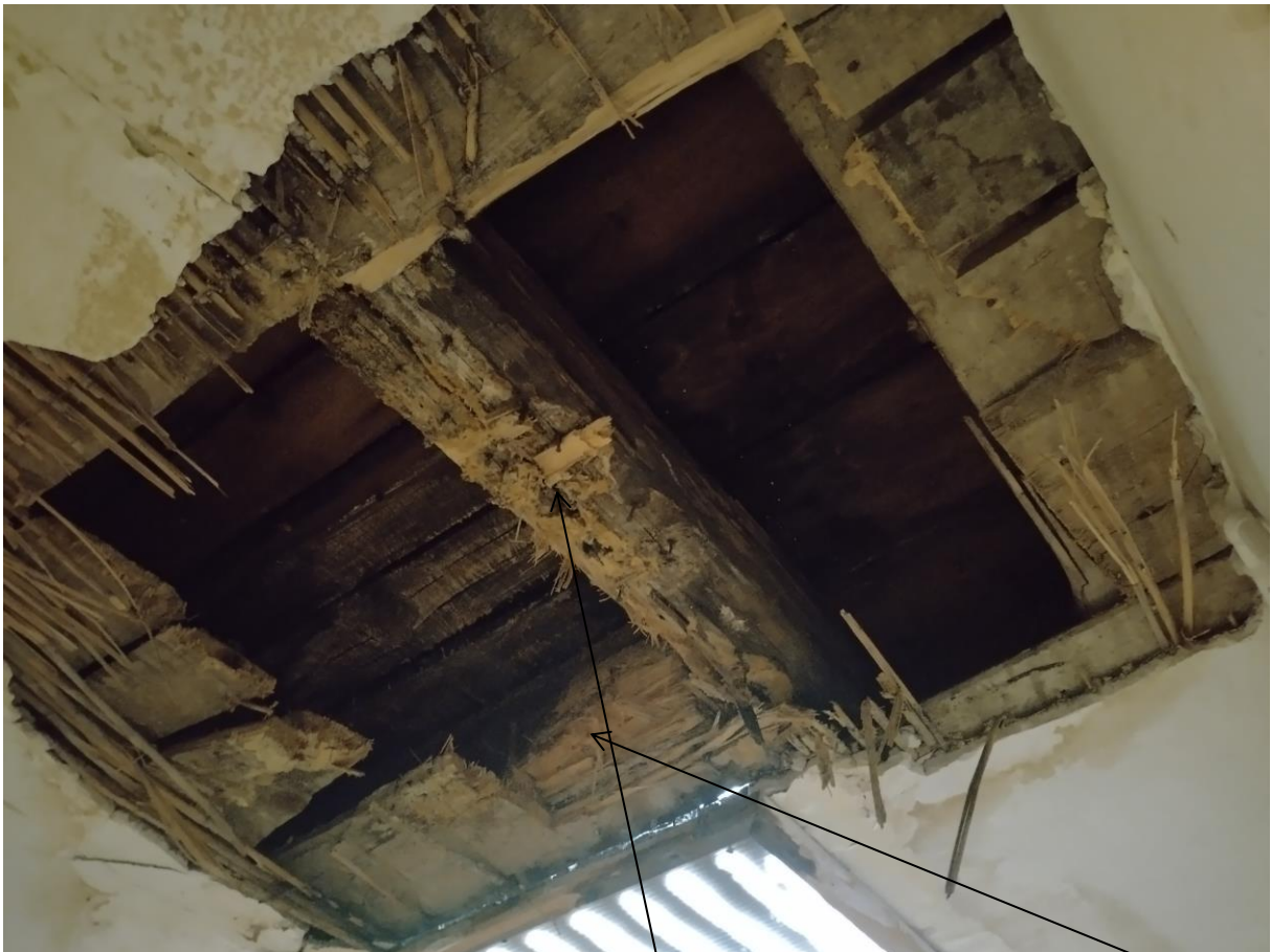
na zdjęciu widoczna uszkodzona belka podłużna oraz całkowicie zniszczona belka wymianu
