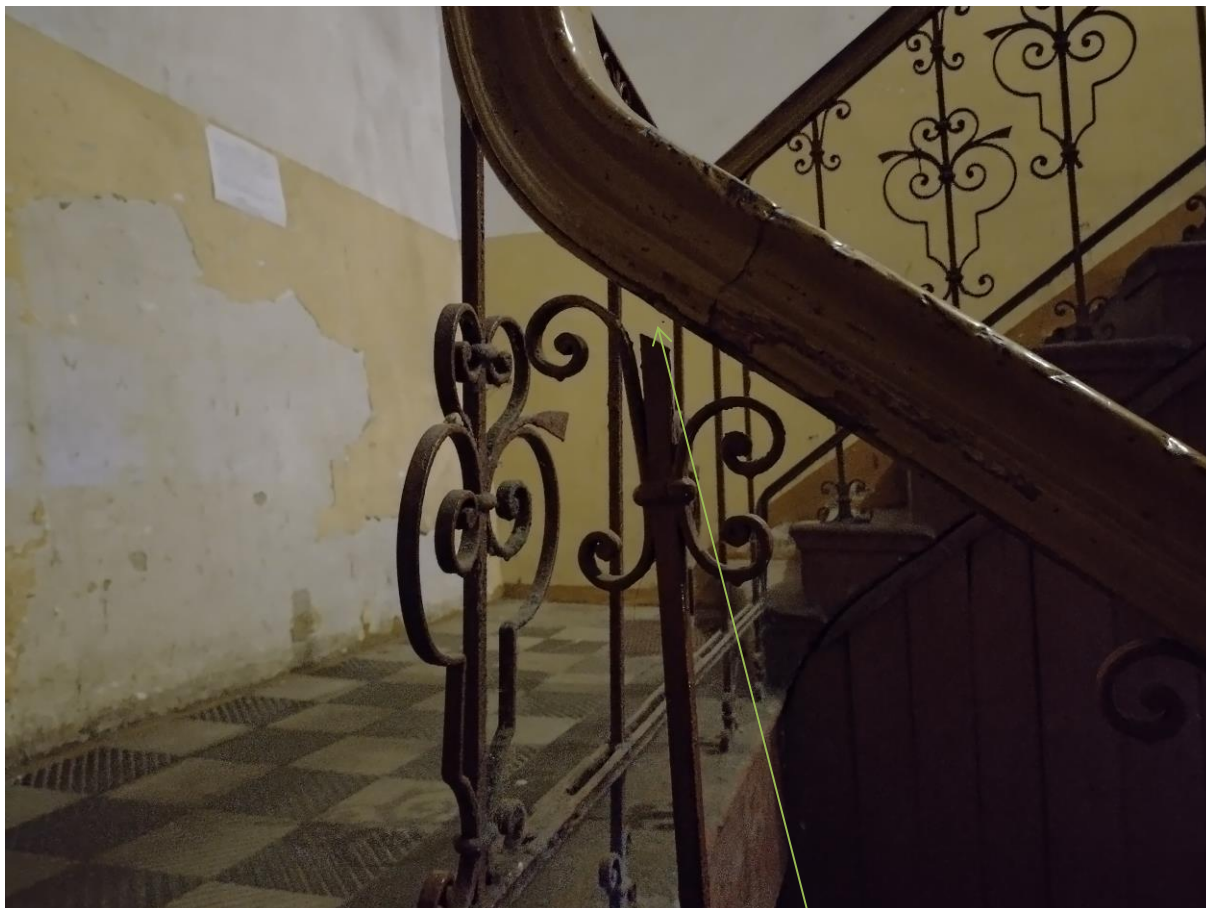
uszkodzone mocowanie tralki do płaskownika pochwyty
