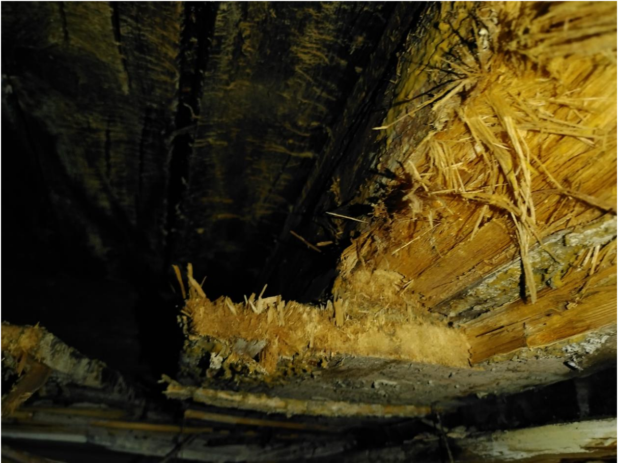
całkowicie zniszczona belka drewnianego wymianu przy świetliku dachowym
