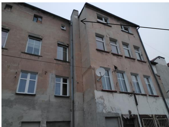
spękanie pionowe ściany kominowej
