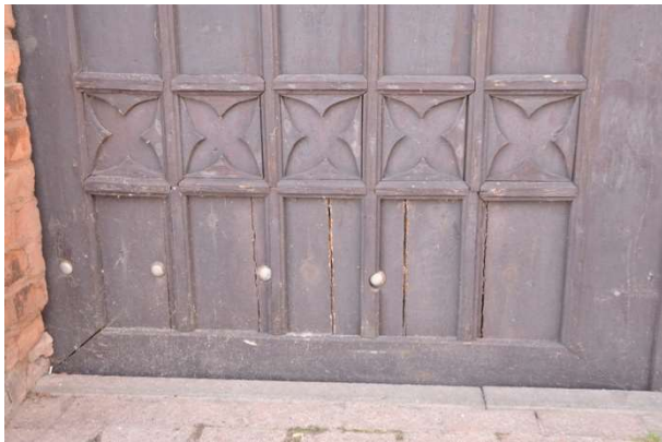
Fot. 23. Dolne partie konstrukcji wrót, aktualny stan zachowania. Widoczne rozszczelnienie w konstrukcji obicia
