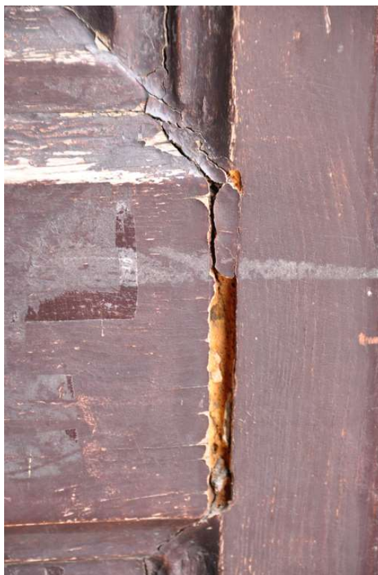
Fot. 9. Zbliżenie na element konstrukcji ramy skrzydła drzwi, widoczne silne rozszczelnienie łączenia listw ramy oraz wtórne ich wypełnienie pianką poliuretanową i szpachlówką.
