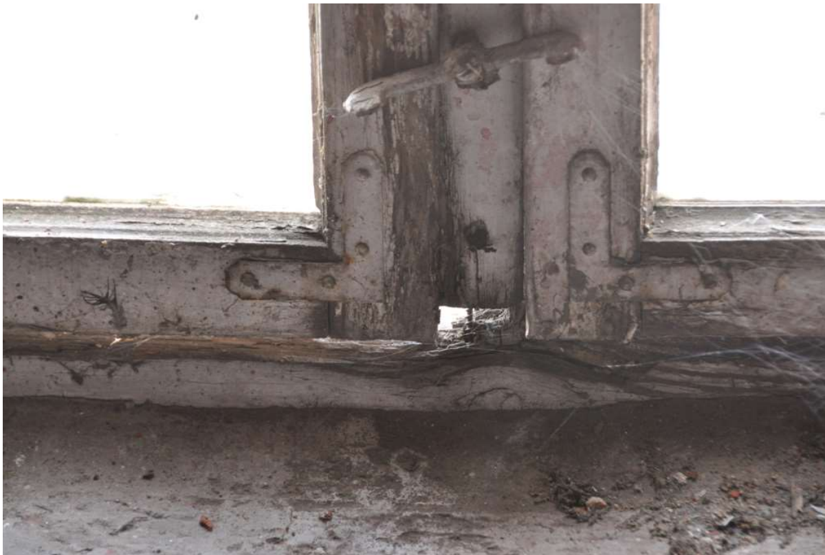
Fot. 35. Dolne partie okna w obrębie elewacji północno-zachodniej, aktualny stan zachowania. Widoczne rozszczelnienie konstrukcji oraz silny rozkład drewna.
