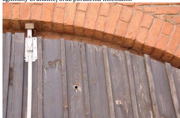
Fot. 29. Zasuwa pionowa – aktualny stan zachowania
