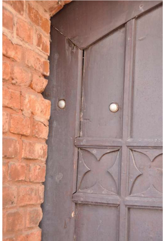
Fot. 24. Górny narożnik lewego skrzydła, aktualny stan zachowania. Widoczne rozszczelnienia na styku elementów oraz ślady rozkładu drewna
