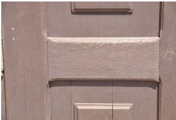
Fot. 18. Konstrukcja drzwi, widoczne m.in. spękania płycin oraz błędnie wykonany profil prawej listwy ramy skrzydła
