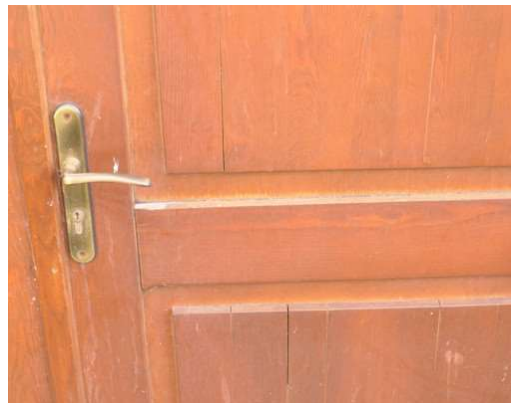
Fot. 21. Zbliżenie na konstrukcję skrzydła, widoczne m.in. spękania w obrębie płyciny
