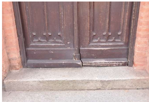
Fot.2. Dolne partie drzwi z widoczną wtórną konstrukcją listw okapnikowych
