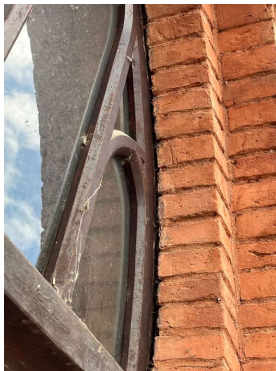
Fot. 5 Styk konstrukcji nadświetla z portalem – aktualny stan zachowania
