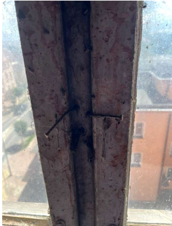
Fot. 34. Okno w obrębie elewacji południowo-wschodniej, widoczne wtórne zabezpieczenie skrzydeł.
