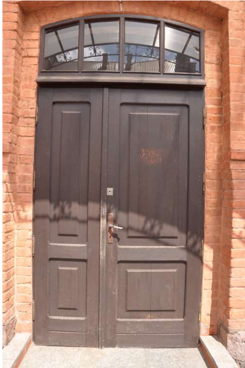
Fot. 16. Wtórna konstrukcja stolarki drzwiowej - wejście od obiektu od strony dziedzińca – aktualny stan zachowania.
