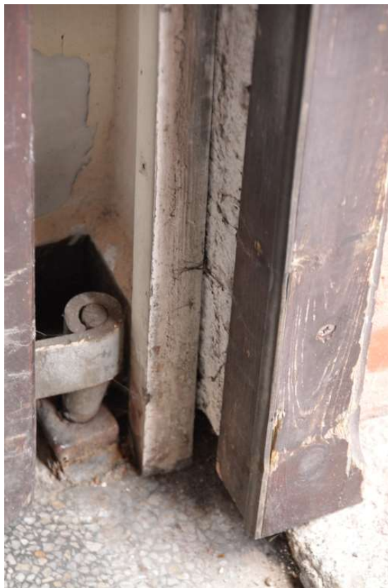
Fot. 7. Dolne partie konstrukcji z widoczną wtórną belką ościeża oraz – od wewnątrz – dodatkową listwą doszczelniającą skrzydła drzwi.
