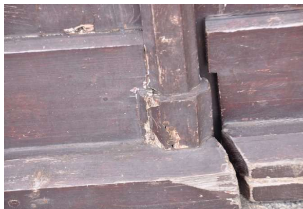
Fot. 3. Zbliżenie na styk skrzydeł w dolnych partiach drzwi – aktualny stan zachowania. Widoczne wtórne listwy okapnikowe oraz zniszczenia pierwotnej konstrukcji listwy domykowej
