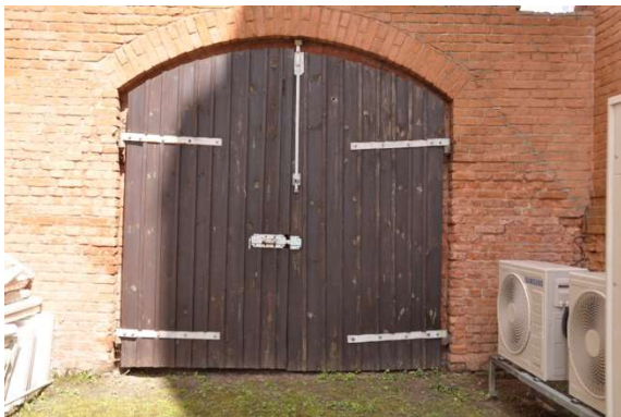
Fot. 26. Wrota bramy – widok od dziedzińca- aktualny stan zachowania. Widoczna wyraźna różnica w wysokości skrzydeł, wynikająca ze złego stanu konstrukcji
