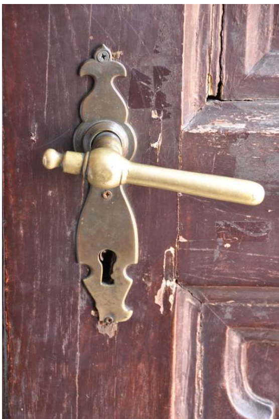
Fot. 8. Zewnętrzna klamka drzwi, aktualny stan zachowania. Widoczny ubytek zwieńczenia szyldu
