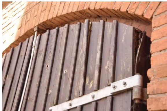
Fot. 27. Zbliżenie na lewe skrzydło wrót, widoczne odspojenia wtórnego obicia oraz ślady zniszczeni konstrukcji pierwotnej ramy wynikające z rozkładu drewna przez grzyby zgnilizny brunatnej oraz porażenia insektami.
