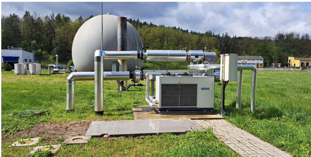
Zdjęcie nr 1 Instalacja osuszania biogazu oraz płyta betonowa pod filtry.
