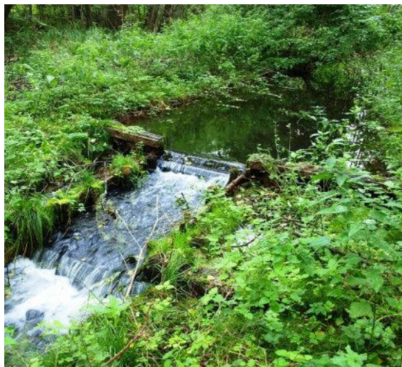
Próg z dwiema ściankami szczelnymi, ubezpieczony palisadą boczną, przelew pomiędzy ściankami, brak ubezpieczenia progu dolnego od strony wody dolnej. Fot. Z. Filipek. Źródło: Archiwum CKPS.
