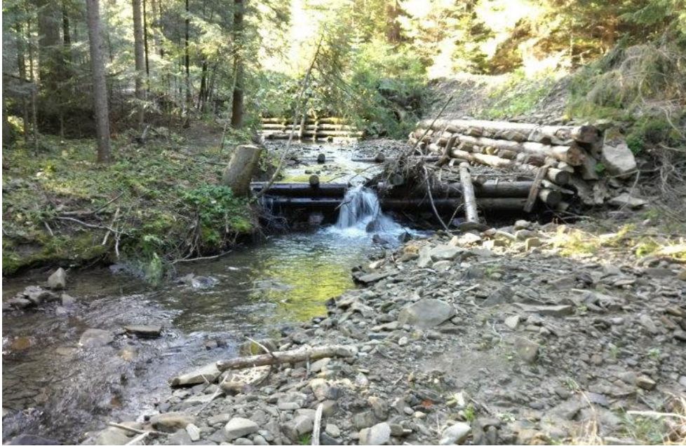
Podmyty próg w rok po wybudowaniu. Brak zamknięcia niecki wypadowej stabilizującego dno. Źródło. Archiwum fotograficzne CKPŚ.
