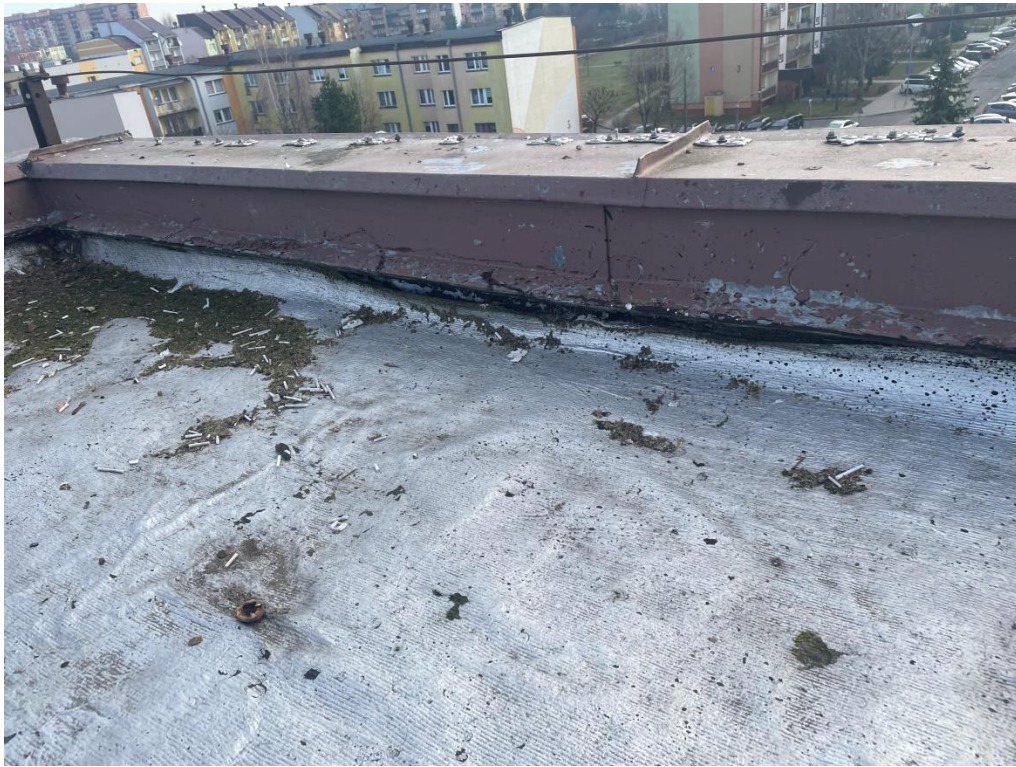
Odspojenie papy od ściany
