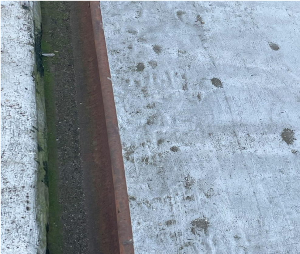
Skorodowane rynny dachowe
