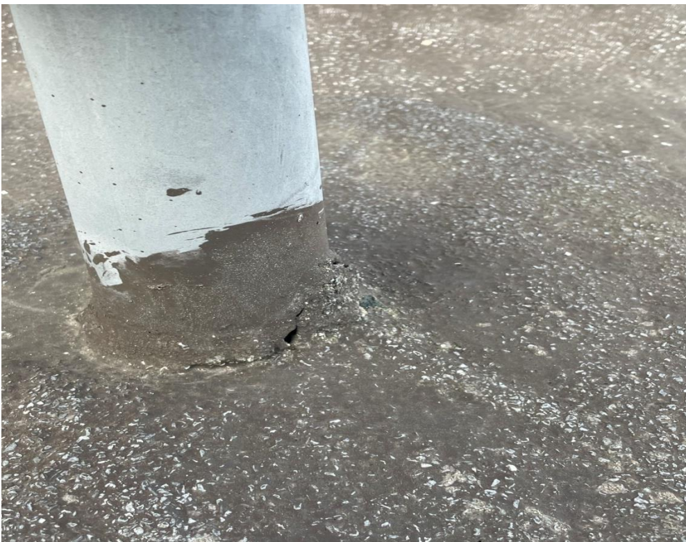
Nieszczelność przy wywietrzaku
