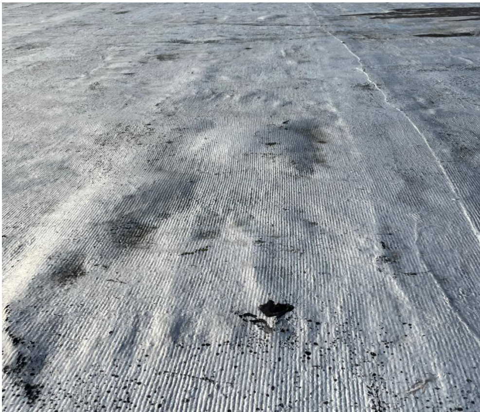
Widoczne pęcherze na poszyciu z papy.
