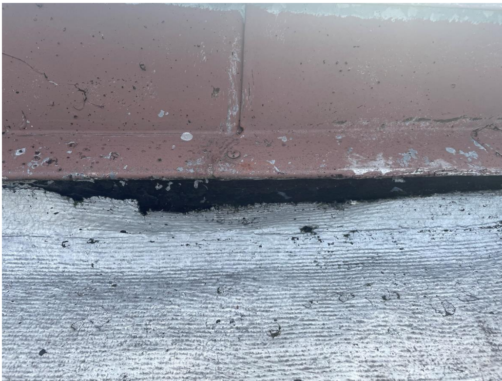
Odspojenie papy od ściany
