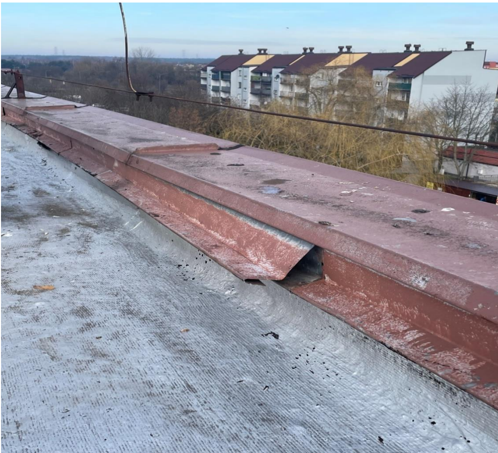
Obróbki blacharskie odspajają się od ściany.
