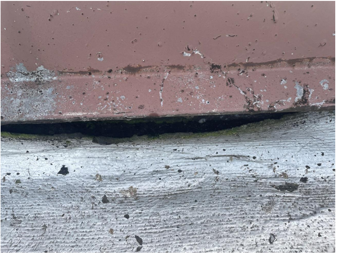
Odspojenie papy od ściany
