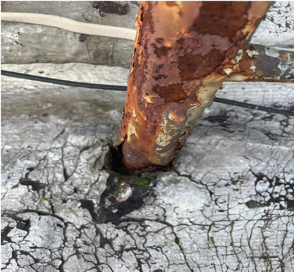
Widoczne skorodowane wywietrzaki oraz duże nieszczelności w poszyciu
