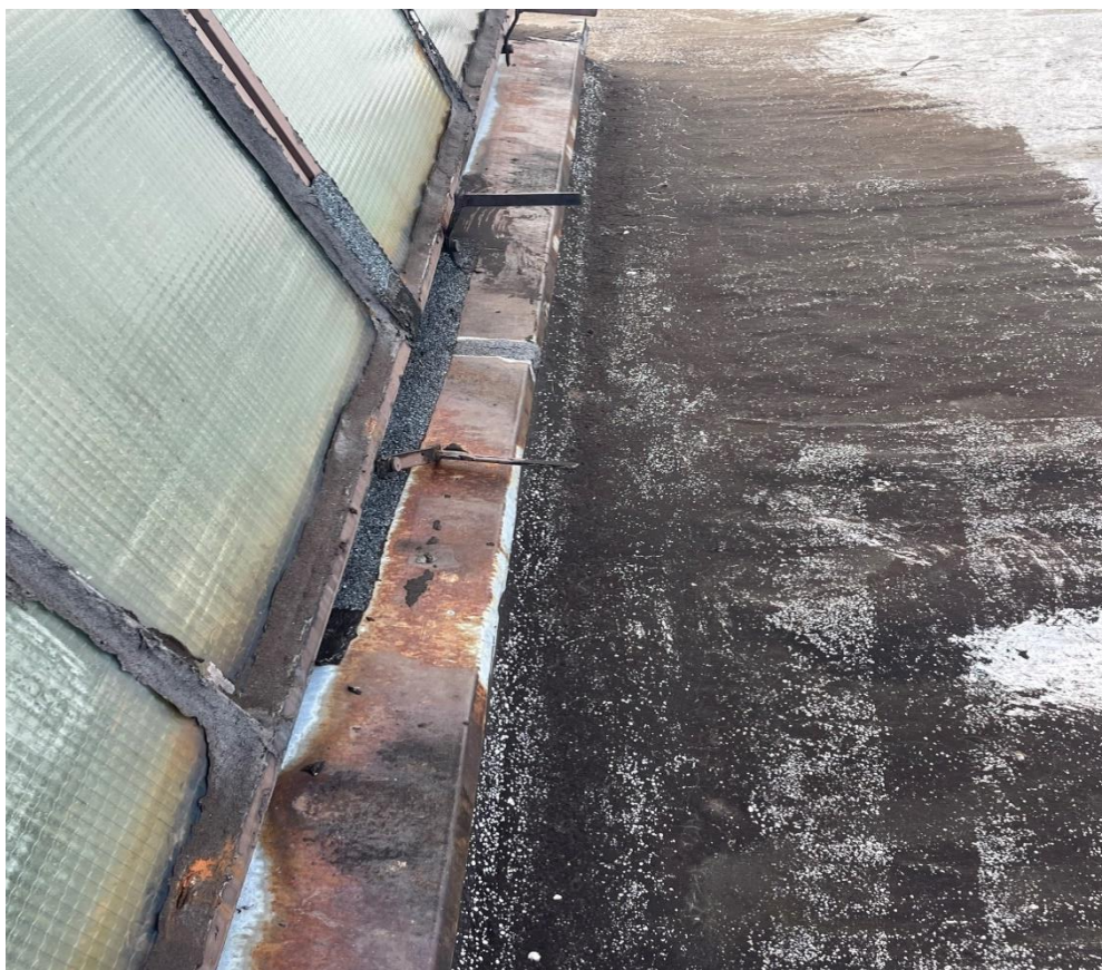
Skorodowane obróbki blacharskie
