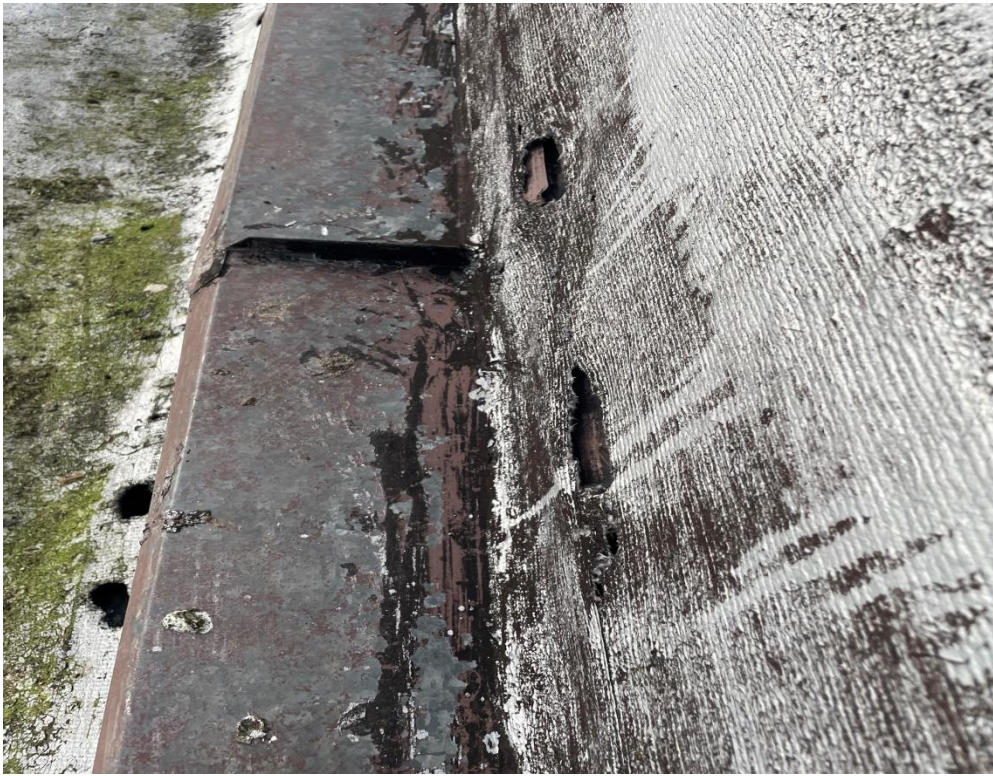
Skorodowane obróbki blacharskie i widoczne nieszczelności w poszyciu na ścianie oraz na dachu.
