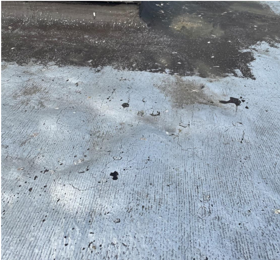
Widoczne pęcherze na poszyciu z papy.
