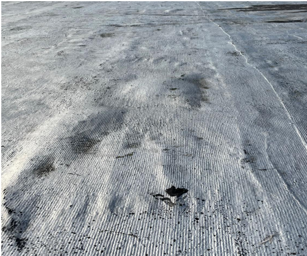
Widoczne pęcherze na poszyciu z papy.
