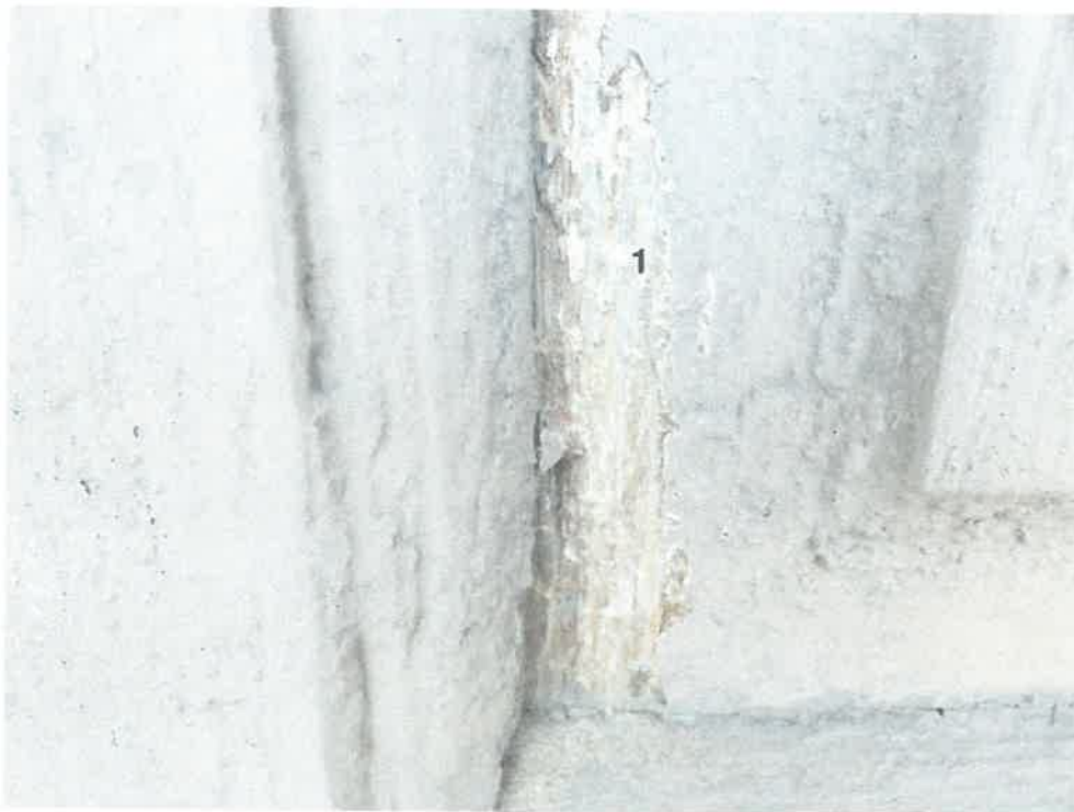
Odkrywka w obrębie stolarki drzwiowej odsłaniająca pozostałości zielono-szarych powłok malarskich (1).
