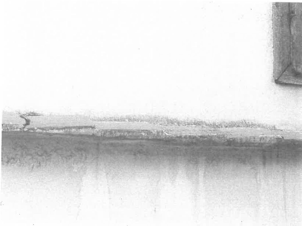
Fot. 14 Dachówka na gzymsie w obrębie elewacji szczytowej, południowej.
