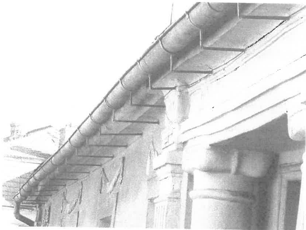
Fot. 5 Niewłaściwy, szpecący elewację system mocowania rynny, na hakach.
