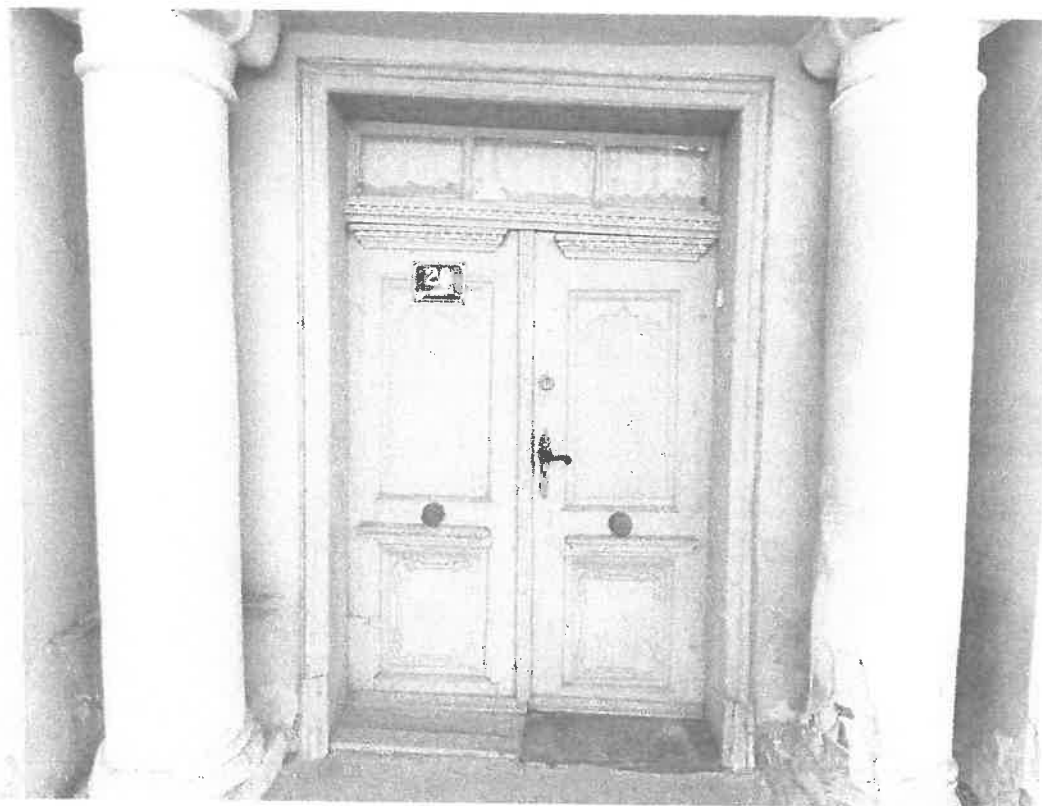
Fot. 10 Zabytkowa stolarka drzwiowa w elewacji frontowej. Widoczne skrzywienie drzwi.
