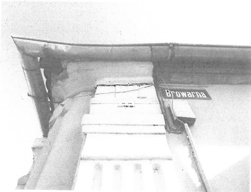
Fot. 7 Zbliżenie na ubytek w obrębie gzymsu koronującego oraz drewniany gzyms od strony ul. Browarnej. Widoczne przewody na elewacji.
