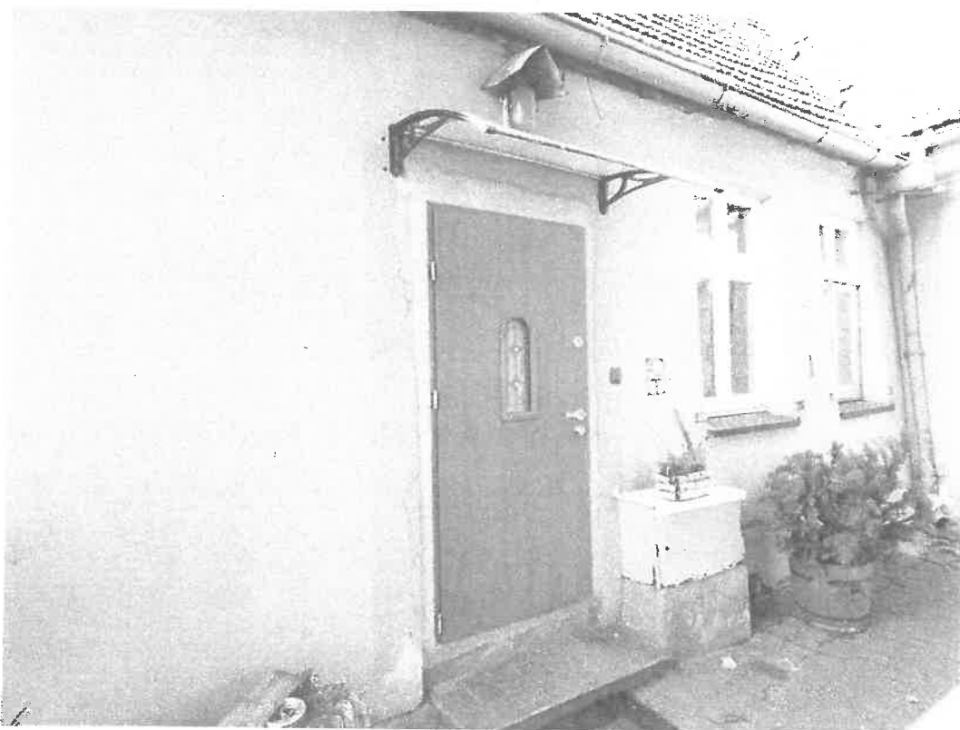
Fot. 12 Współczesne, niepasujące do obiektu drzwi i daszek w elewacji tylnej, wschodniej.
