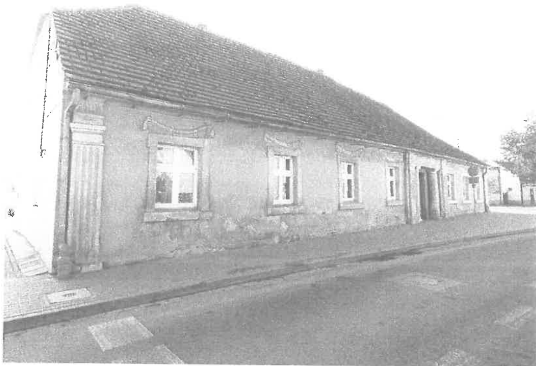
Fot. 1 Elewacja frontowa, zwrócona na ul. Rybaki. Widoczne silne zawilgocenie tynów w dolnych partiach.
