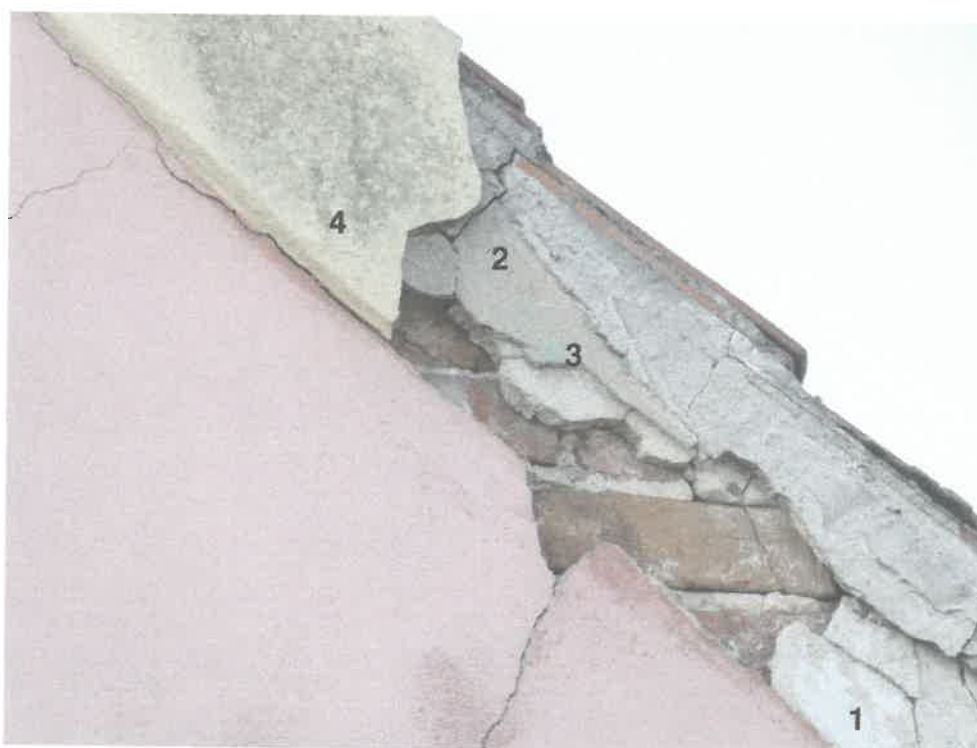
Naturalna odkrywka w obrębie elewacji szczytowej, wschodniej. Widoczne pod reprofiliacją z żółtą powłoką (4), powłoki pomarańczowe (2) i zielone (3). Na dole na zaprawie leżącej bezpośrednio na cegle szare powłoki malarskie zbliżona do koloru S 168 z wzornika Keim Naturstein (1).
