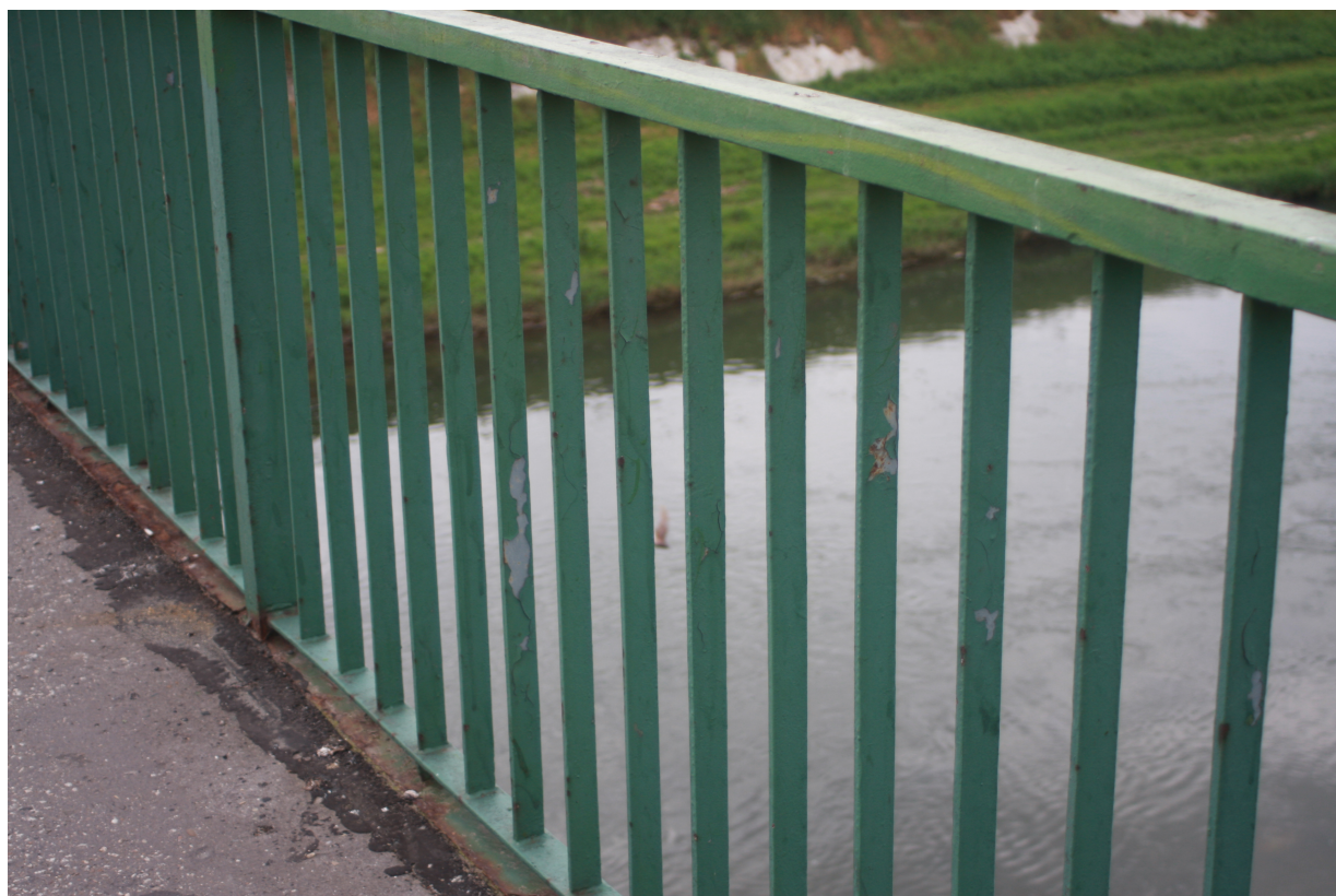
Fot. 20. Stan balustrad
