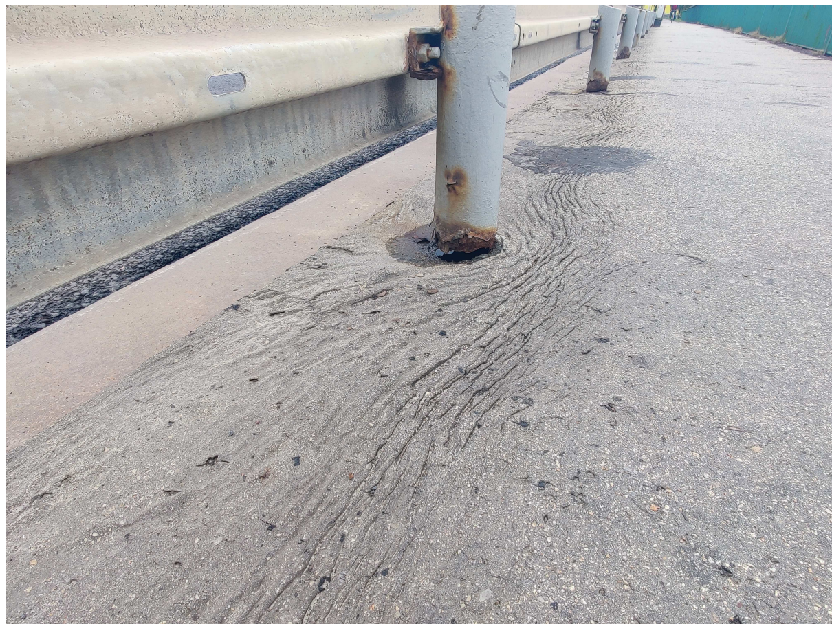
Fot. 16. Słupki barier energochłonnych (słupek zniszczony przez korozję)
