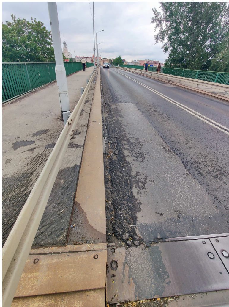
Fot. 21. Stan nawierzchni jezdni na moście.
