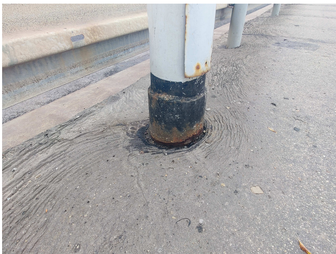
Fot. 18. Korozja latarni oświetleniowej
