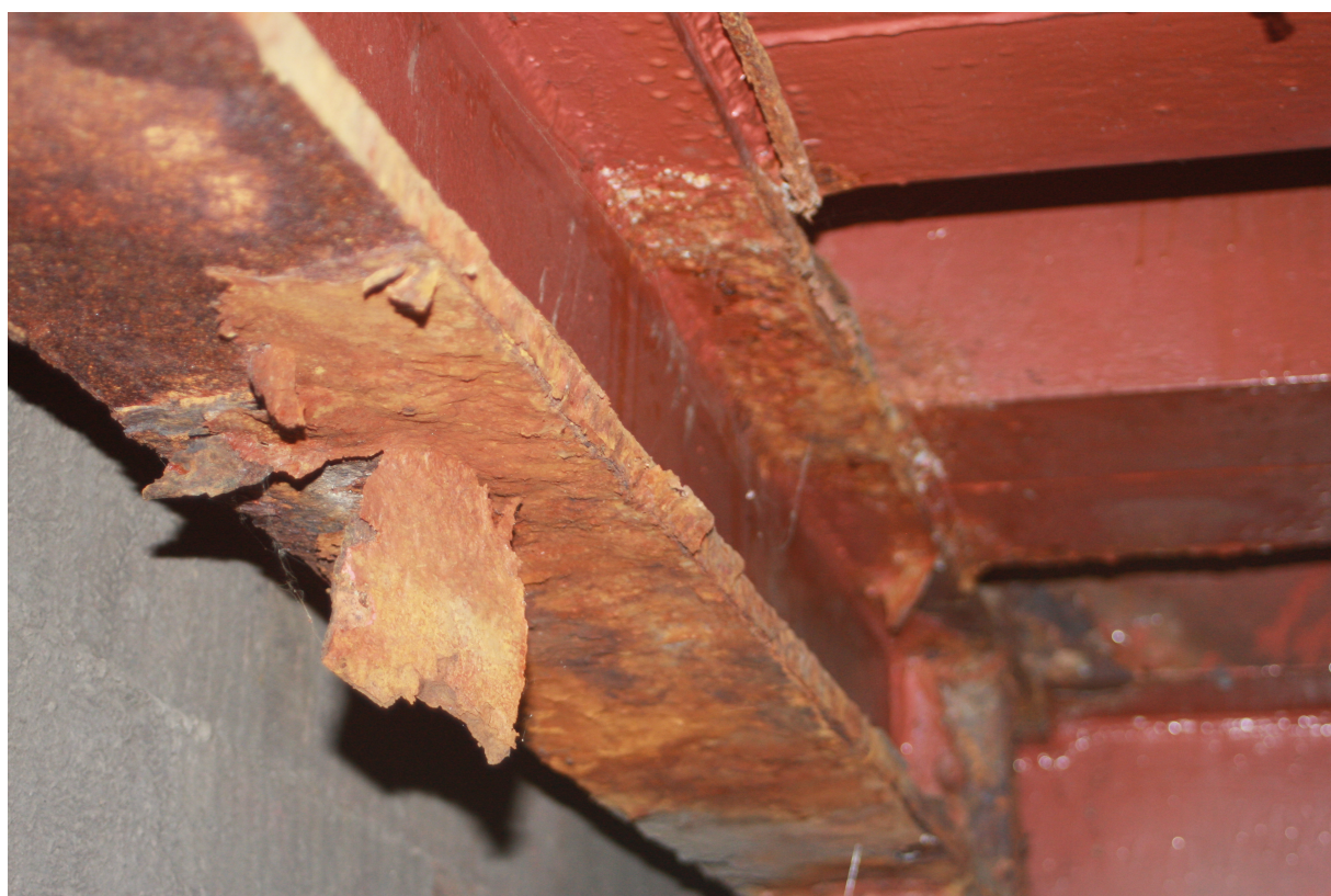
Fot. 61. Korozja poprzecznicy przy dylatacji
