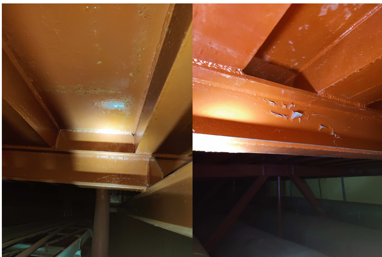
Fot. 58/59 Lokalne ubytki i złuszczenia powłoki malarskiej
