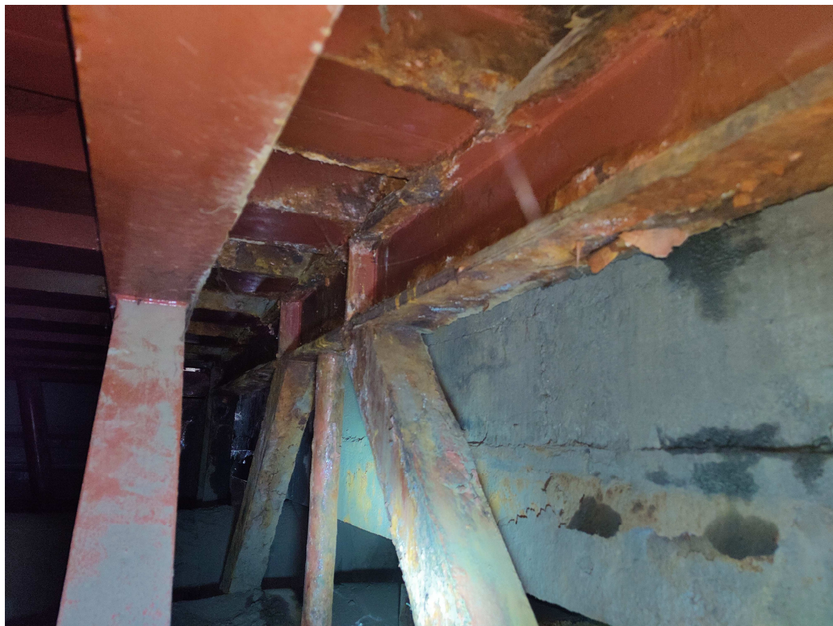
Fot. 54. Korozja elementów poprzecznicy.
