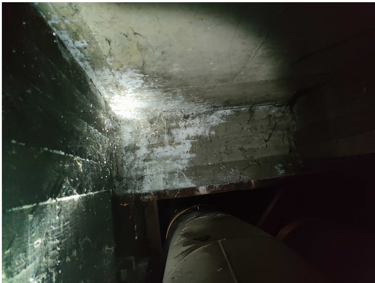
Fot. 50. Korozja betonu przyczółków – nieskuteczna izolacja przyczółka.
