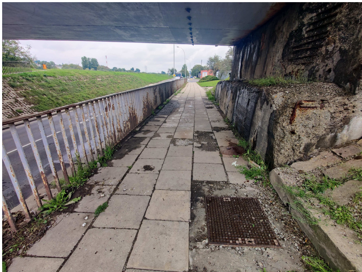
Fot. 67. Stan chodników w obrębie mostu
