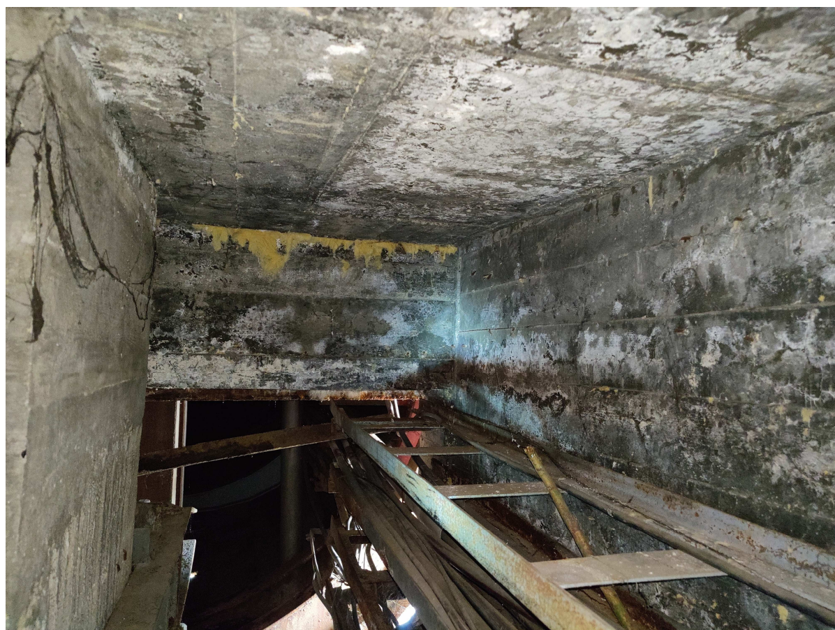
Fot. 51 Korozja betonu przyczółków – nieskuteczna izolacja przyczółka
