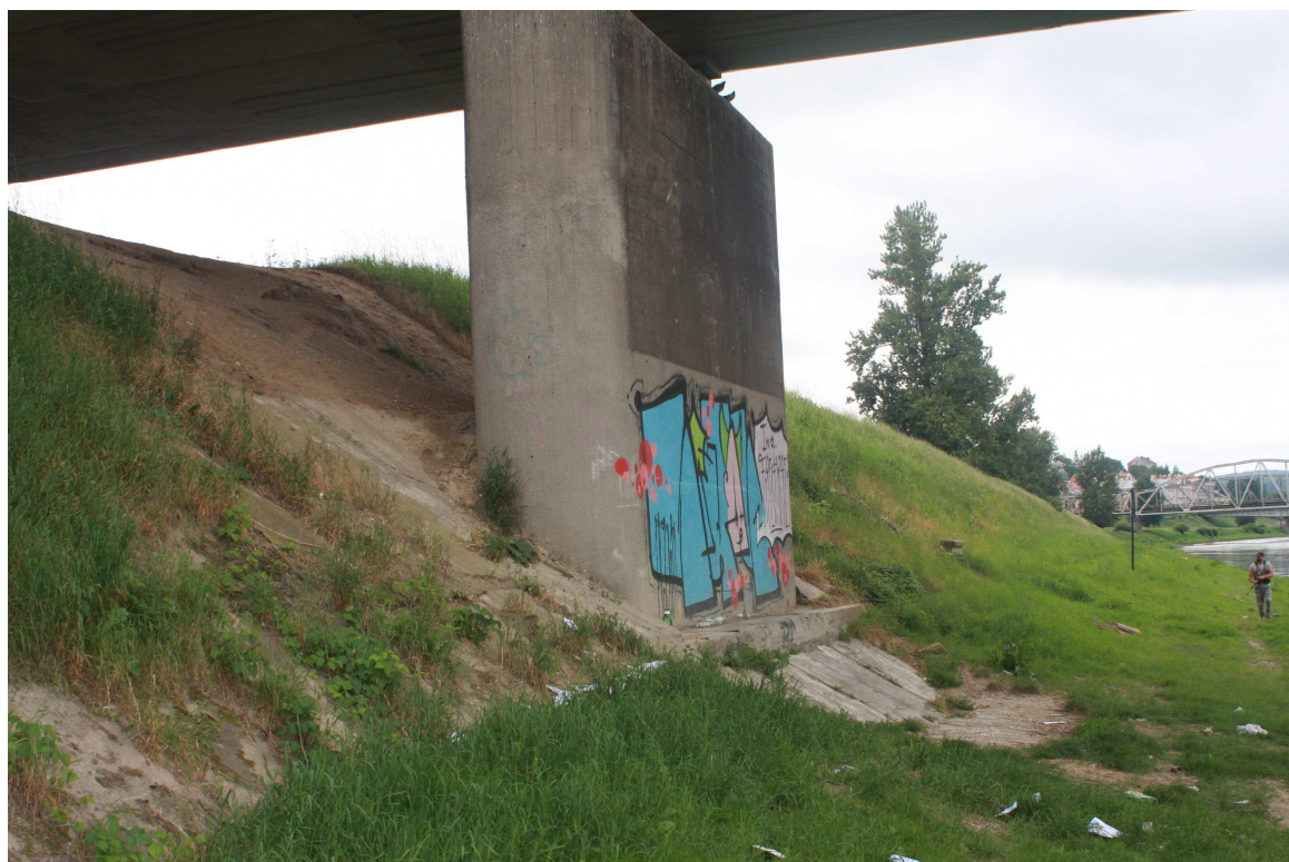
Fot. 38 Filar od strony ul. Borelowskiego.
