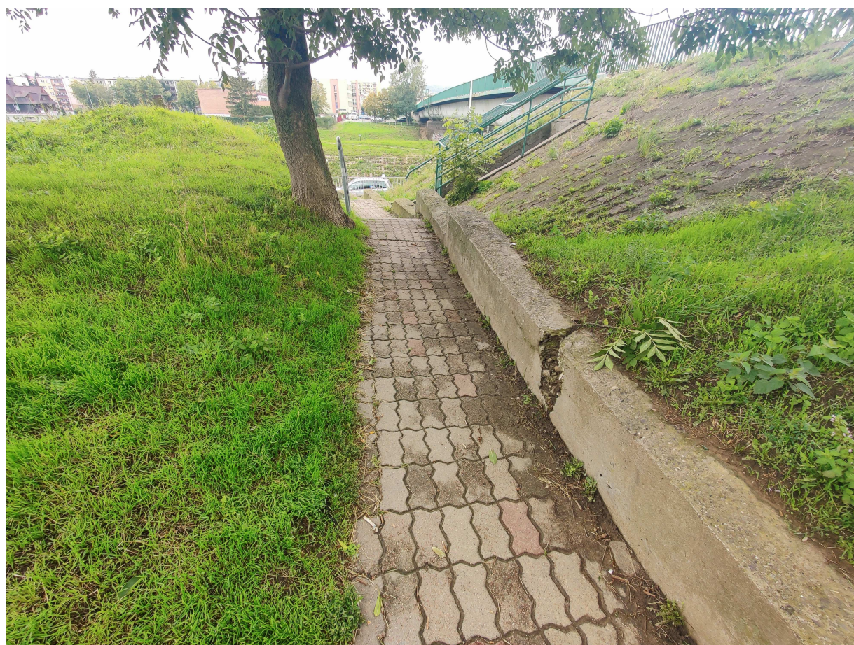
Fot. 66. Stan chodników w obrębie mostu
