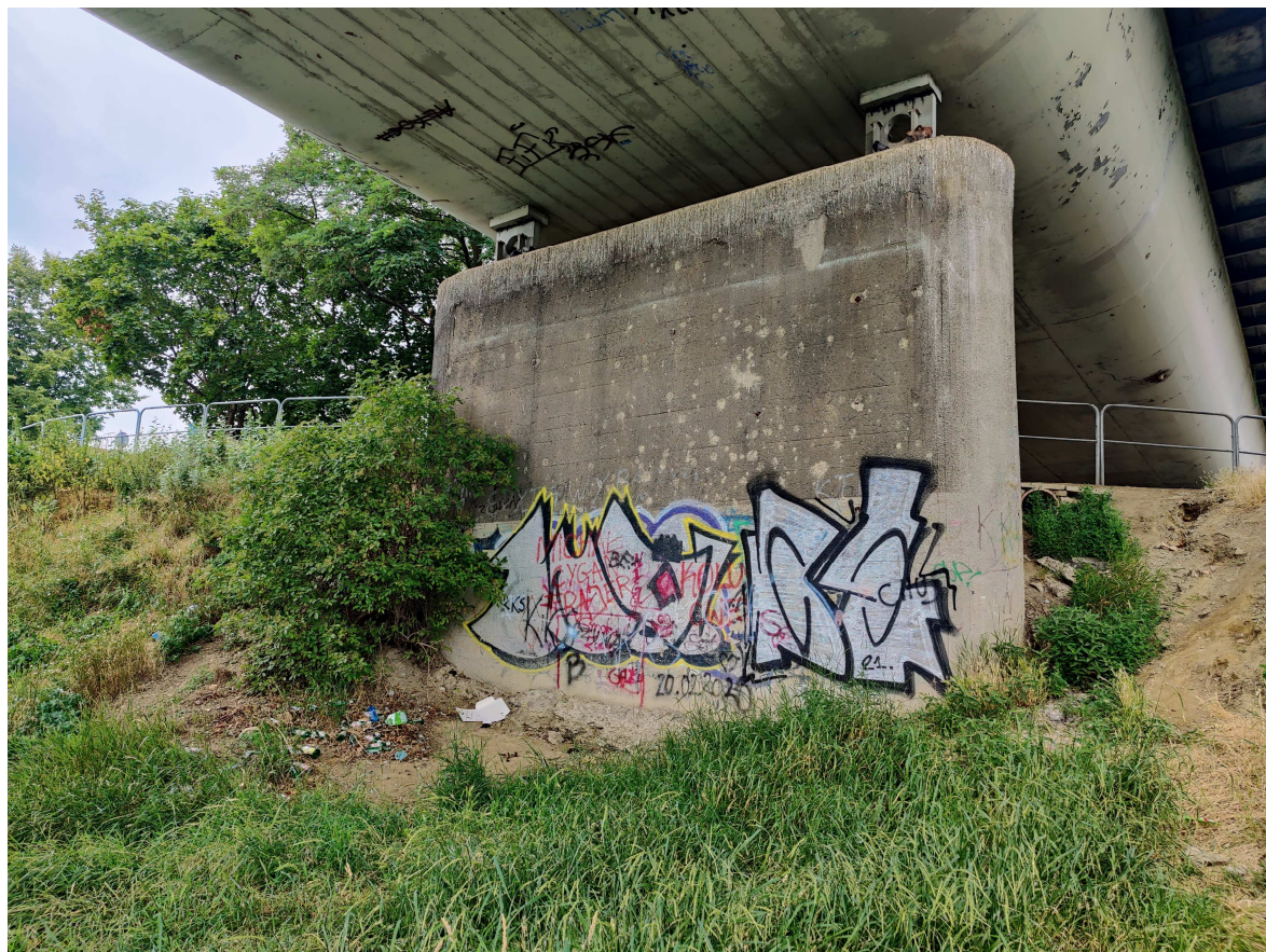
Fot. 36 Filar od strony ul. Borelowskiego.
