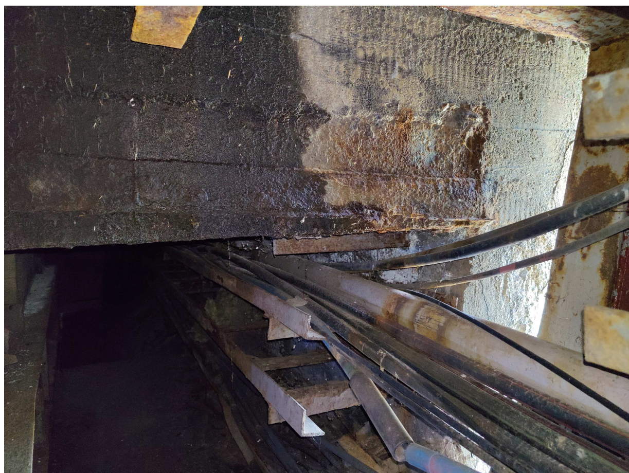
Fot. 53 Korozja betonu przyczółków – nieszczelna dylatacja
