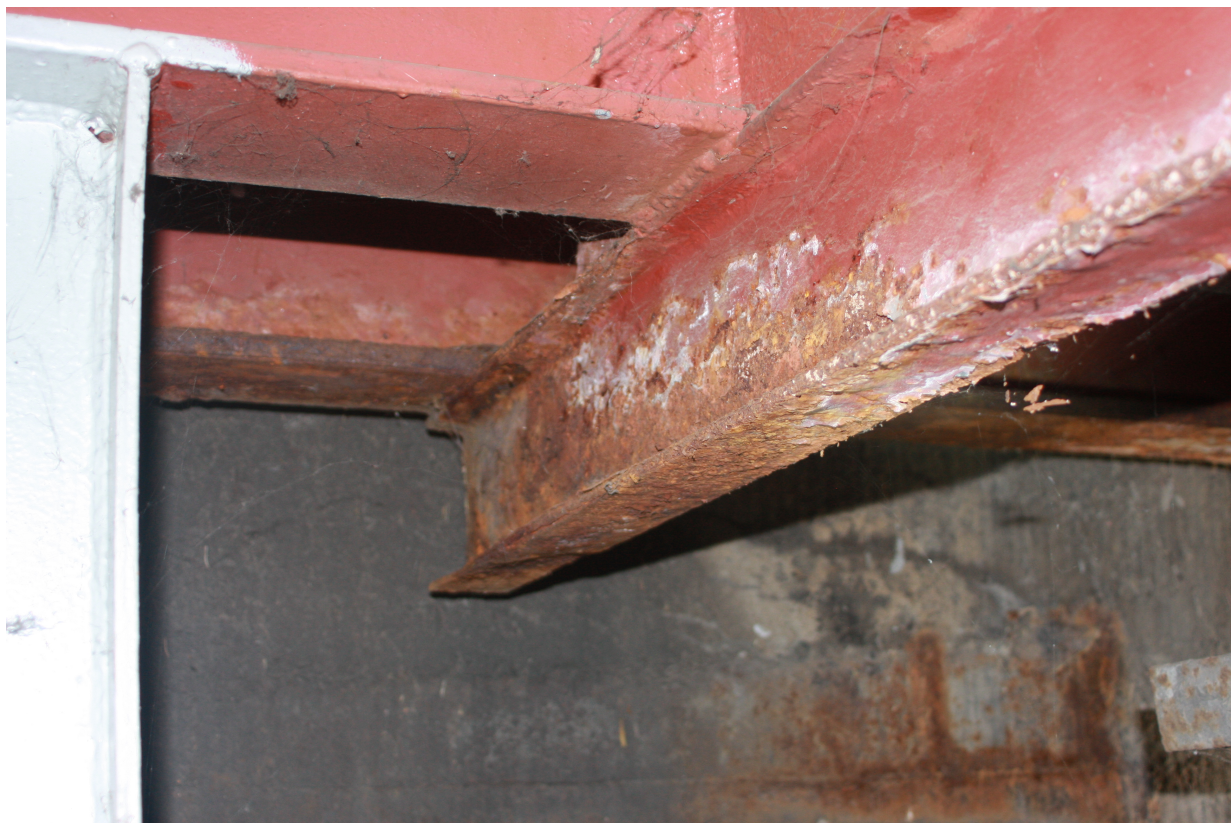
Fot. 60. Korozja poprzecznicy przy dylatacji.
