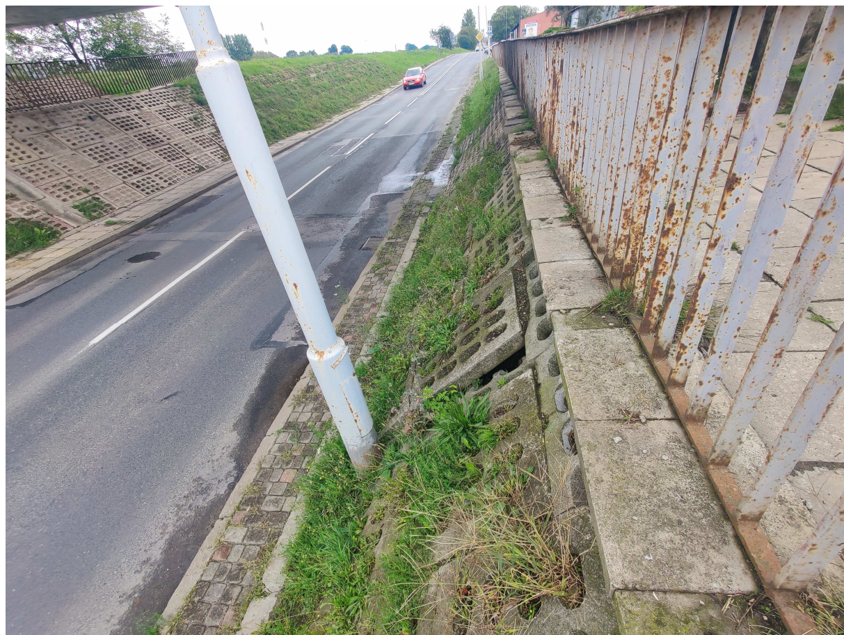
Fot. 68. Stan chodników w obrębie mostu
