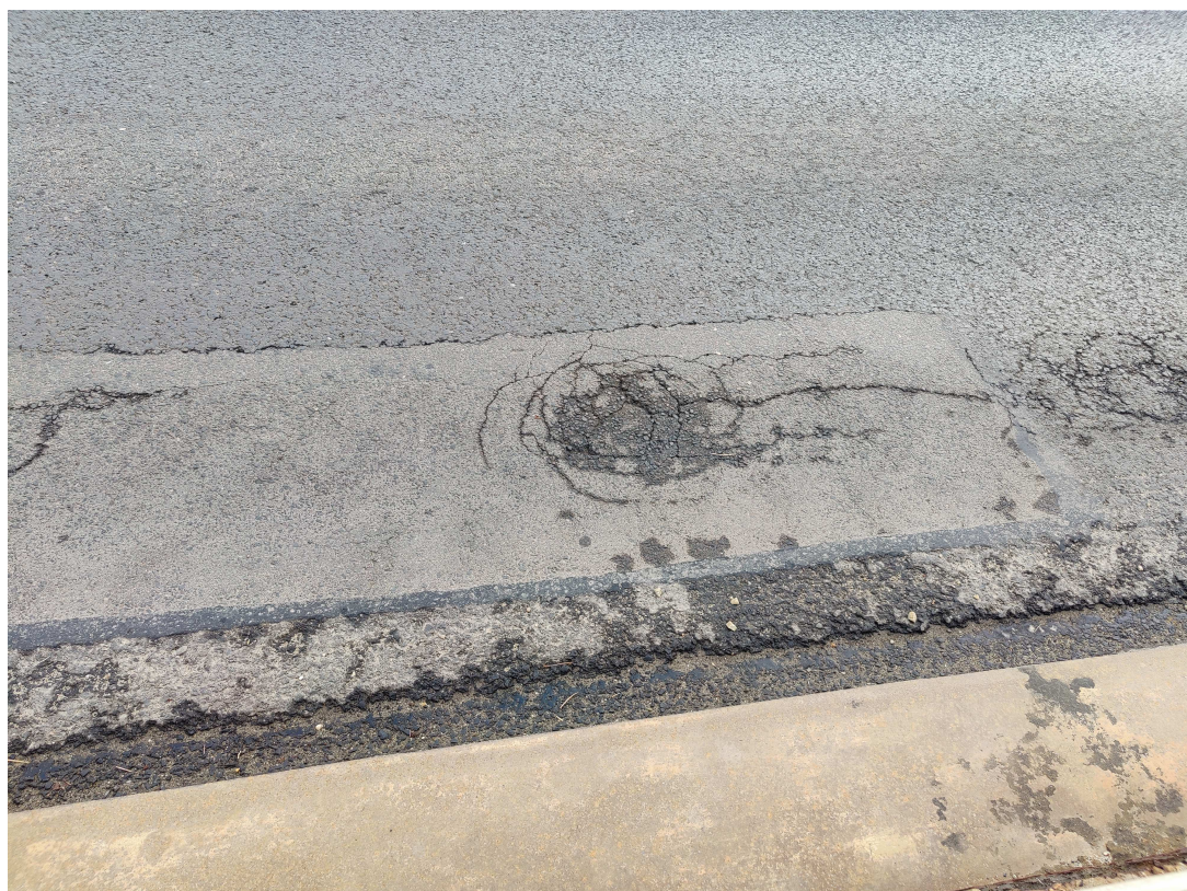
Fot. 22. Stan nawierzchni jezdni na moście
