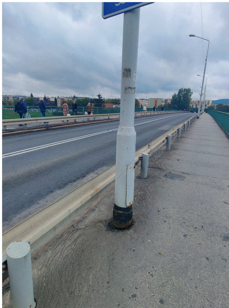
Fot. 17. Słup latarni oświetleniowej .
