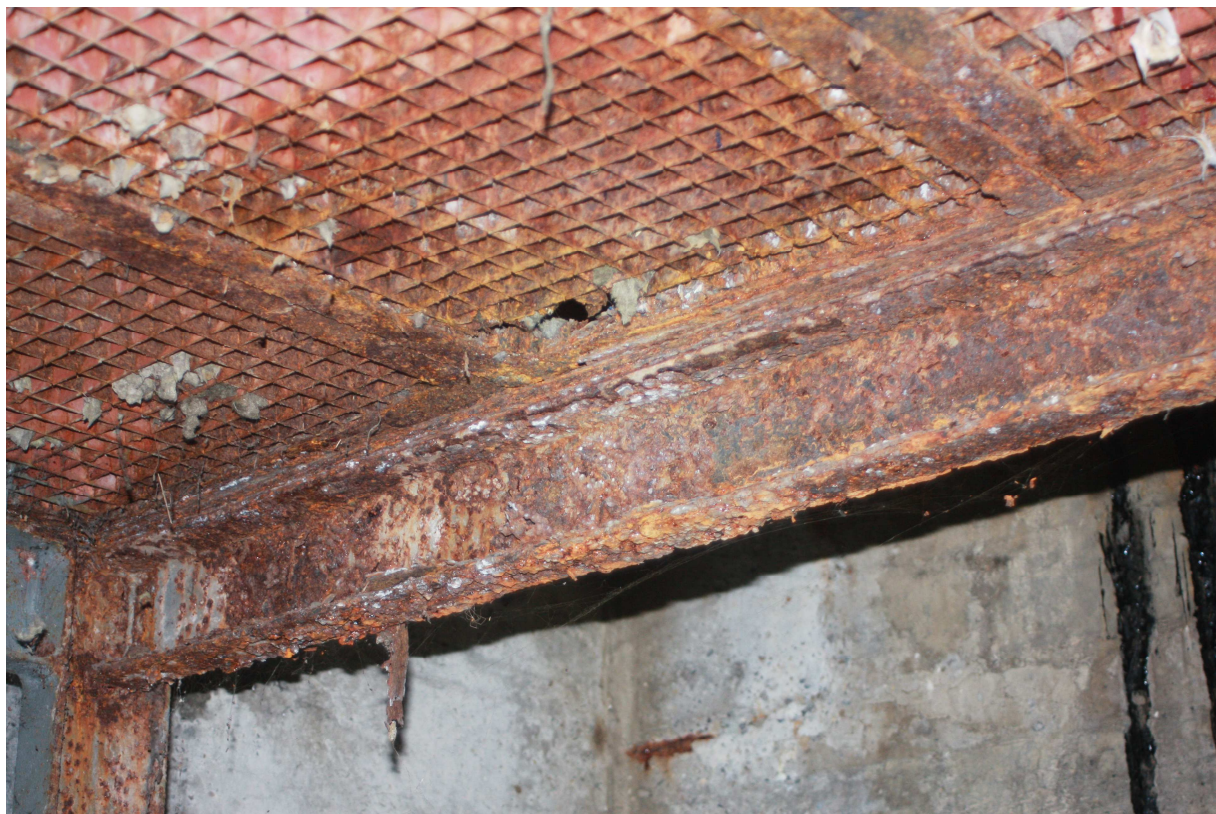
Fot. 57. Korozja elementów niekonstrukcyjnych – pomost pod urządzenia obce.
