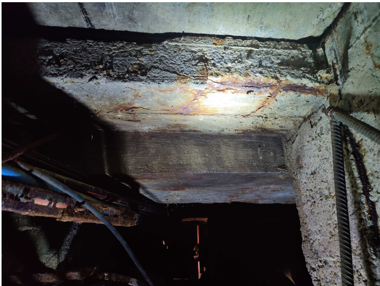
Fot. 52. Korozja betonu przyczółków – nieszczelna dylatacja.
