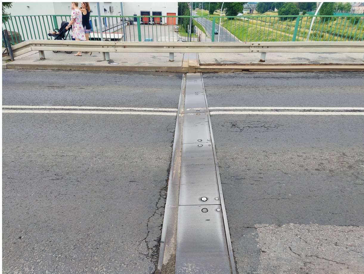
Fot. 13. Urządzenie dylatacyjne od strony ul. Bohaterów Getta .
