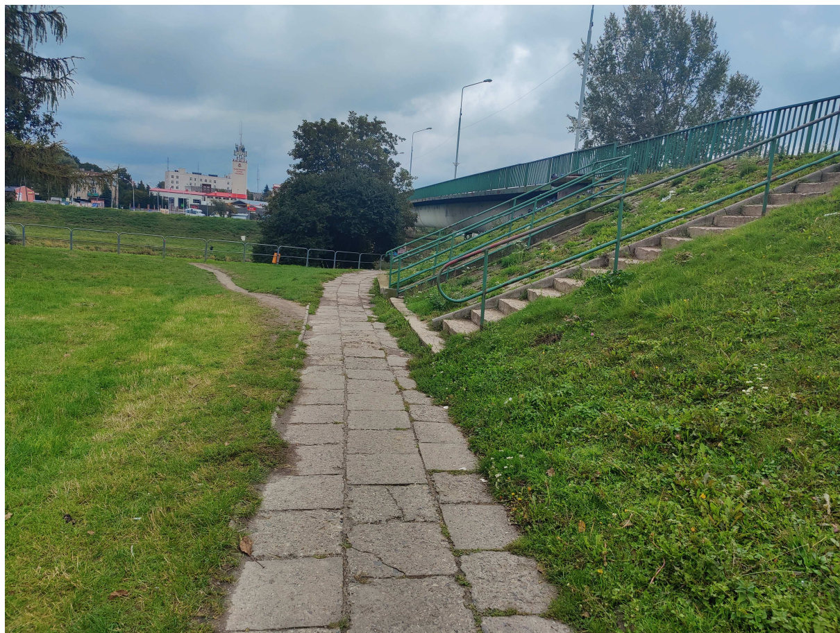
Fot. 65. Stan chodników w obrębie mostu
