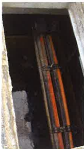
Rys. 36. Kanalizacja kablowa przechodząca przez studnię. Widoczne kable umieszczone na wspornikach zamocowanych do kolumn wsporczych
