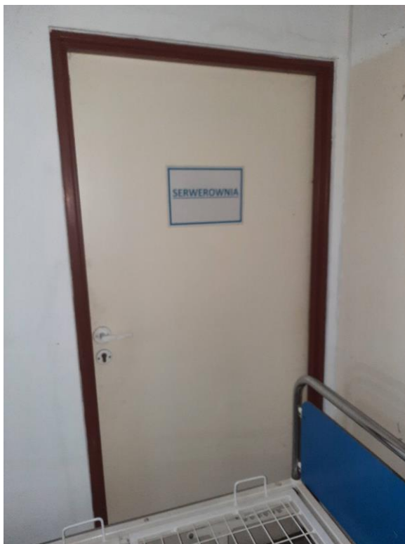
Istniejące drzwi do serwerowni podlegające wymianie
